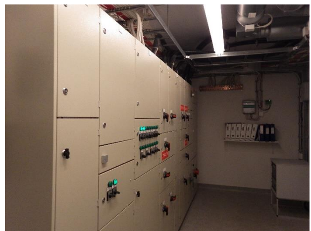
Laajennusosan nousukeskus NK-D001.
