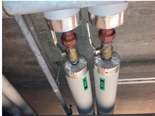
C- osan lämpöjohtojen sulkuventtiilit.
