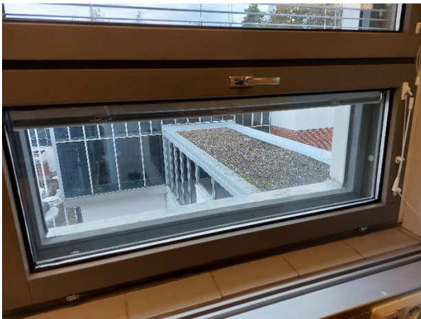
Tuuletusikkunoiden käynnissä havaittiin paikoin puutteita.
