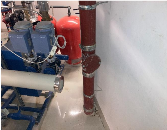
D- osan pystyviemäriä.
