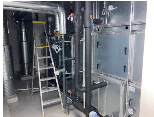
D- osan ilmanvaihtokone.
