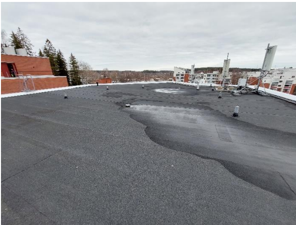
Katolla havaittiin vähäistä lammikoitumista.
