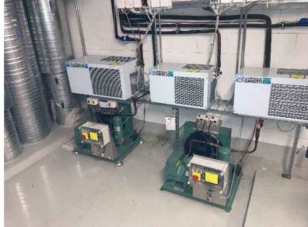
D- osan kylmäkoneiden koneistoa.
