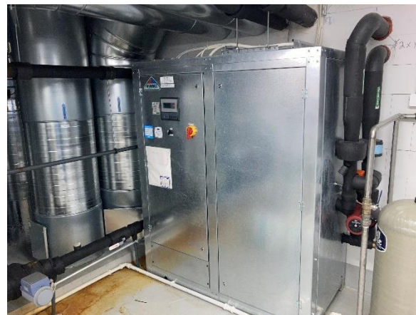
D- osan vedenjäähdytyskoneistoa.
