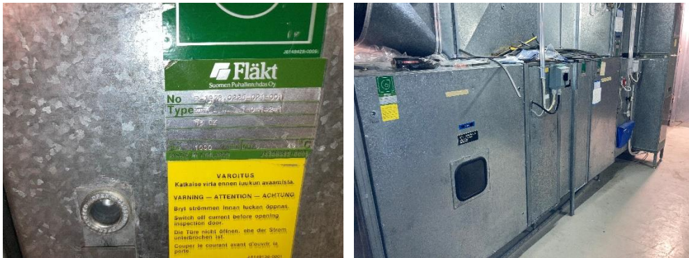
C- osan ilmanvaihtokoneen tyyppikilpi. C- osan TK13.
