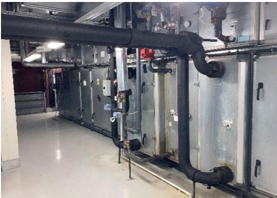
D- osan ilmanvaihtokone.
