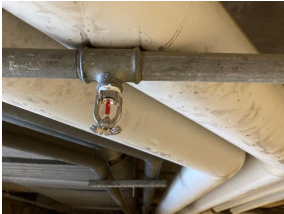
C- osan autohallin sprinkleriä.
