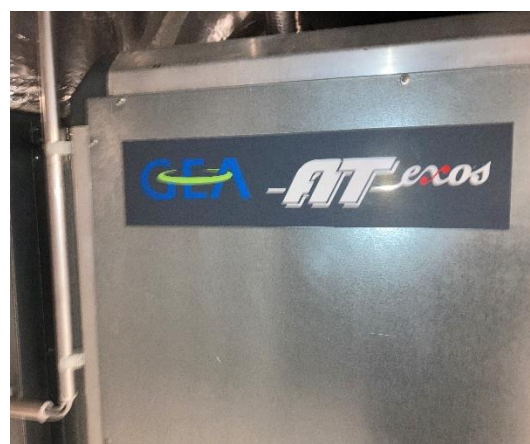
D- osan ilmanvaihtokone.
