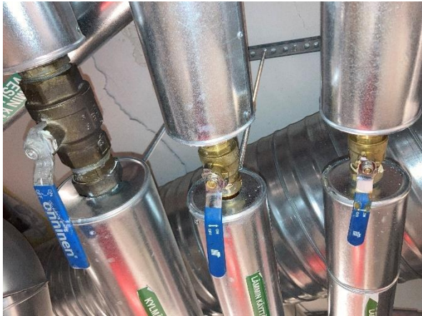
D- osan vesijohtoja ja sulkuventtiilit.
