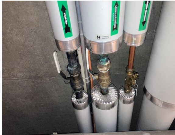
C- osan vesijohtoja ja säätöventtiili.
