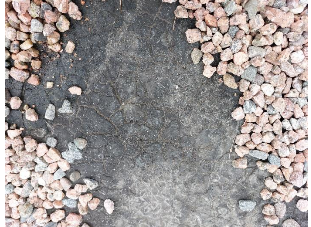
C-osan vesikatteen pinta on jo kulunut.
