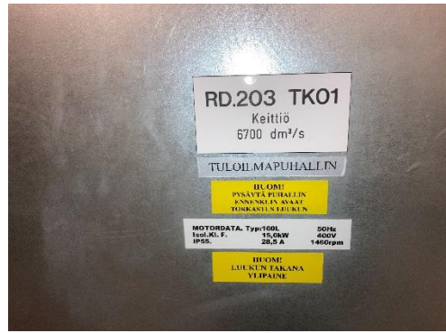
D- osan ilmanvaihtokone.
