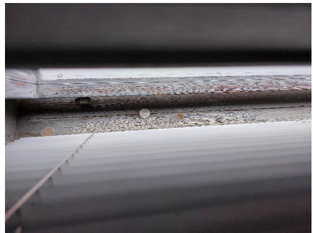
Ikkunoiden puuosien maalipinnat ovat kuluneita (C-osa).
