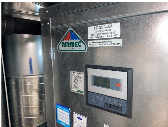
D- osan vedenjäähdytyskoneistoa.
