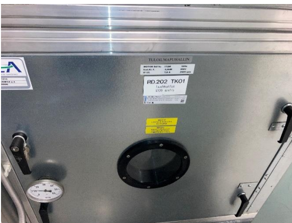
D- osan ilmanvaihtokone.
