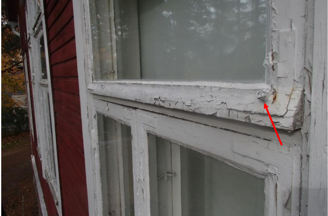
Kuva 48. Ikkunarakenteiden ulkopinnoilla havaittiin maalipintojen irtoilua, halkeilua ja hilseilyä sekä kulmarautojen kiinnitysnaulat ovat kulkeutuneet ulospäin.
