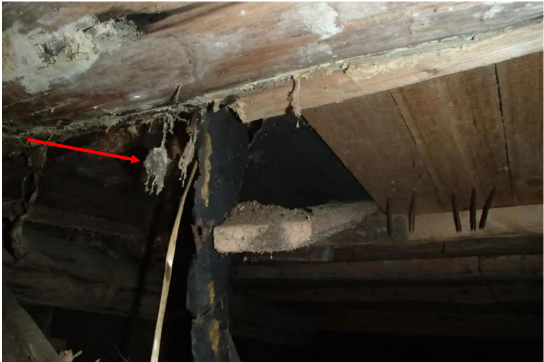
Kuva 91. Alapohjassa havaittiin avoimia läpivientejä ja vaurioita.
