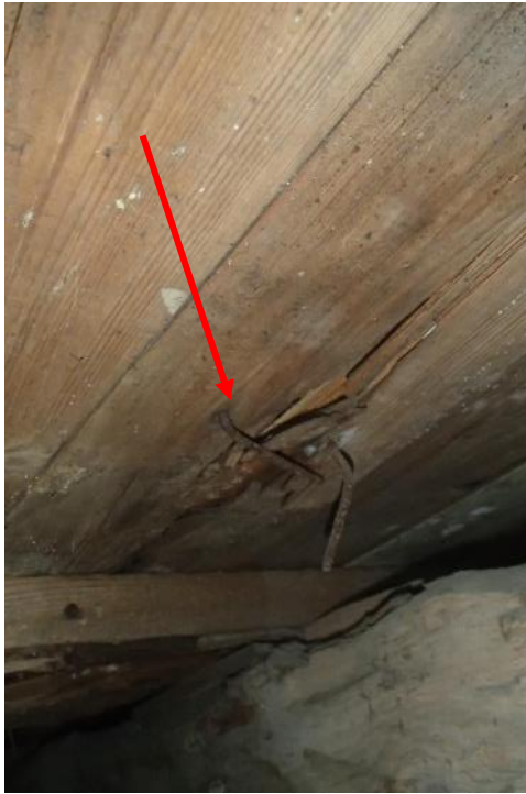
Kuva 105. Alapohjan alalaudoissa havaittiin lahovaurioita.
