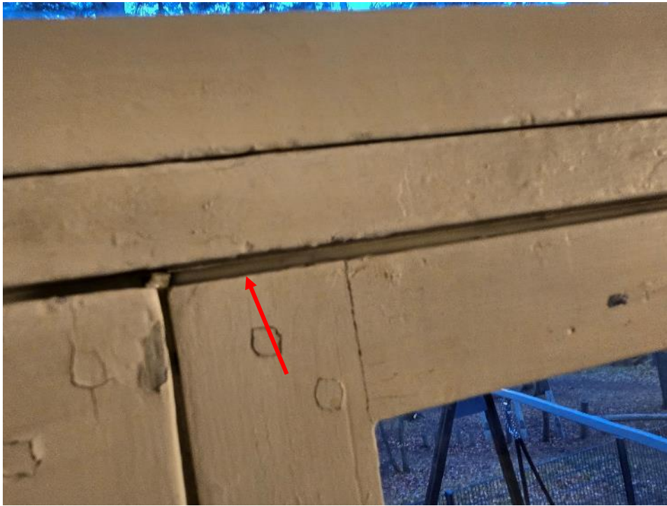
Kuva 63. Ikkunapokien ja karmien välillä havaittiin leveitä rakoja.
