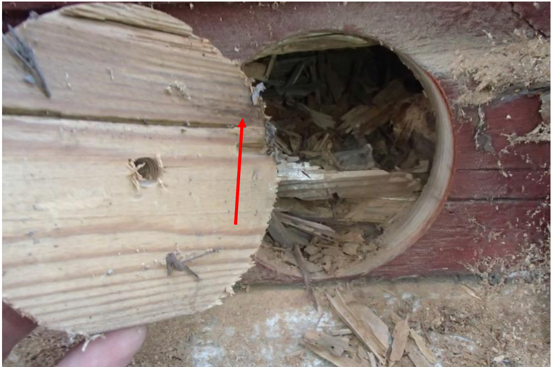
Kuva 15. Ulkoverhouspaneelien taustalla havaittiin mikrobikasvustoa ja hirsirungon alaosissa pitkälle edenneitä laho- ja hyönteisvaurioita.
