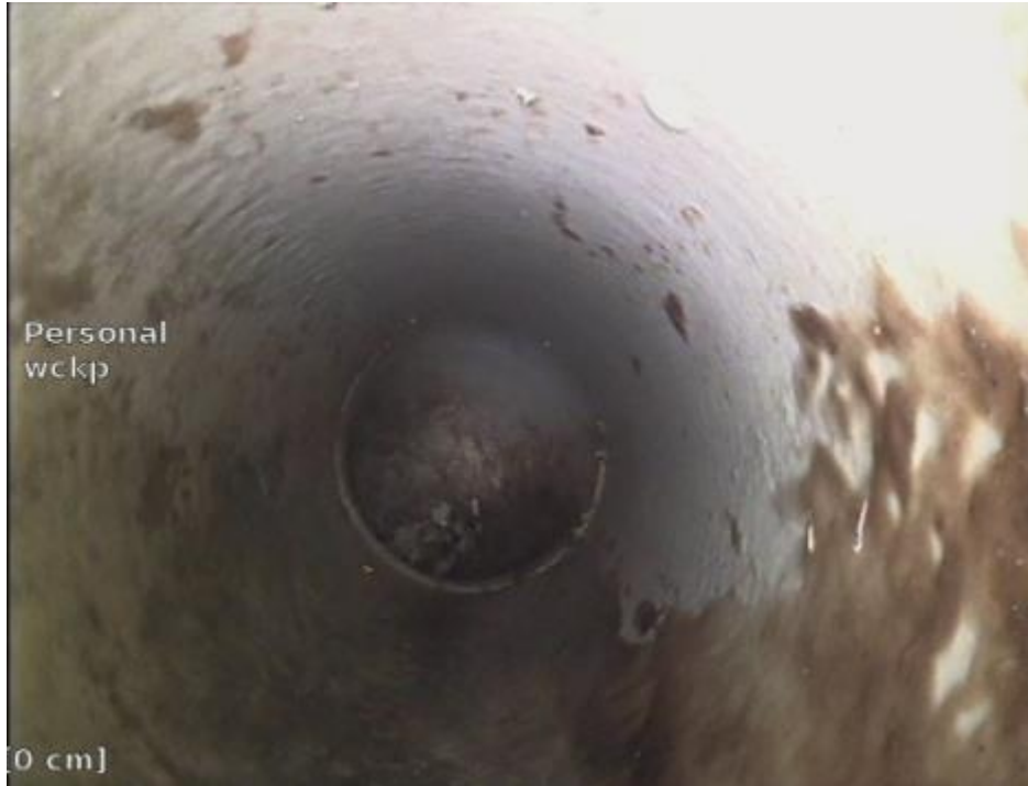
Kuva 139. Vessan pohjaviemäreissä havaittiin lieviä kaltevuuspoikkeamia. Kaltevuuspoikkeamia (5 %) havaittiin 4,9–5,5 metrin kohdalla sekä 12,2–13,1 metrin kohdalla. Muita poikkeamia linjastossa ei havaittu.
