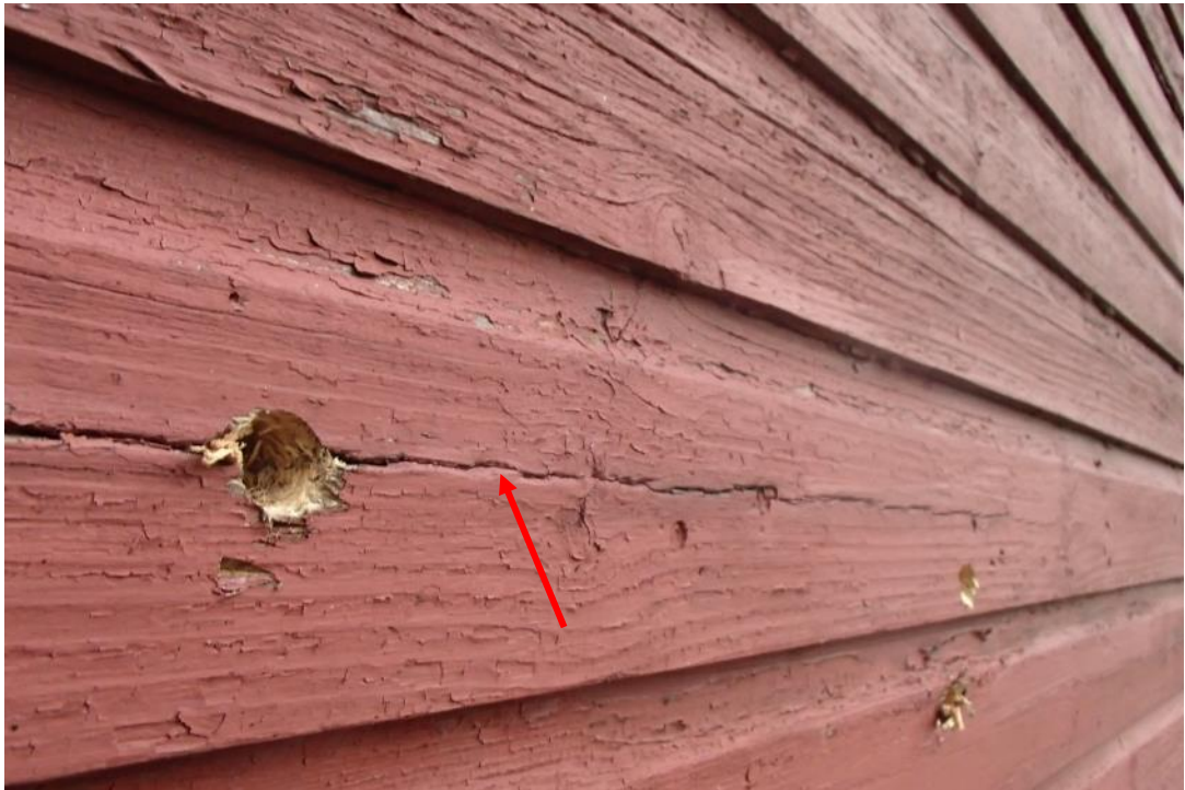
Kuva 21. Rakennuksen ulkoverhouspaneelissa havaittiin halkeilua, haristumista ja pinnoitteiden vaurioita.
