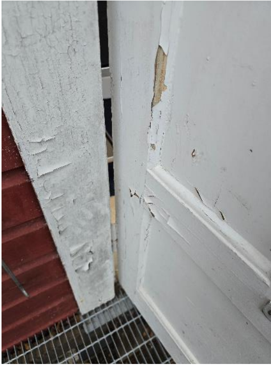
Kuva 79. Rakennuksen ovien maalipinnoilla havaittiin vaurioitumista.
