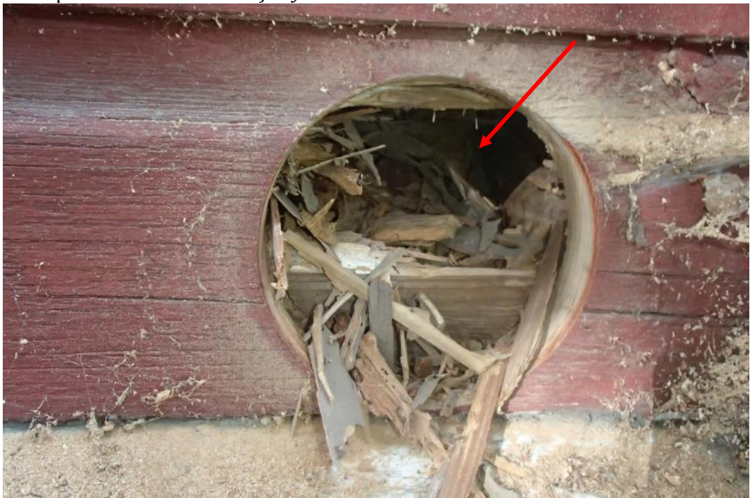
Kuva 16. Hirsirungon alaosissa havaittiin pitkälle edenneitä laho- ja hyönteisvaurioita.
