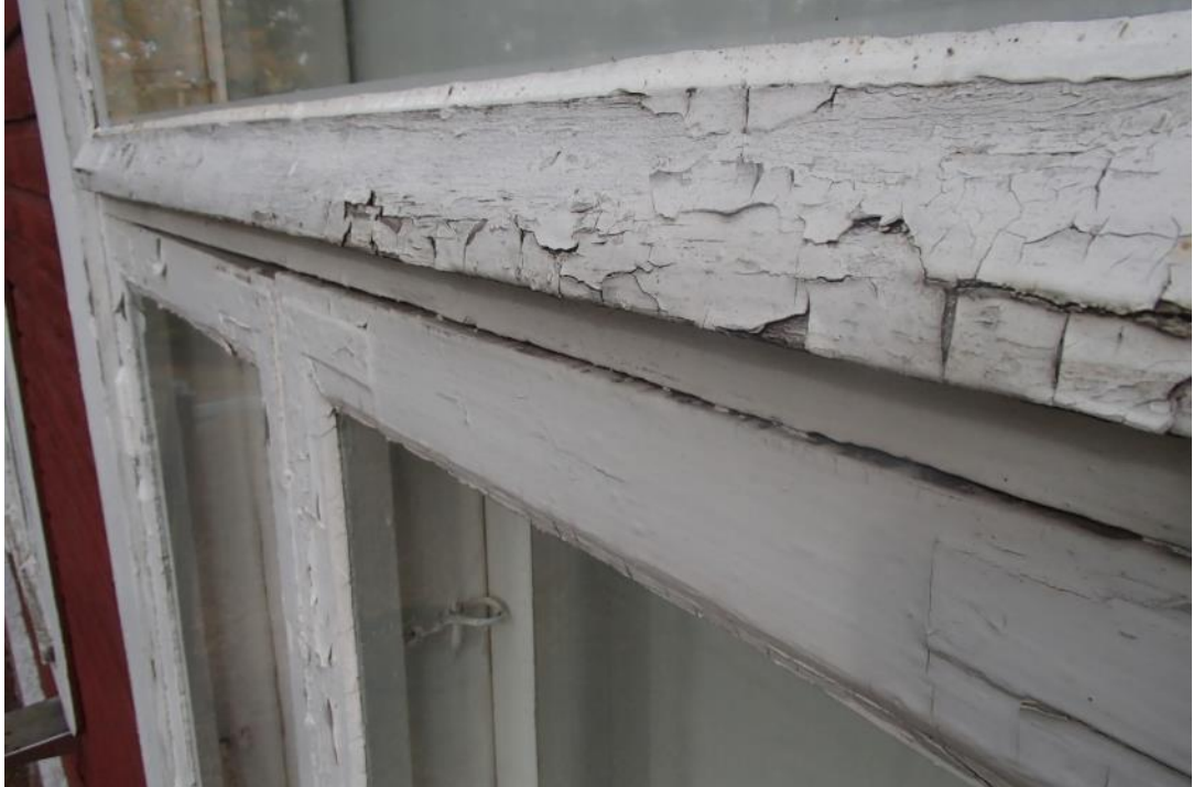
Kuva 50. Ikkunarakenteiden ulkopinnoilla havaittiin maalipintojen irtoilua, halkeilua ja hilseilyä.
