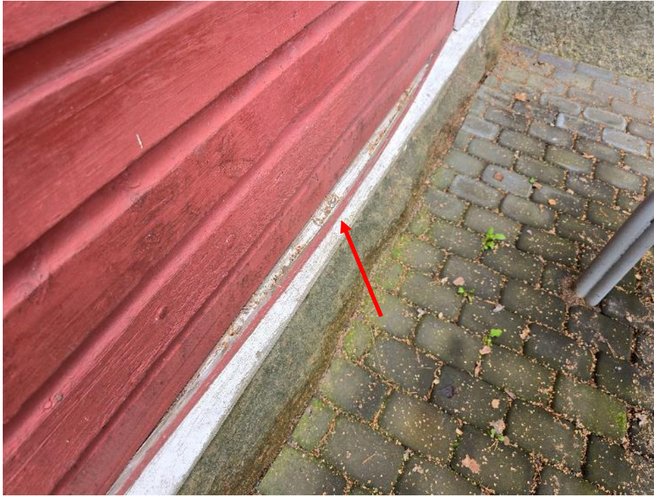
Kuva 29. Paikoin julkisivuista on irtoillut tippalautojen ja paneelien välisiä listoja.
