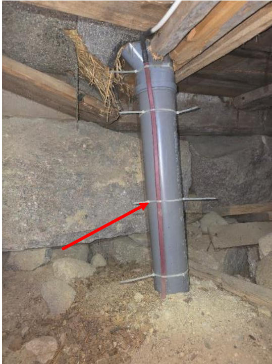
Kuva 109. Suurin osa viemäriputkista on eristämättömiä, mutta niissä on saattolämmitys.
