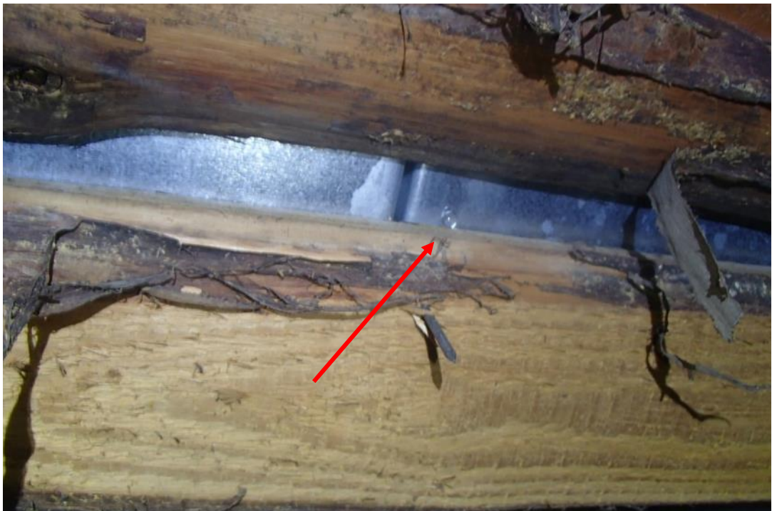
Kuva 124. Vesikatteen alapintaan kondensoituu kosteutta, joka imeytyy aluslautoihin.
