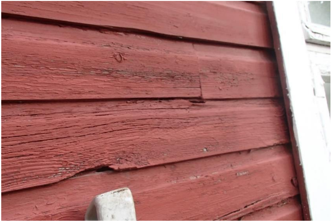
Kuva 23. Rakennuksen ulkoverhouspaneelissa havaittiin halkeilua, haristumista ja pinnoitteiden vaurioita.
