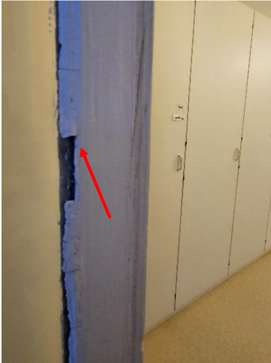
Kuva 69. Lasituskittausvaurioita havaittiin myös ikkunoiden välitilassa.
