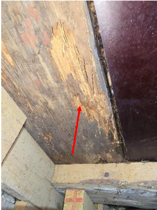
Kuva 102. Alapohjan runkokuissa havaittiin lahovaurioita.
