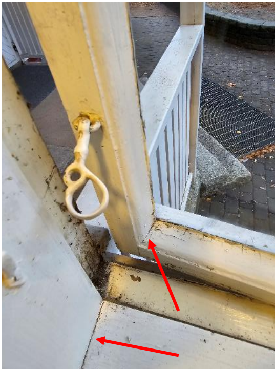
Kuva 62. Ikkunapokien ja karmien liitoskohdissa havaittiin halkeilua.
