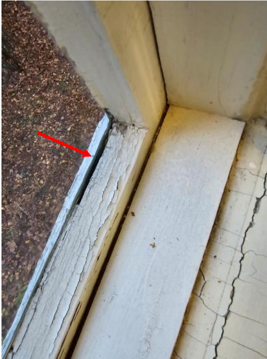
Kuva 57. Ikkunarakenteiden sisäpinnoilla havaittiin maalipintojen irtoilua, halkeilua ja hilseilyä sekä lasin ja pokaan välissä on rakoja.
