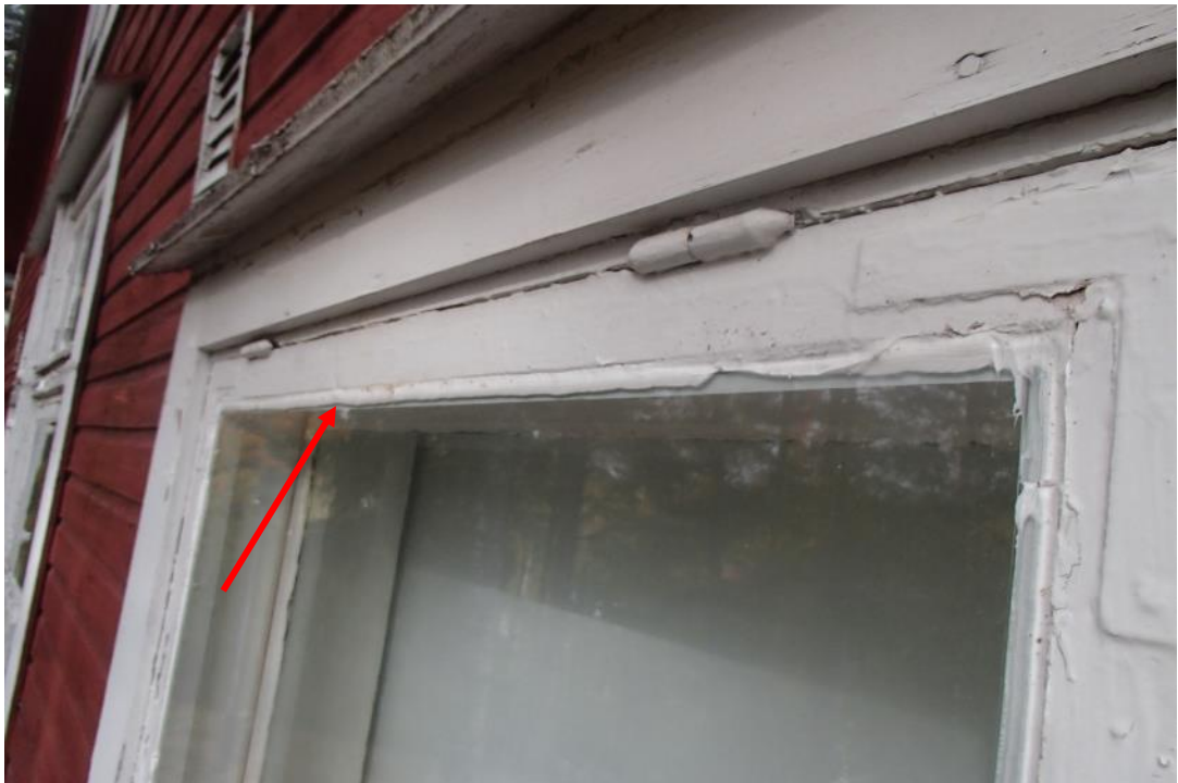
Kuva 66. Vaurioituneita lasituskittauksia on korjailtu liimamassalla.
