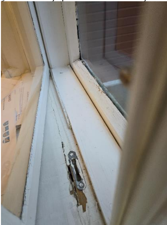
Kuva 58. Ikkunarakenteiden sisäpinnoilla havaittiin maalipintojen irtoilua, halkeilua ja hilseilyä.
