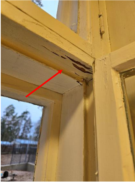
Kuva 51. Ikkunarakenteiden sisäpinnoilla havaittiin maalipintojen irtoilua, halkeilua ja hilseilyä.
