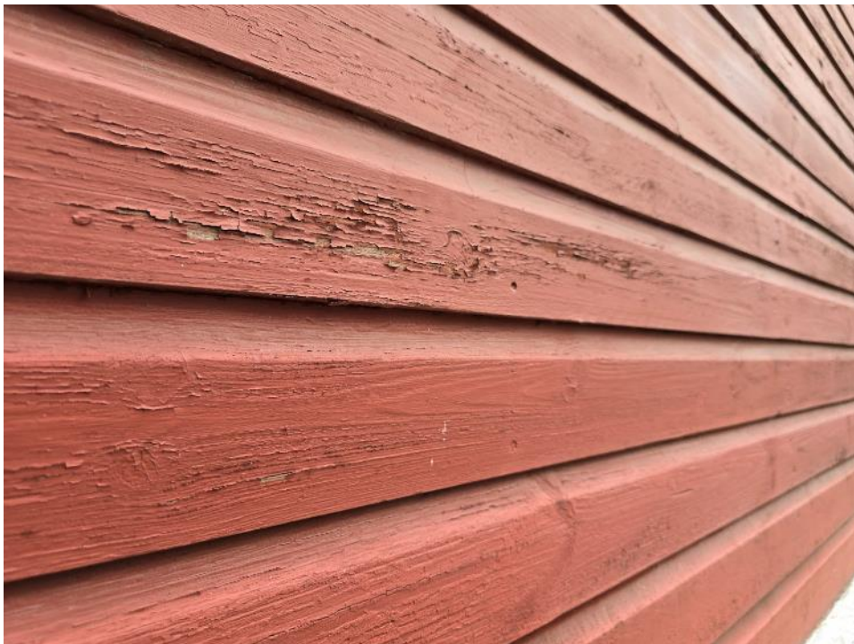
Kuva 20. Rakennuksen ulkoverhouspaneelien maalipinnoilla havaittiin pinnoitteiden irtoilua, haalistumista ja hilseilyä erityisesti rakennuksen eteläsivulla.
