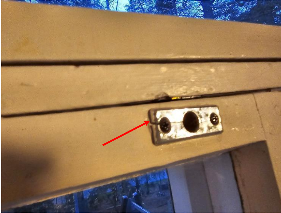
Kuva 75. Ikkunoiden heloituksia on rikkoutunut.
