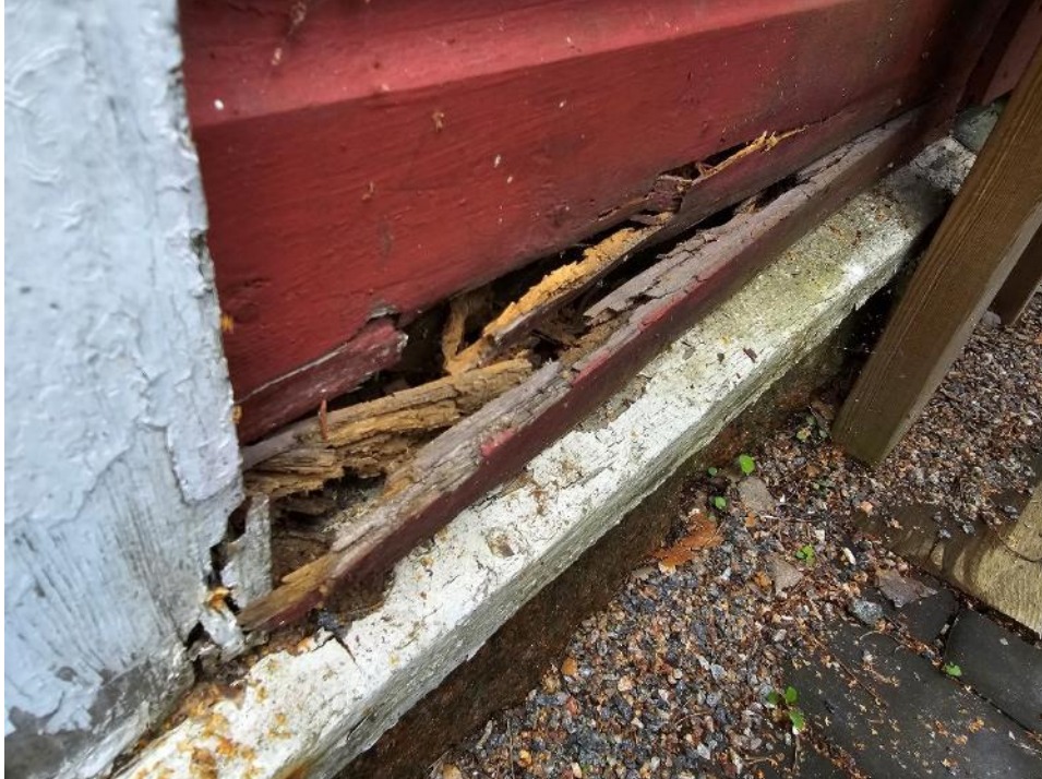
Kuva 10. Ulkoverhouksen alaosissa havaittiin maali- ja lahovaurioita.
