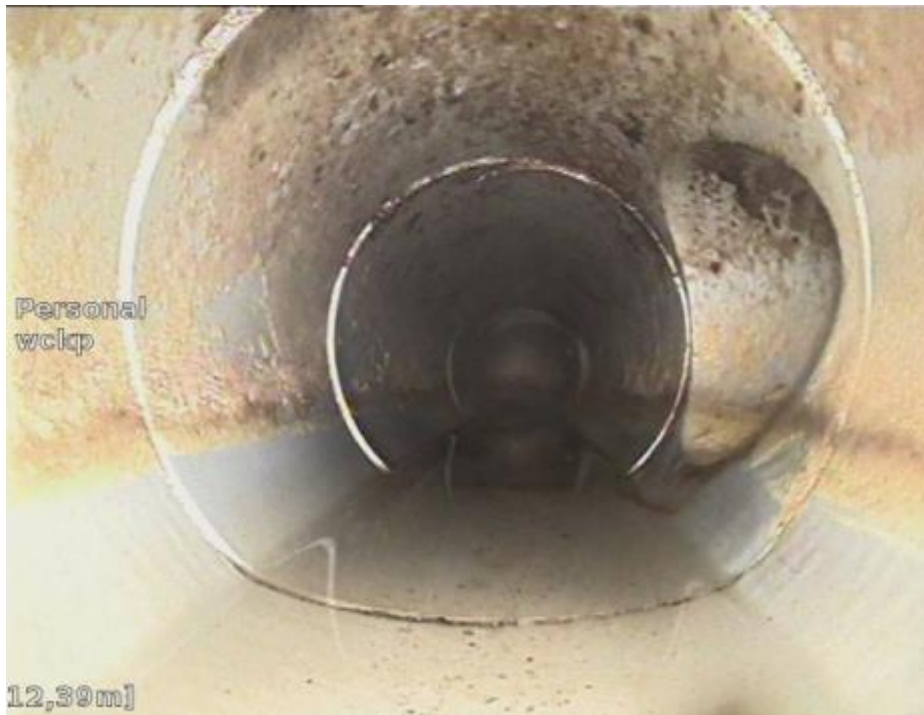
Kuva 141. Lievä kaltevuuspoikkeama 12,39 metrin kohdalla.
