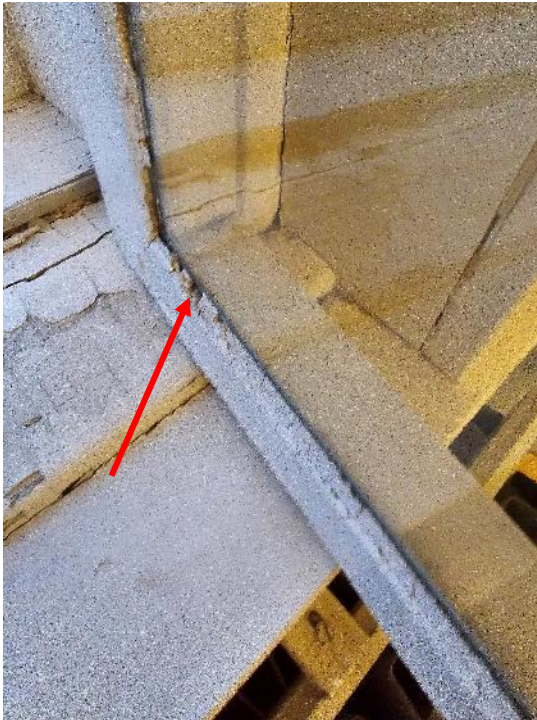
Kuva 68. Lasituskittausvaurioita havaittiin myös ikkunoiden välitilassa.
