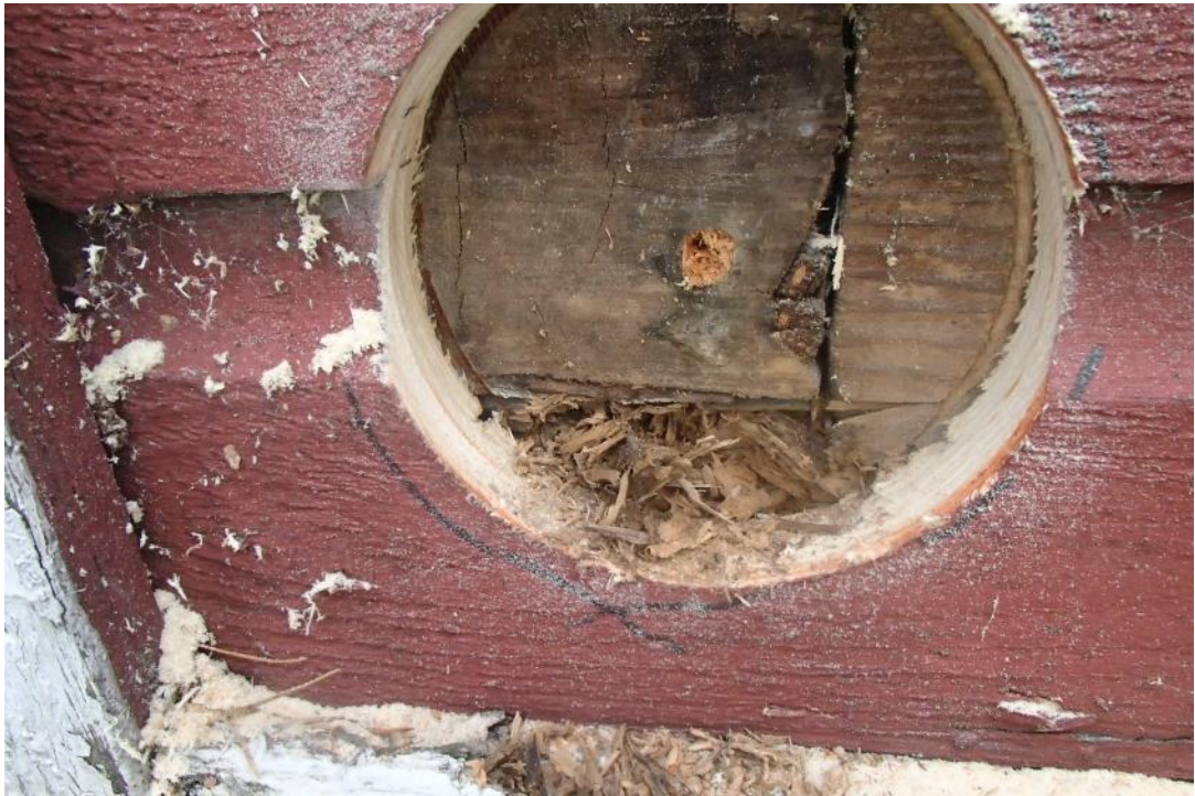
Kuva 31. Rakennuksen takaosassa ei havaittu tuulensuojaa paneelien taustalla eikä tuuletusväliä.
