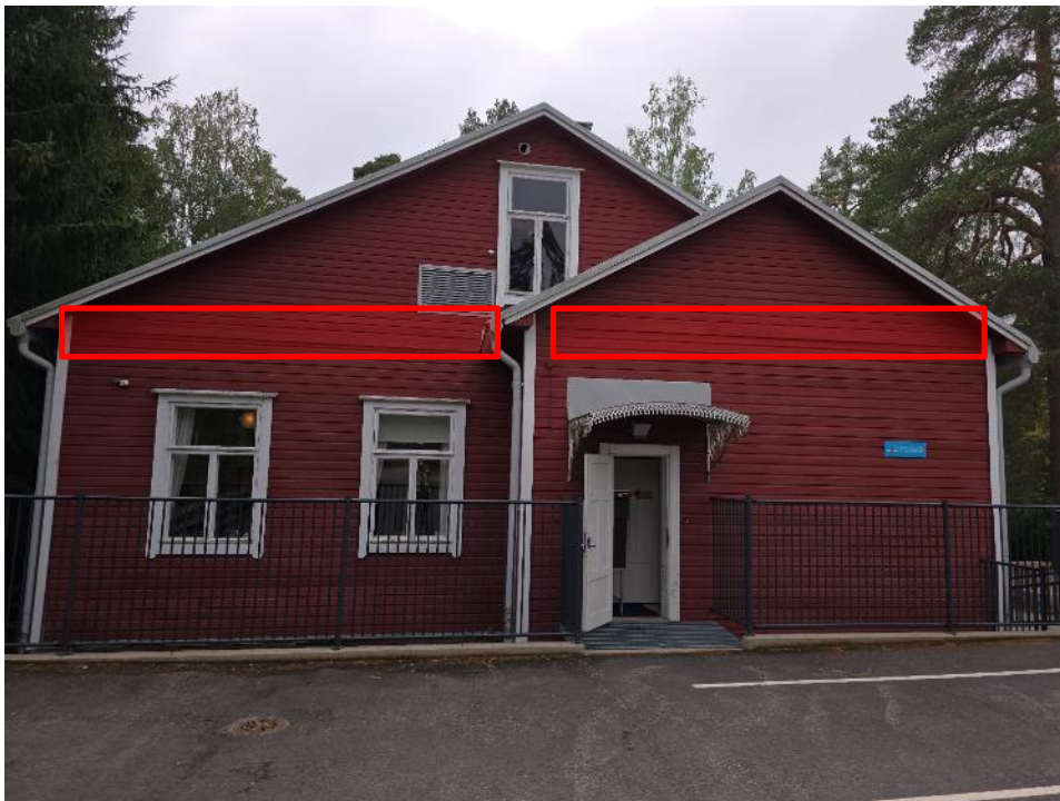
Kuva 18. Ulkoverhouspaneelissa havaittiin pullistumista yläpohjan alueella.
