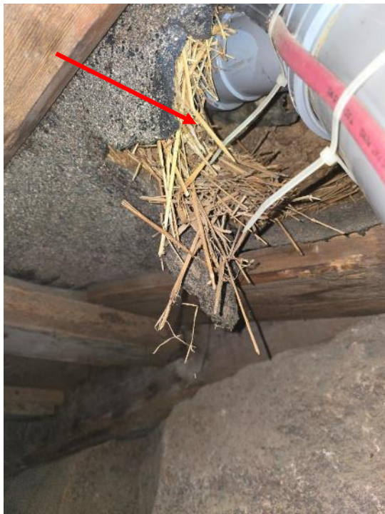
Kuva 90. Alapohjassa havaittiin avoimia läpivientejä.
