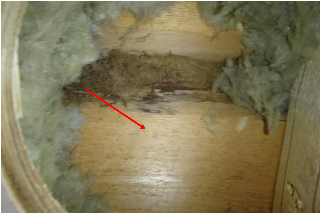
Kuva 35. Sisäpuolen hirsipinnoilla havaittiin viitteitä kosteusrasituksesta, mutta jäljet voi olla vanhoja tai rakennusaikaisia.
