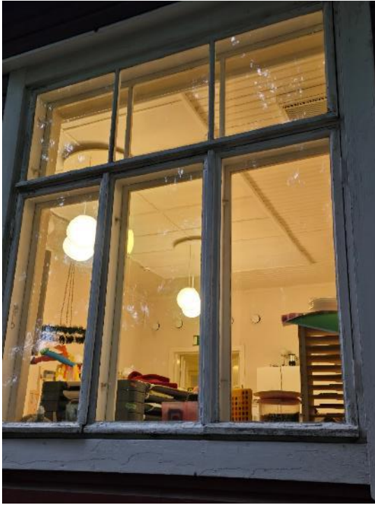
Kuva 43. Ikkunarakenteiden ulkopintojen maalipinnat ovat heikossa kunnossa.
