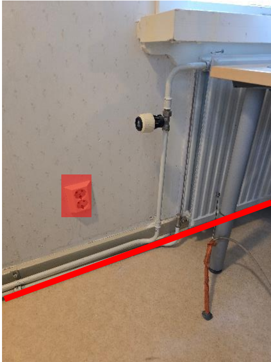
Kuva 163. Johtajan huoneessa havaittiin ilmavuotoa lattioidenraajapinnoilta ja pistorasian kautta.
