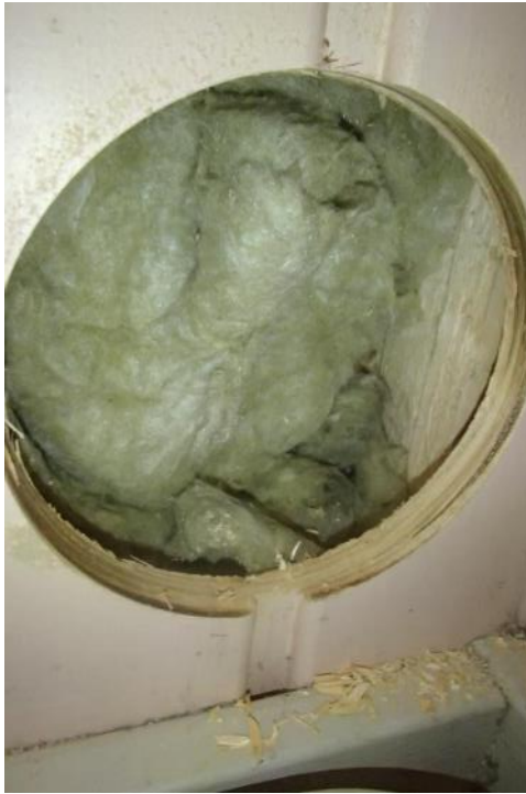
Kuva 33. Sisäpuolen pystypanelointien taustalla ei ole ilmasulkupaperia eikä höyrysulkumuovia.
