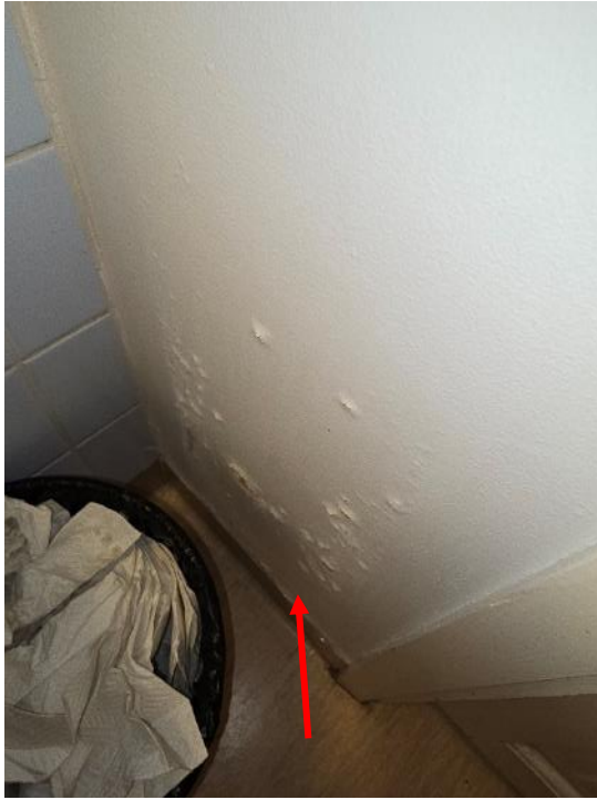
Kuva 155. Paikoin sisätilojen lastulevyt ovat turpoilleet.
