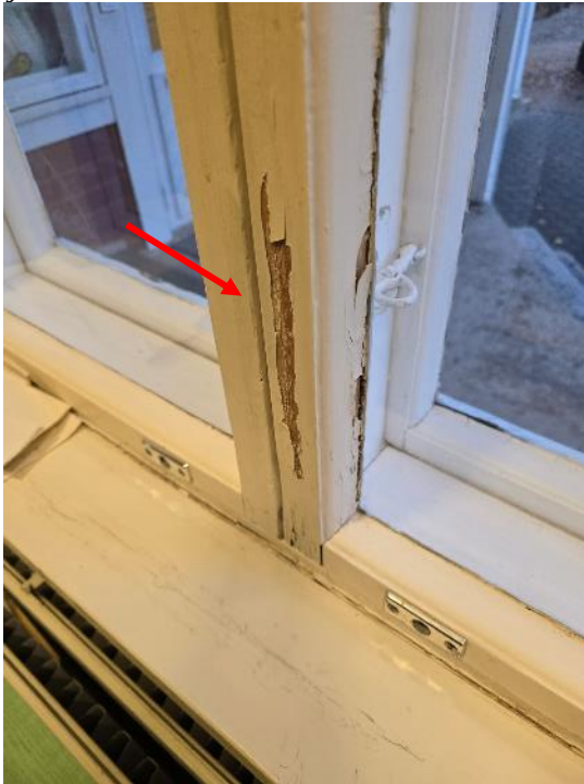
Kuva 52. Ikkunarakenteiden sisäpinnoilla havaittiin maalipintojen irtoilua, halkeilua ja hilseilyä.
