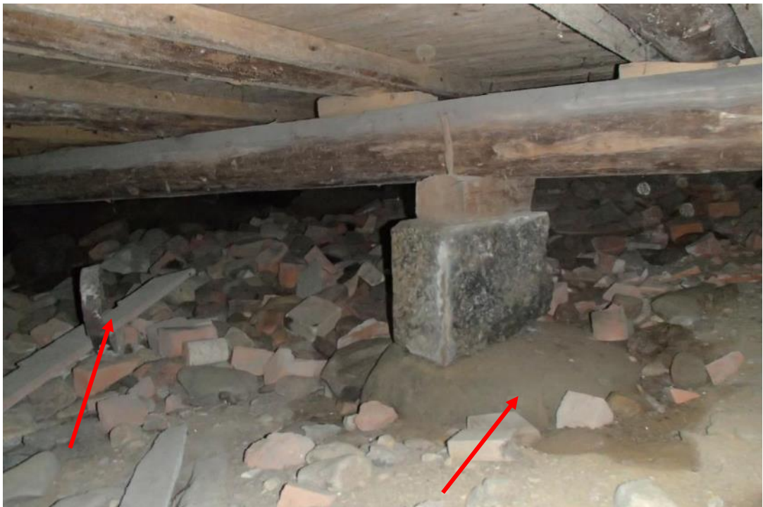
Kuva 98. Ryömintätilassa havaittiin ylimääräistä jätettä ja puumateriaalia sekä alapohjan maa-ainekset kaatavat keskialuetta kohden.
