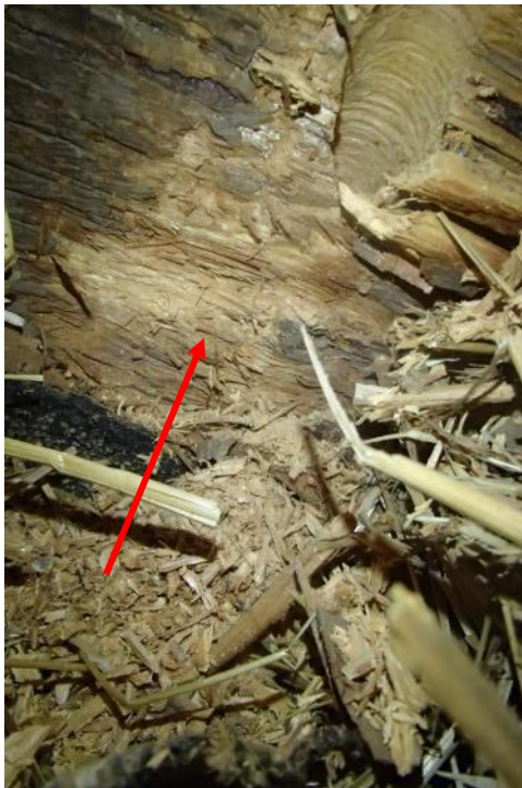
Kuva 89. Paikoin alapohjan eristetilan runkopiissa havaittiin lahovaurioita.
