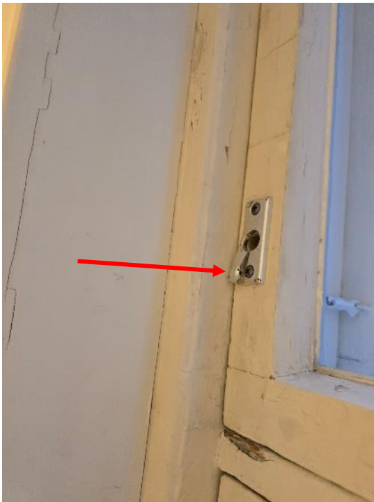
Kuva 74. Ikkunoiden heloituksia on rikkoutunut.
