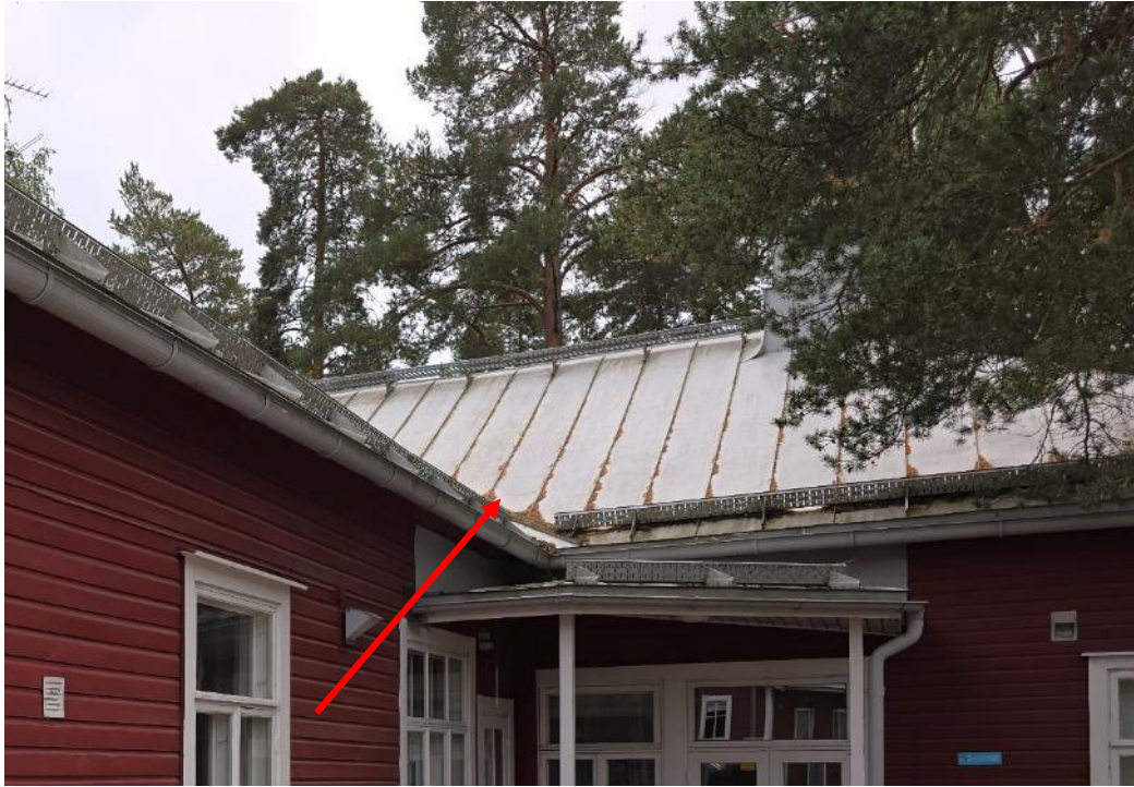
Kuva 121. Rakennuksen vesikatolla havaittiin ylimääräistä roskaa ja likaa sekä maalipinnat ovat hieman haalistuneet UV-säteilyn vaikutuksesta.
