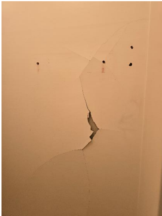
Kuva 154. Paikoin palomuurien laastikerroksissa havaittiin vaurioita.
