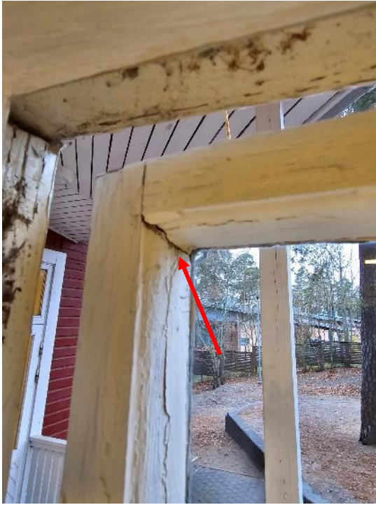
Kuva 61. Pokien ja karmien liitoskohdissa havaittiin halkeilua.
