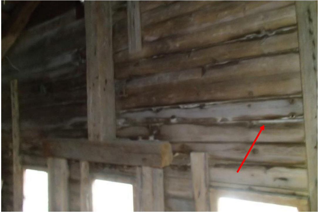
Kuva 129. Päätykolmion laudoituksen taustapinoilla on havaittavissa vanhoja kosteusjälkiä.
