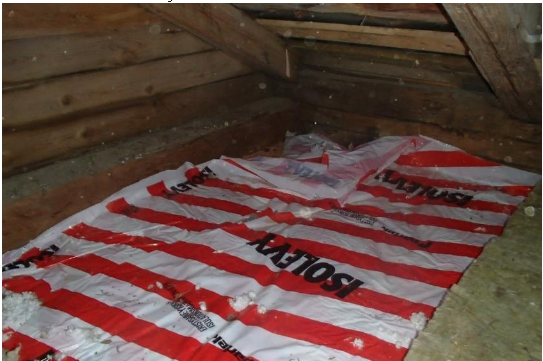
Kuva 128. Lisälämmöneristeen alapuolelle on levitetty pakkausmuoveja, joiden pintoihin kondensoituu kosteutta tietyissä olosuhteissa.
