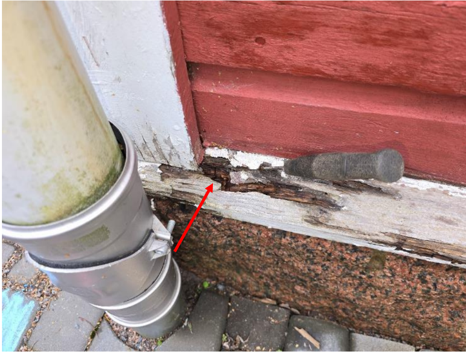
Kuva 9. Ulkoverhouksen alaosan tippalaudoissa havaittiin maali- ja lahovaurioita.
