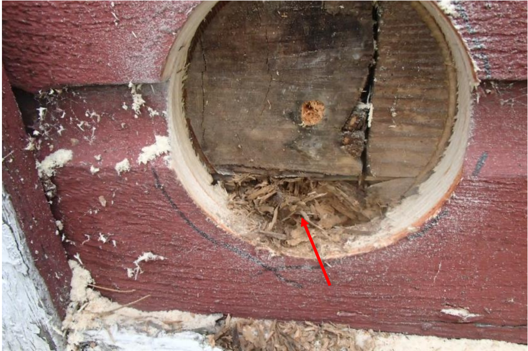
Kuva 17. Hirsirungon alaosissa havaittiin laho- ja hyönteisvaurioita.
