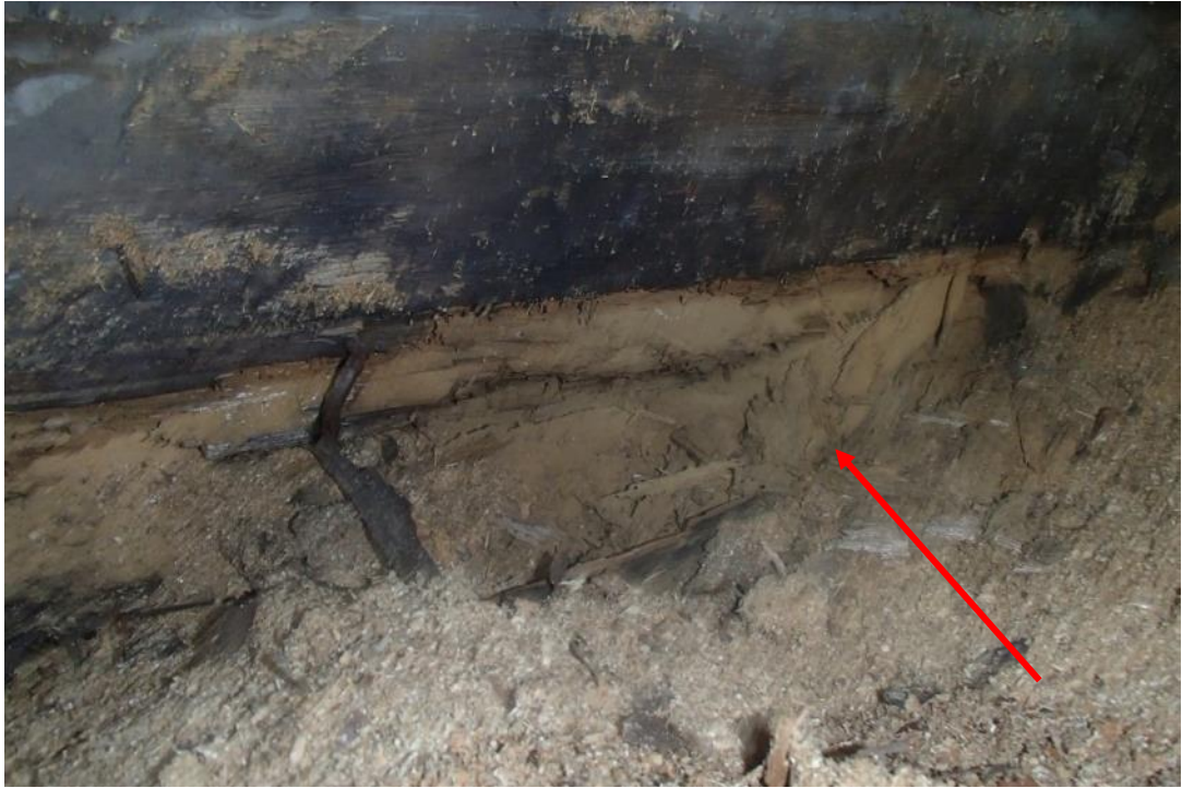
Kuva 125. Paikoin ulkovaipan hirsirungossa havaittiin lahovaurioita alkuperäisen eristeen ja lisälämmöneristeen rajapinnoilla.
