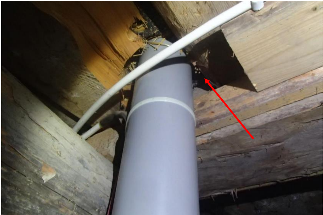
Kuva 93. Alapohjassa havaittiin avoimia läpivientejä.
