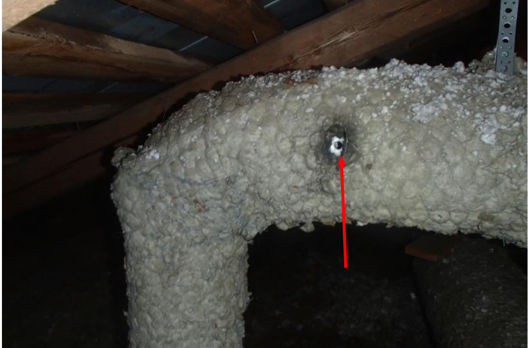
Kuva 134. Yhden IV-putken osalta havaittiin reikä.
