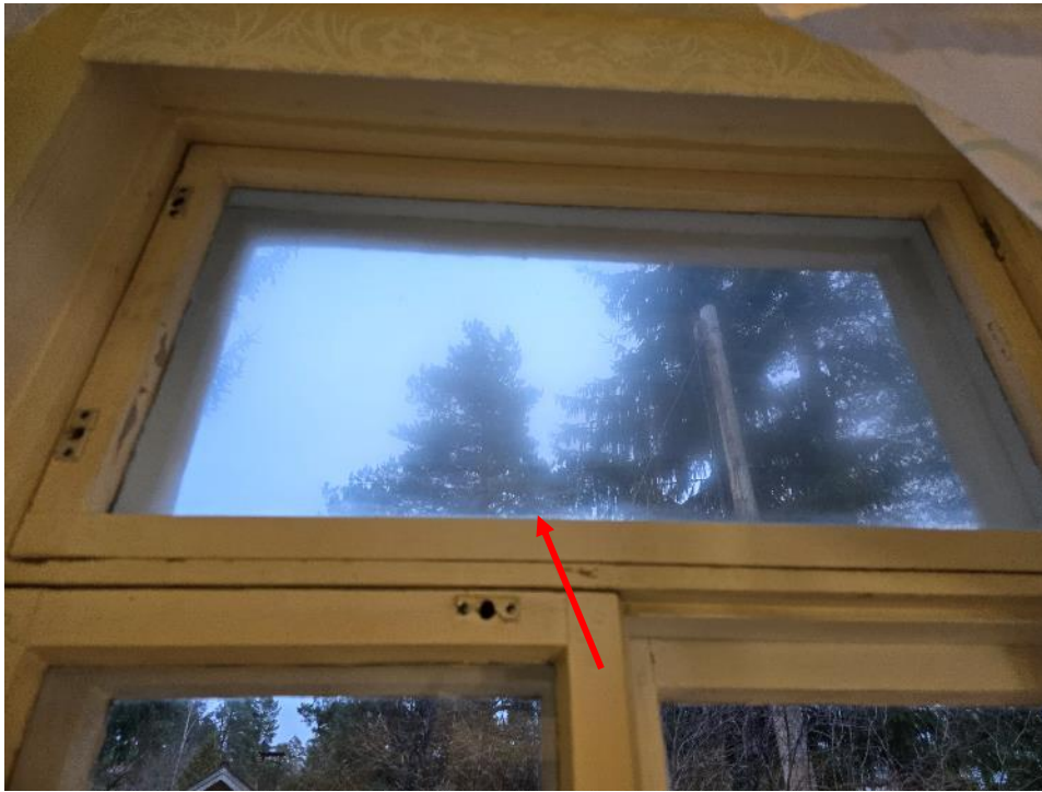
Kuva 77. Paikoin ikkunoiden välitilaan kondensoituu kosteutta puutteellisen tuuletuksen seurauksena.
