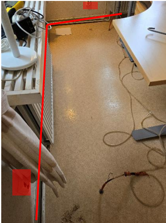
Kuva 161. Johtajan huoneessa havaittiin ilmavuotoa lattioiden rajapinnoilta ja pistorasia kautta.
