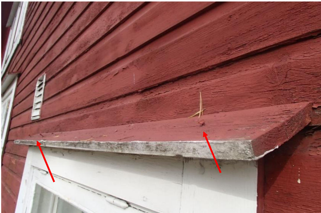
Kuva 28. Ikkunoiden yläosien tippalautojen naulat irtoilevat naulan suuntaisesti.
