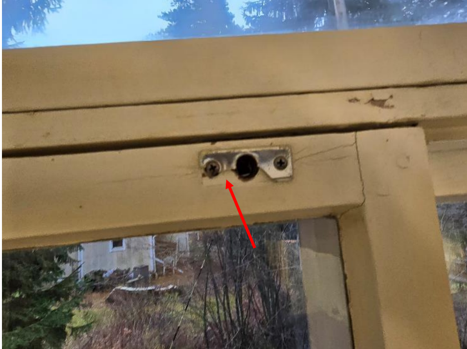
Kuva 76. Ikkunoiden heloituksia on rikkoutunut.
