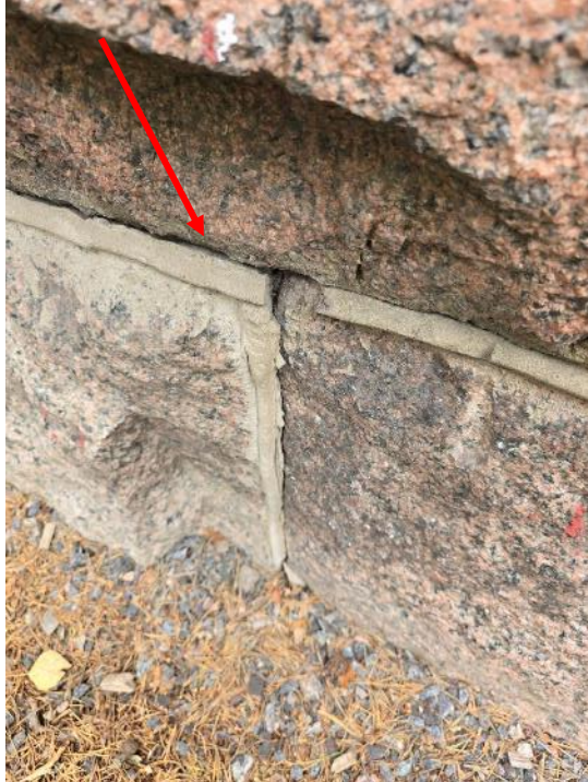
Kuva 40. Sokkelin laastisaumoissa havaittiin irtoilua ja halkeilua.
