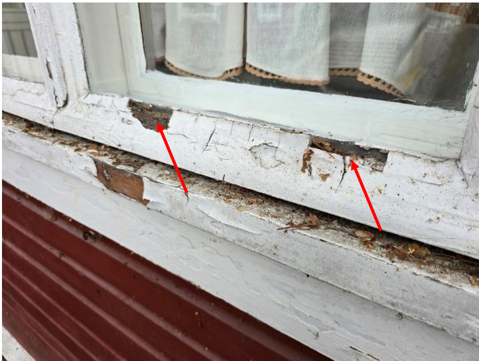
Kuva 64. Ikkunoiden lasituskittaukset ovat irtoilleet ja halkeilleet.
