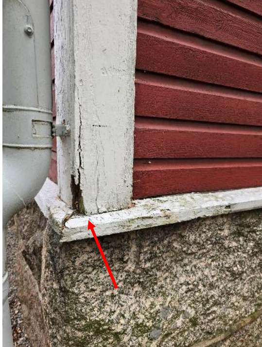
Kuva 24. Rakennuksen kulmalaudoissa havaittiin pinnoitevaurioita ja lahovaurioita.
