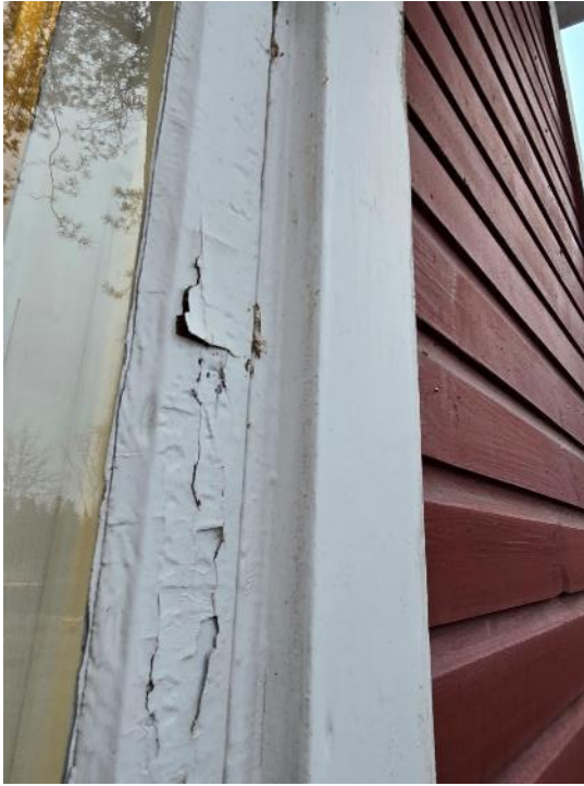
Kuva 45. Ikkunarakenteiden ulkopinnoilla havaittiin maalipintojen irtoilua, halkeilua ja hilseilyä.
