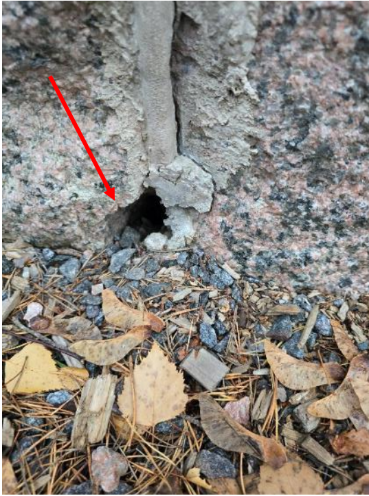
Kuva 41. Sokkelin alaosissa havaittiin reikiä rakenteisiin.
