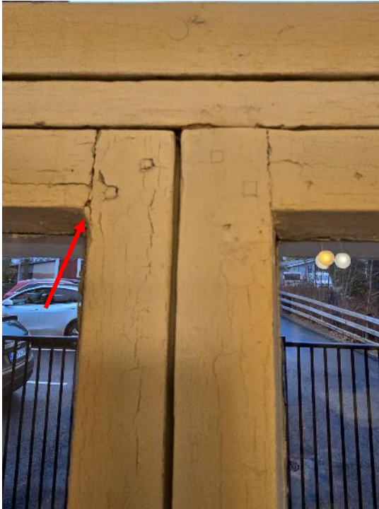
Kuva 55. Ikkunarakenteiden sisäpinnoilla havaittiin maalipintojen irtoilua, halkeilua ja hilseilyä sekä pokien liitoskohdissa havaittiin paikoin halkeilua.
