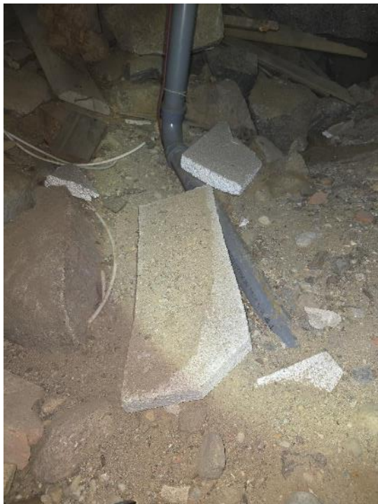
Kuva 96. Ryömintätilassa havaittiin ylimääräistä jätettä ja puumateriaalia sekä viemäriputkia ei ole eristetty, mutta muoviputkissa on saattolämmitykset.
