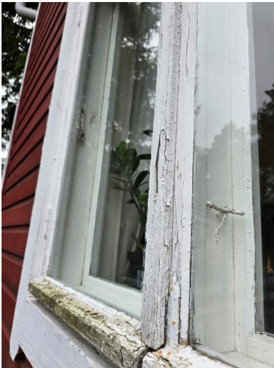
Kuva 44. Ikkunarakenteiden ulkopinnoilla havaittiin maalipintojen irtoilua, halkeilua ja hilselyä sekä ikkunapokien alaosissa kasvaa kosteutta sitovaa kasvillisuutta.
