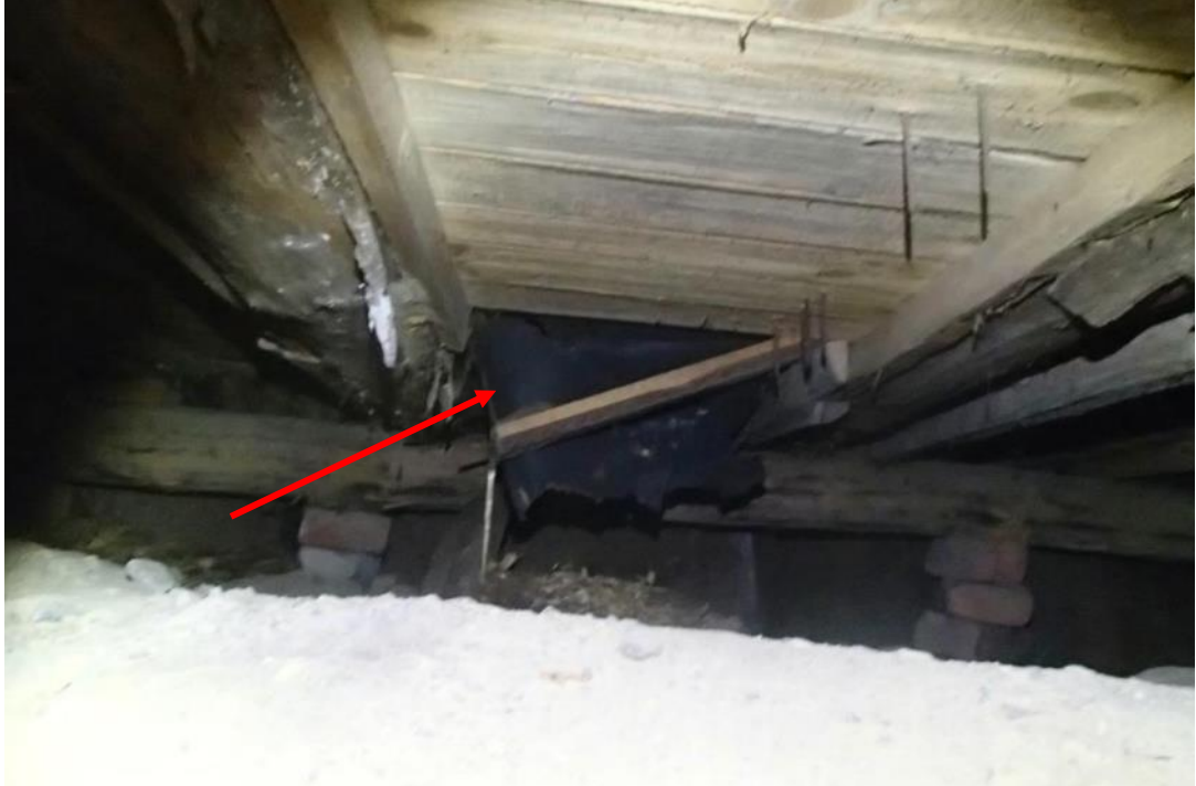
Kuva 106. Paikoin alalaudoitukset ovat romahtaneet.
