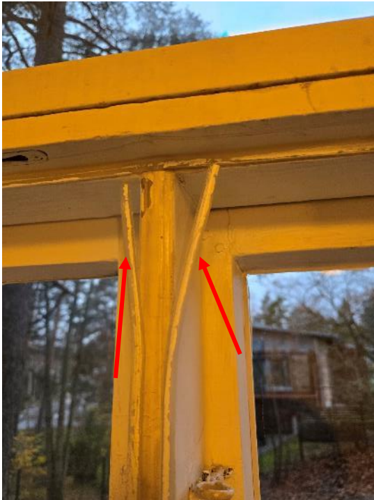
Kuva 72. Ikkunoita on lisätiivistetty, mutta tiivisteitä on irtoillut kiinnityksestään.
