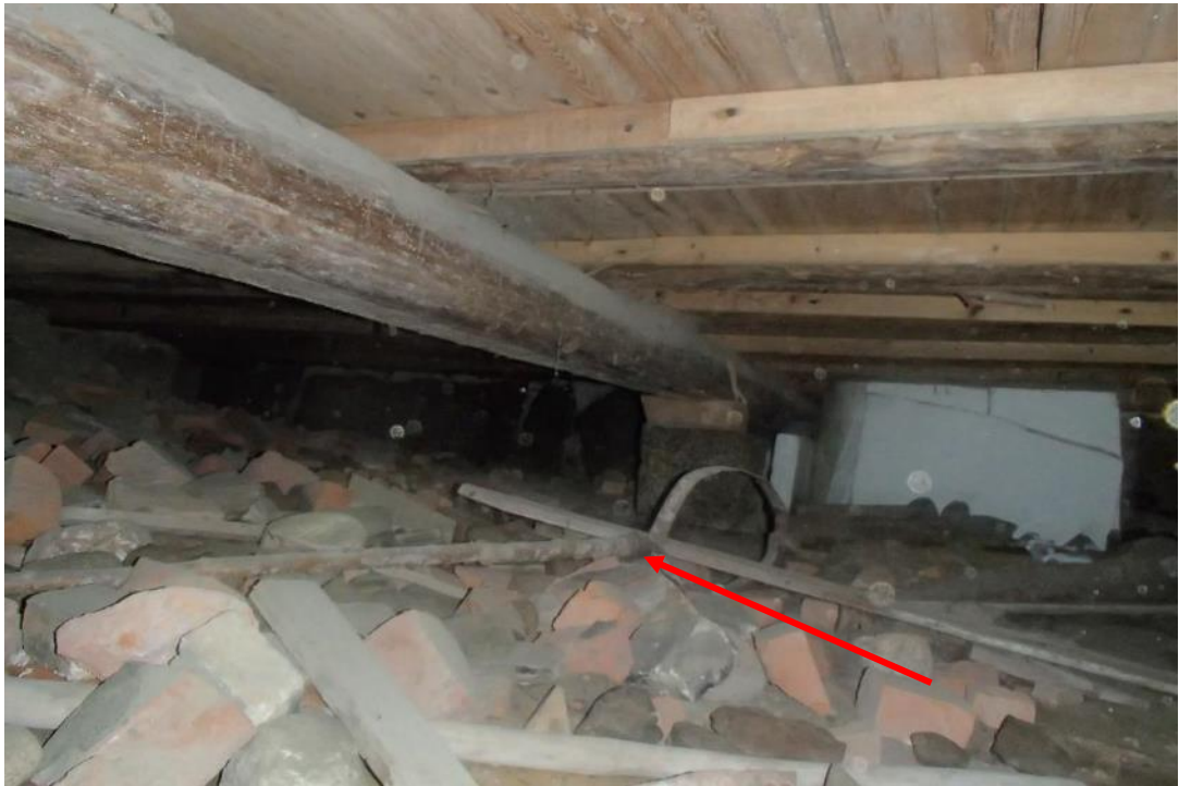
Kuva 97. Ryömintätilassa havaittiin ylimääräistä jätettä ja puumateriaalia.
