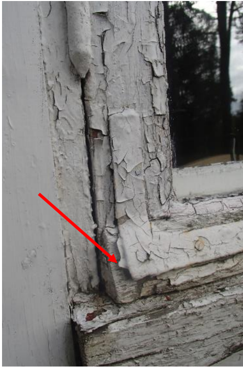
Kuva 49. Ikkunarakenteiden ulkopinnoilla havaittiin maalipintojen irtoilua, halkeilua ja hilseilyä sekä kulmaraudat ovat irti puupinnasta.
