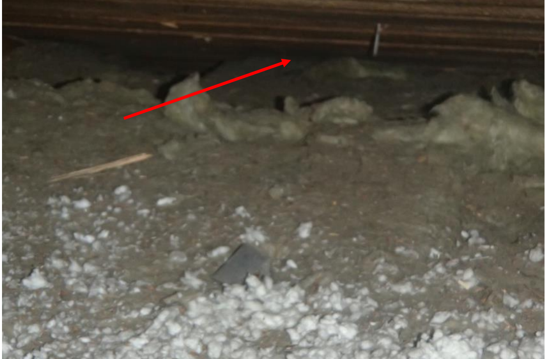
Kuva 130. Paikoin lisälämmöneristeet tukkivat räystäiden alapuolen tuuletusraot.
