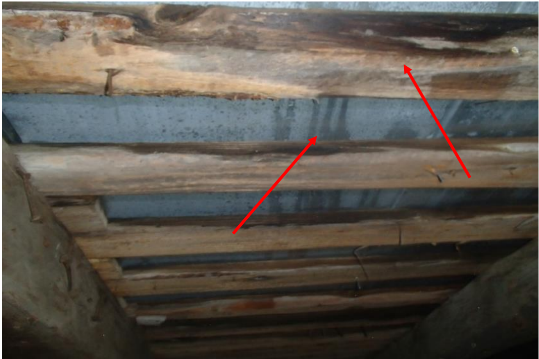
Kuva 123. Vesikatteen alapintaan kondensoituu kosteutta, joka imeytyy aluslautoihin.
