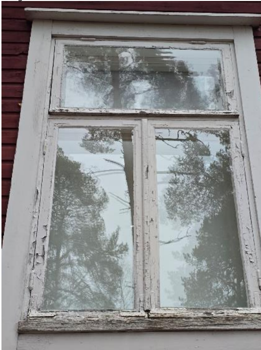
Kuva 46. Ikkunarakenteiden ulkopinnoilla havaittiin maalipintojen irtoilua, halkeilua ja hilseilyä.
