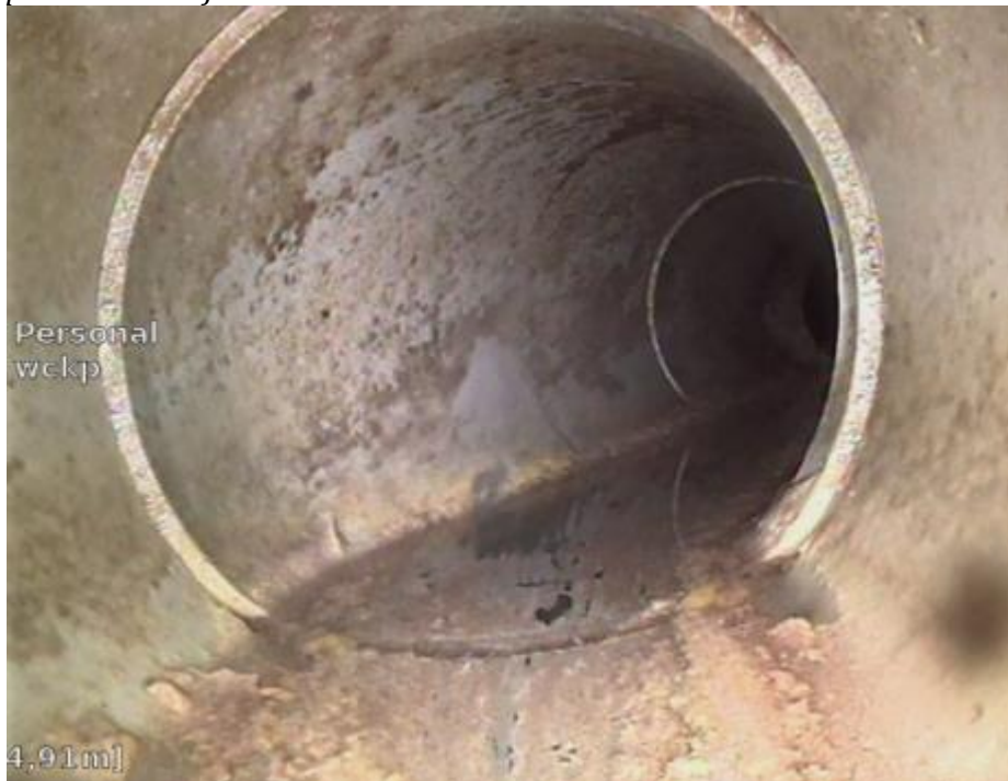
Kuva 140. Lievä kaltevuuspoikkeama 4,9 metrin kohdalla.
