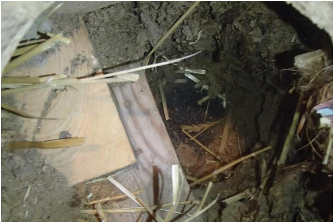
Kuva 87. Alapohjan eristeenä on vaurioherkkää orgaanista luonnonmateriaalia.
