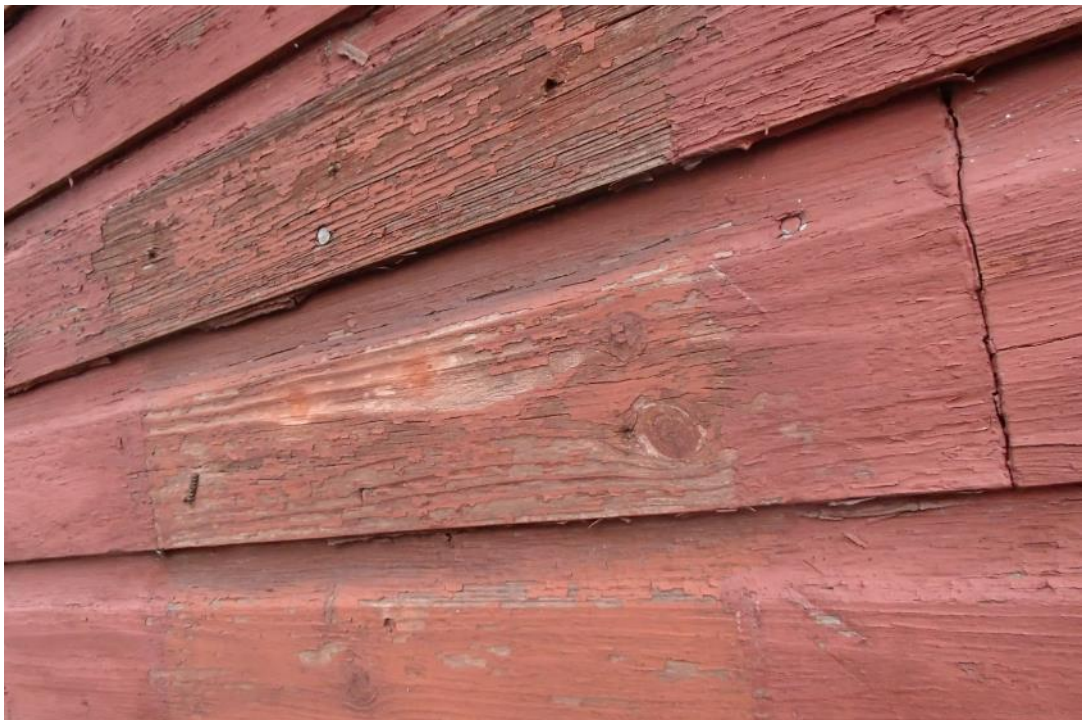
Kuva 22. Rakennuksen ulkoverhouspaneelissa havaittiin halkeilua, haristumista ja pinnoitteiden vaurioita.
