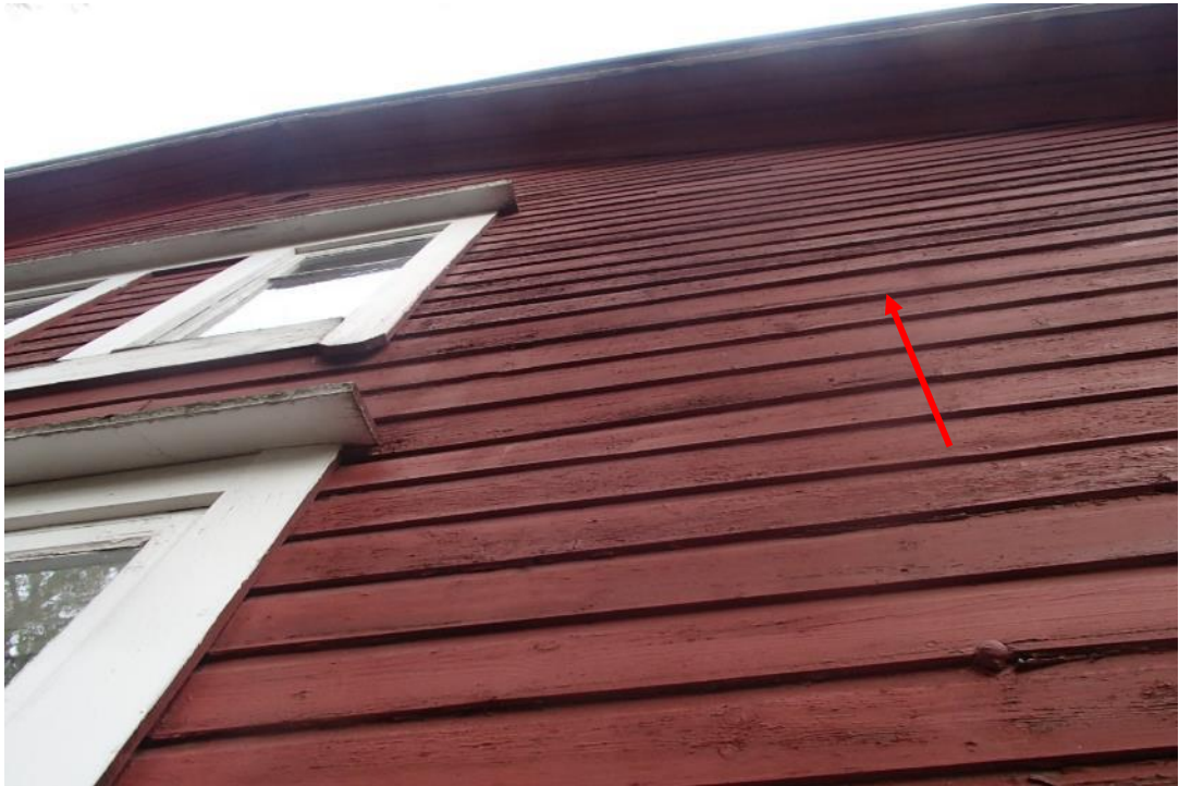
Kuva 19. Ulkoverhouspaneelissa havaittiin pullistumista yläpohjan alueella.
