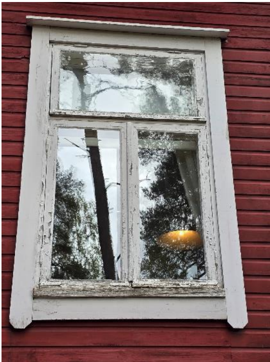
Kuva 42. Ikkunarakenteiden ulkopintojen maalipinnat ovat heikossa kunnossa.
