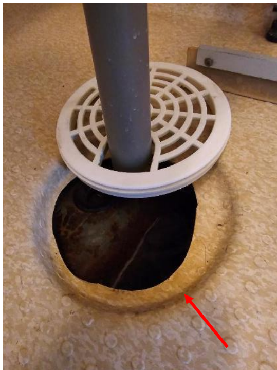
Kuva 94. Alapohjassa on valurautaviemäreitä ja muovimaton liitokset kaivoon ovat puutteelliset.
