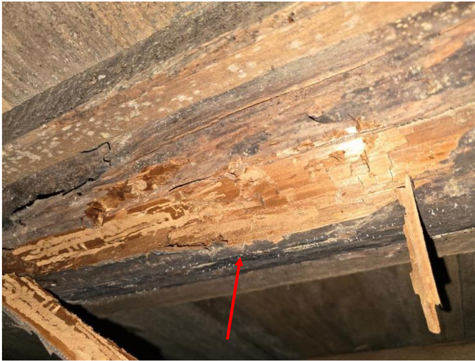
Kuva 103. Alapohjan runkokuissa havaittiin lahovaurioita ja hyönteisten tekemiä vaurioita.
