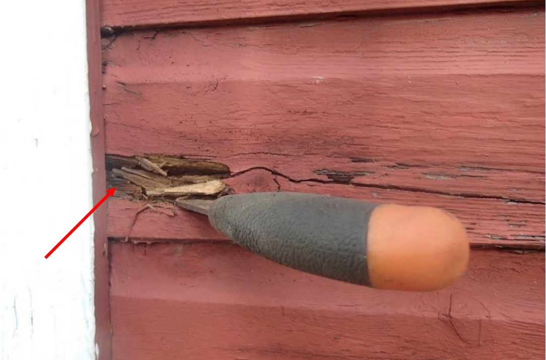
Kuva 12. Ulkoverhouksen lahovaurioita havaittiin myös rakennuksen eteläsivulla ikkunoiden ympärillä.
