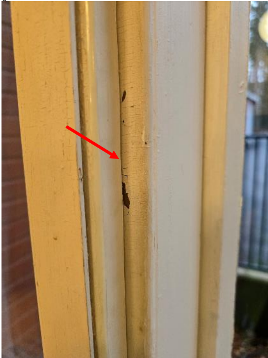
Kuva 54. Ikkunarakenteiden sisäpinnoilla havaittiin maalipintojen irtoilua, halkeilua ja hilseilyä.
