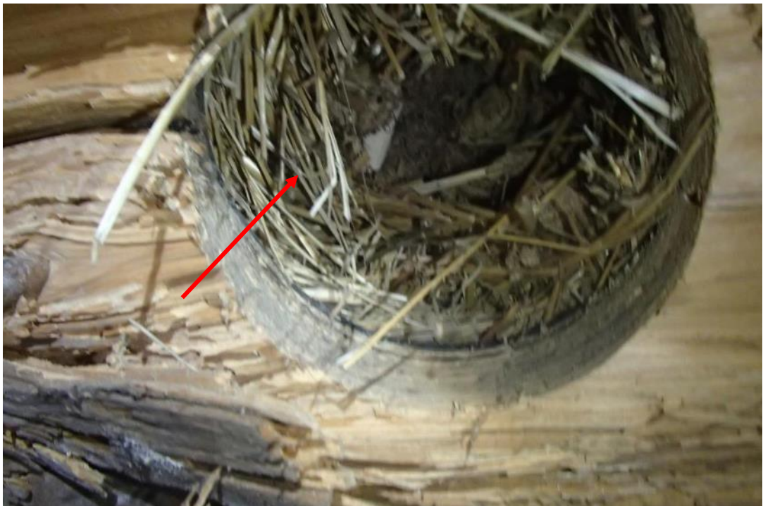
Kuva 92. Alapohjassa havaittiin avoimia reikiä.
