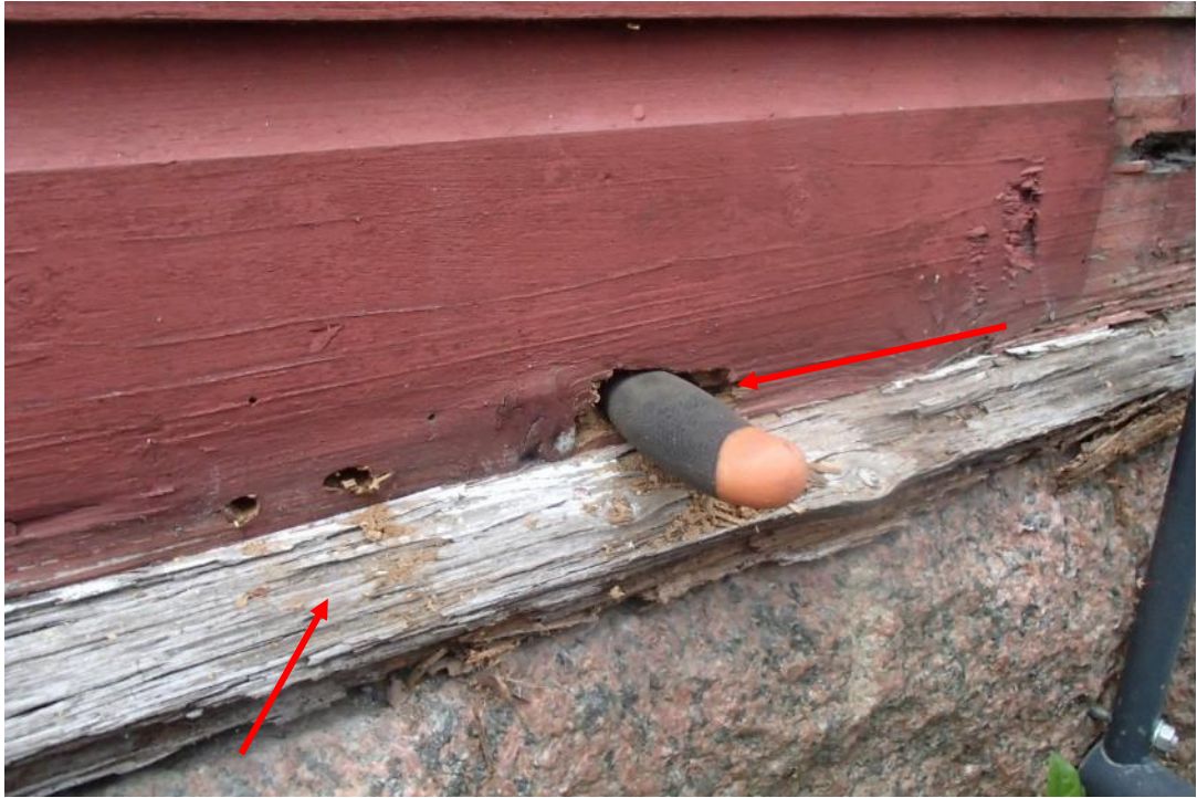
Kuva 11. Ulkoverhouksen alaosissa havaittiin maali- ja lahovaurioita.
