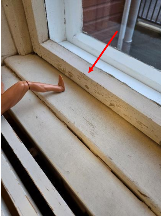
Kuva 53. Ikkunarakenteiden sisäpinnoilla havaittiin maalipintojen irtoilua, halkeilua ja hilseilyä.
