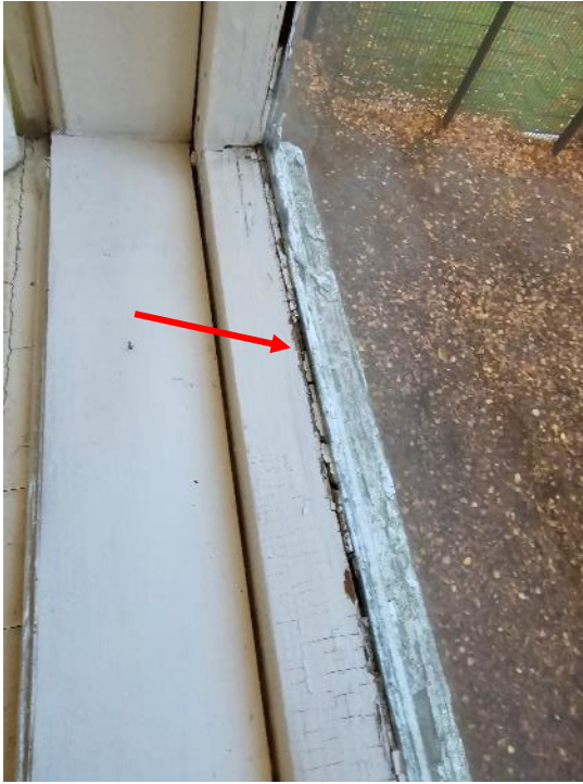
Kuva 67. Lasituskittausvaurioita havaittiin myös ikkunoiden välitilassa.
