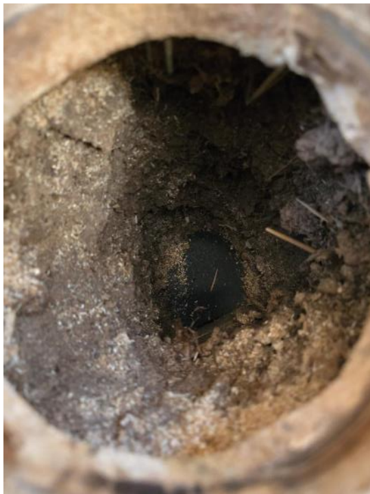
Kuva 88. Alapohjan eristeenä on vaurioherkkää orgaanista luonnonmateriaalia.
