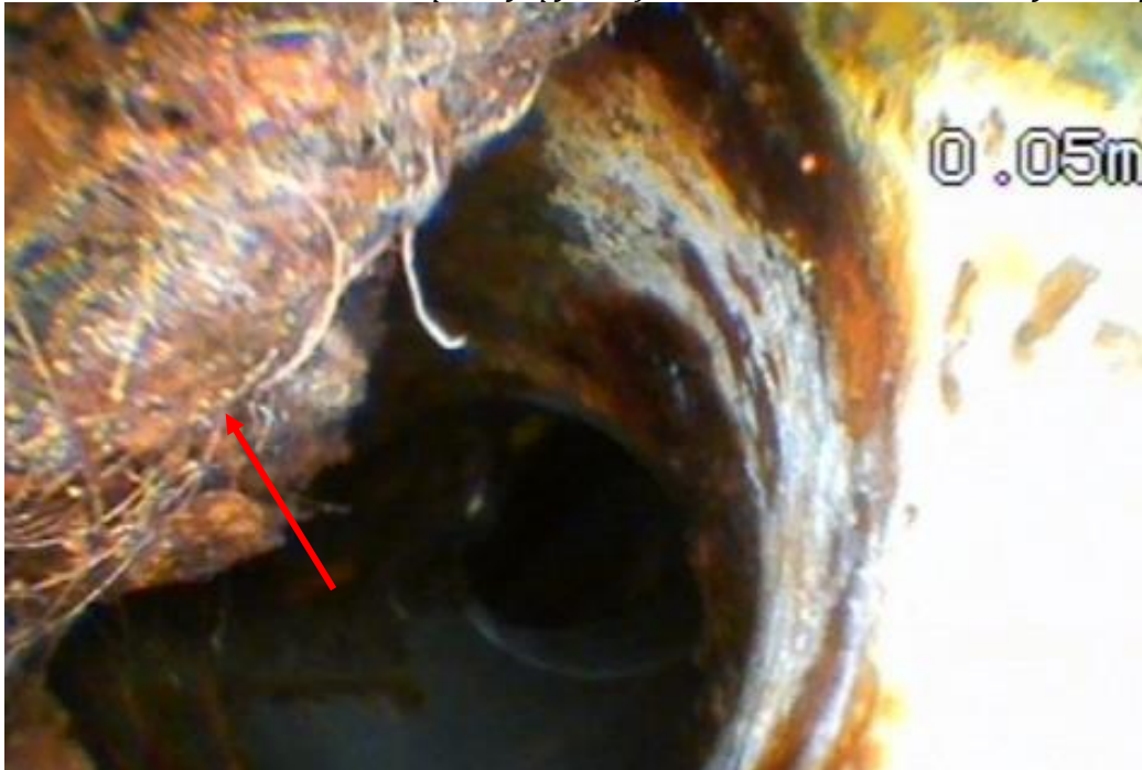
Kuva 136. Henkilökunnan pukuhuoneen suihkuhuoneen kaivon hajulukon jälkeen on havaittavissa irtonaista ruostetta.
