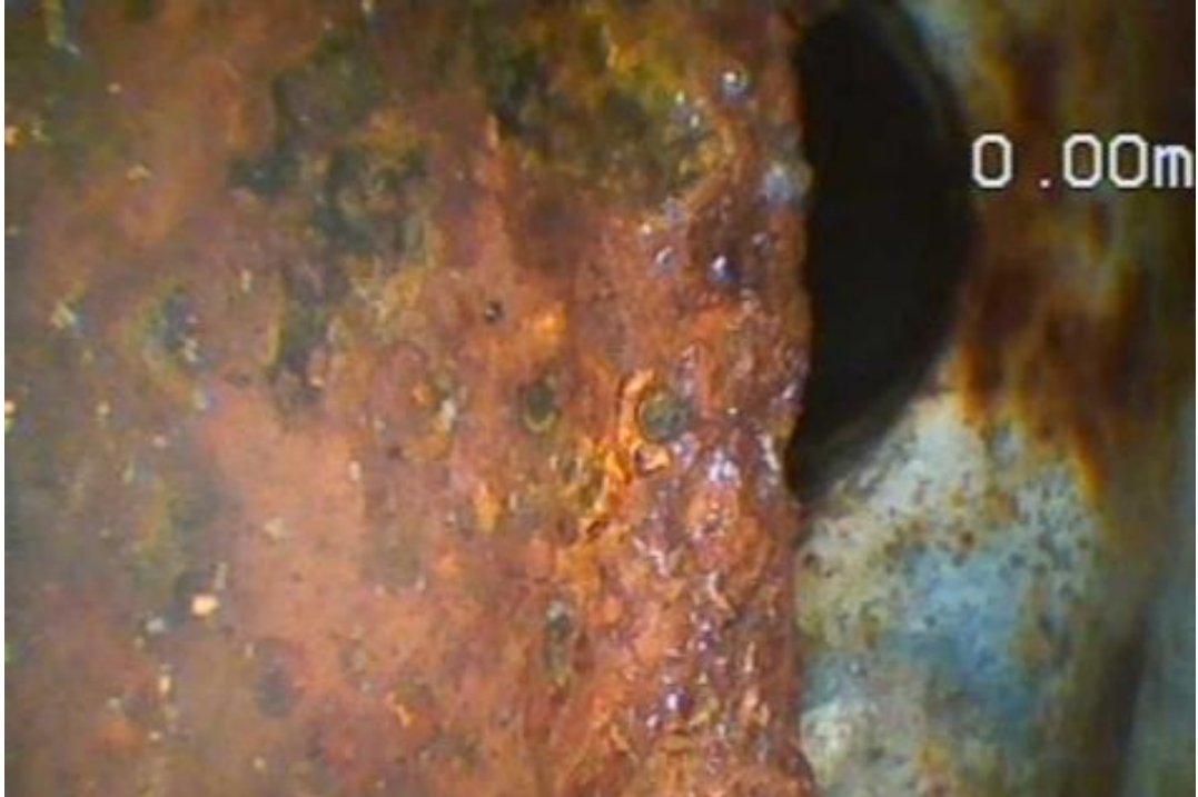
Kuva 135. Henkilökunnan pukuhuoneen suihkuhuoneen kaivo. Kaivo on valurautaa, jossa on havaittavissa liitoksen kohdalla pistesyöpmää ja korroosiota. Kaivo on liitetty muoviputkeen.
