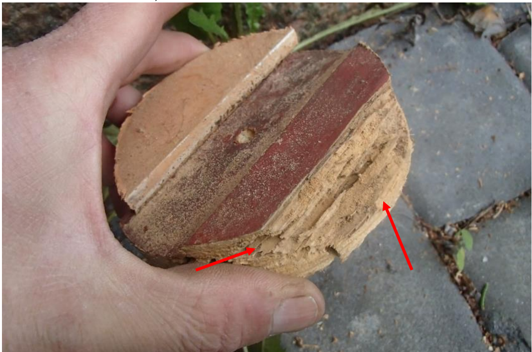
Kuva 14. Ulkoverhouspaneelien taustalla havaittiin lahovaurioita ja mikrobikasvustoa.
