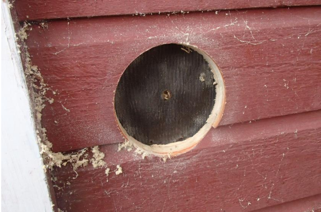
Kuva 30. Rakennuksen parkkipaikan puoleisella julkisivuilla paneelien taustalla havaittiin bituminen rakennuspaperi, mutta paneelien taustalla ei ole tuuletusväliä.
