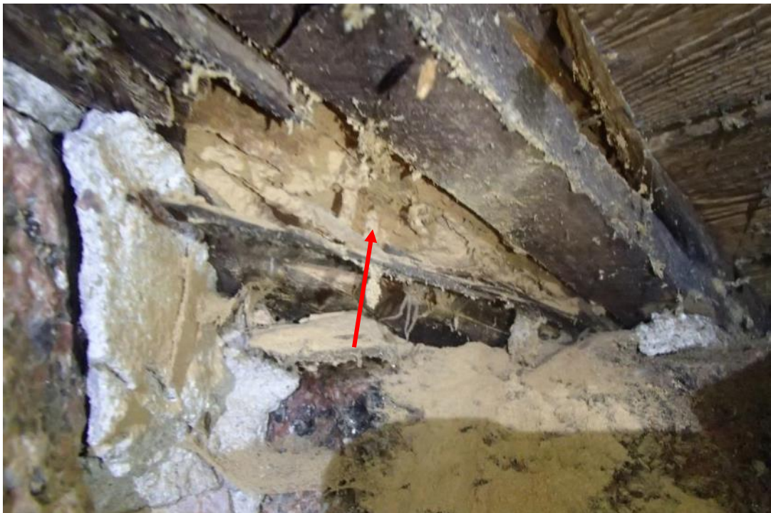
Kuva 104. Alapohjan runkokuissa havaittiin lahovaurioita.
