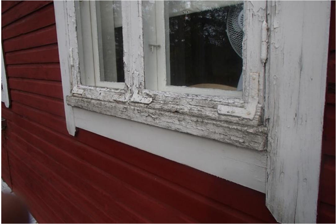
Kuva 47. Ikkunarakenteiden ulkopinnoilla havaittiin maalipintojen irtoilua, halkeilua ja hilseilyä.
