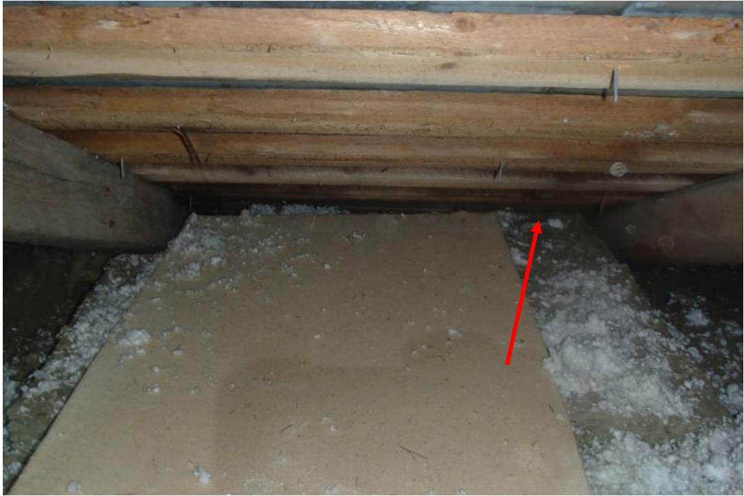
Kuva 131. Paikoin lisälämmöneristeet tukkivat räystääiden alapuolen tuuletusraot.
