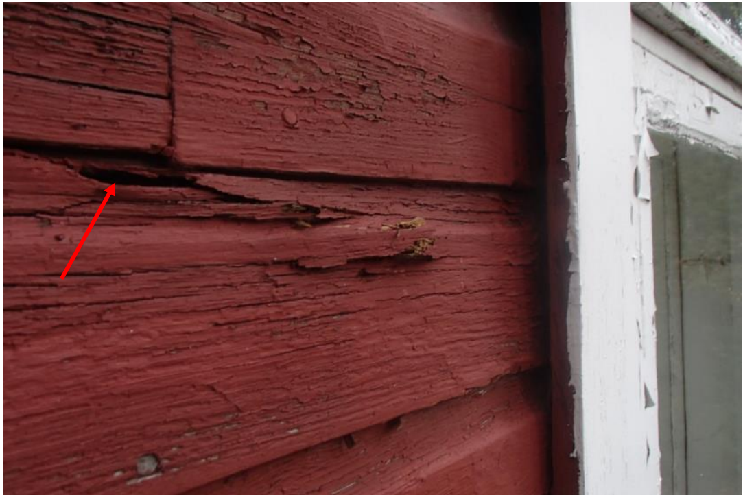
Kuva 13. Ulkoverhouksen lahovaurioita havaittiin myös rakennuksen eteläsivulla ja paneeleissa havaittiin halkeilua, haristumista sekä maalivaurioita.
