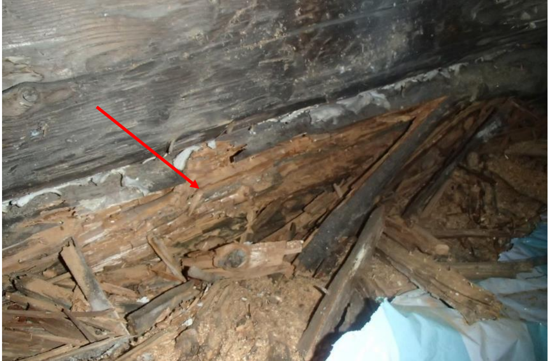
Kuva 126. Paikoin ulkovaipan hirsirungossa havaittiin lahovaurioita alkuperäisen eristeen ja lisälämmöneristeen rajapinnoilla.
