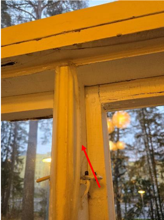
Kuva 73. Ikkunoita on lisätiivistetty, mutta tiivisteitä on irtoillut kiinnityksestään.
