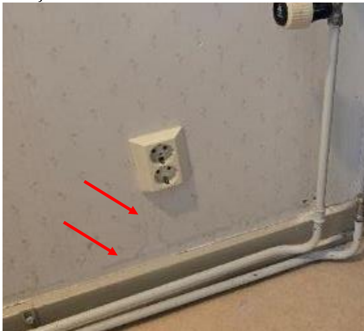
Kuva 36. Seinien kulmissa on viitteitä ylimääräisestä kosteudesta.
