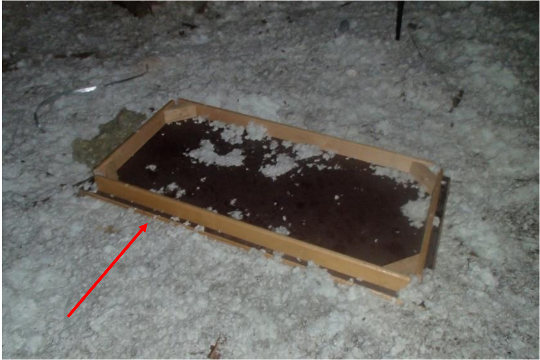
Kuva 133. Vinttillassa on jonkin verran ylimääräistä palokuormaa.
