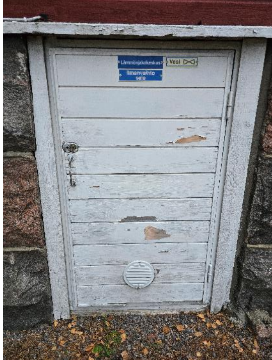
Kuva 78. Rakennuksen ovien maalipinnoilla havaittiin vaurioitumista.
