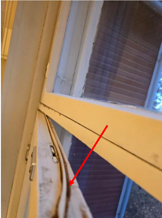
Kuva 71. Sisäikkunoiden alkuperäiset muovitiivisteet ovat jäykistyneet ja paikoin tiivisteet ovat vaurioituneet.
