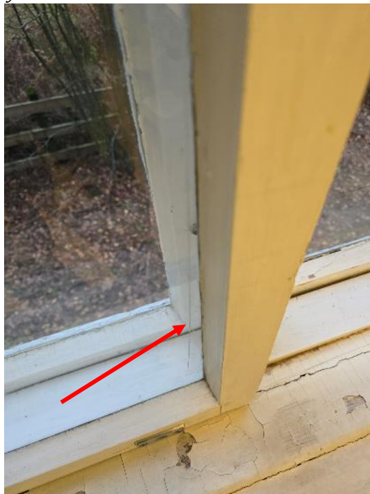
Kuva 60. Paikoin havaittiin rikkoutuneita laseja.
