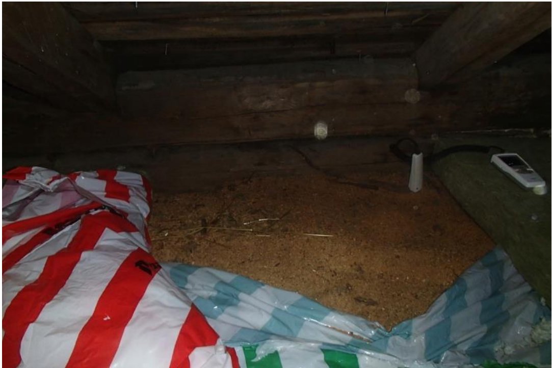
Kuva 127. Lisälämmöneristeen alapuolelle on levitetty pakkausmuoveja, joiden pintoihin kondensoituu kosteutta tietyissä olosuhteissa.
