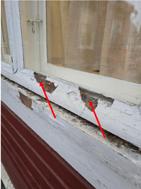
Kuva 65. Ikkunoiden lasituskittaukset ovat irtoilleet ja halkeilleet.
