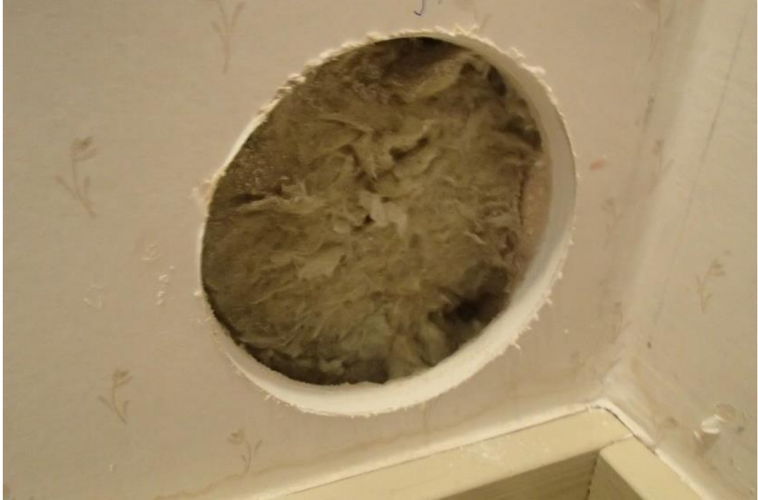
Kuva 32. Sisäpuolen kipsilevyjen taustalla ei ole ilmasulkupaperia eikä höyrysulkumuovia.
