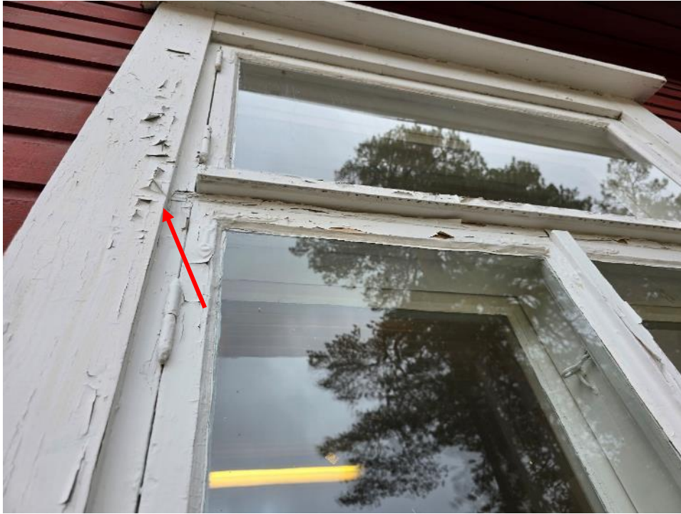
Kuva 25. Ikkunoiden vuorilaudoissa havaittiin maalivaurioita.
