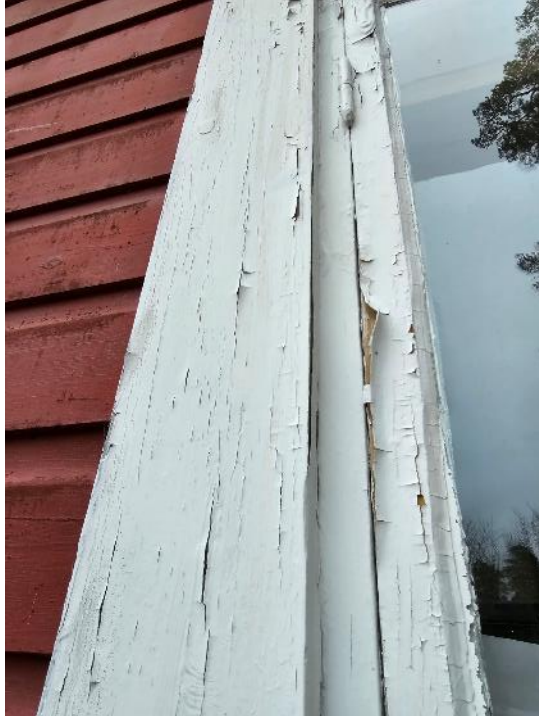
Kuva 26. Ikkunoiden vuorilaudoissa havaittiin maalivaurioita.
