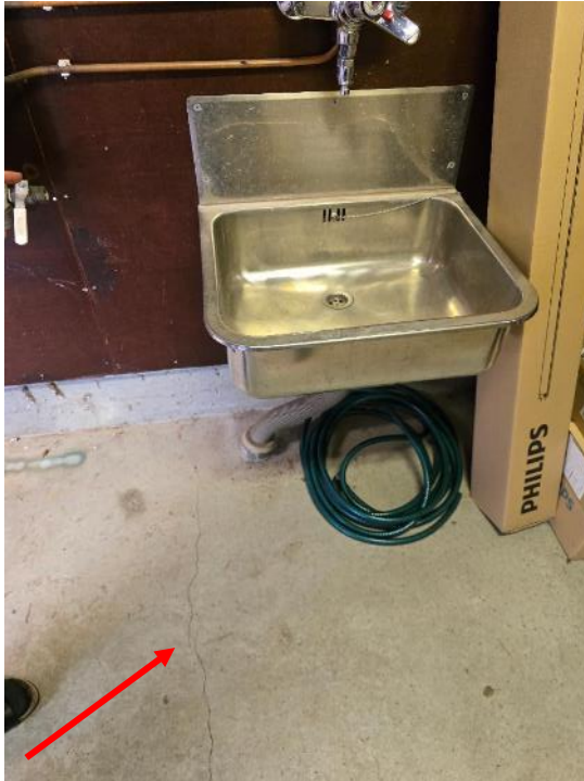
Kuva 111. Teknisen tilan lattiapinnoitteet ovat kuluneet sekä betonilaatassa havaittiin halkeilua.
