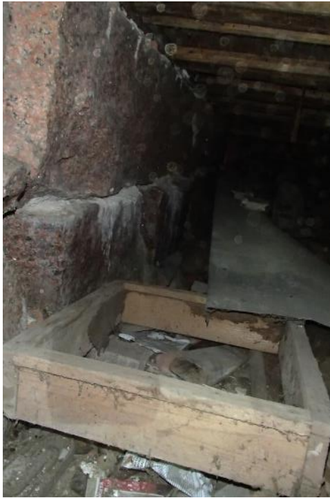
Kuva 99. Ryömintätilassa havaittiin ylimääräistä jätettä ja puumateriaalia.
