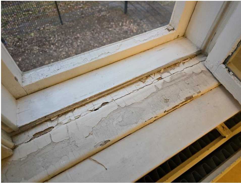
Kuva 59. Ikkunarakenteiden sisäpinnoilla havaittiin maalipintojen irtoilua, halkeilua ja hilseilyä.
