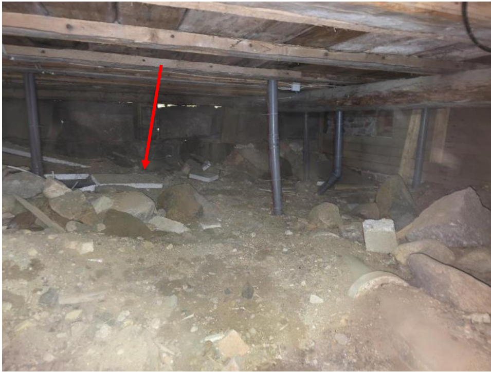
Kuva 95. Ryömintätilassa havaittiin ylimääräistä jätettä ja puumateriaalia.
