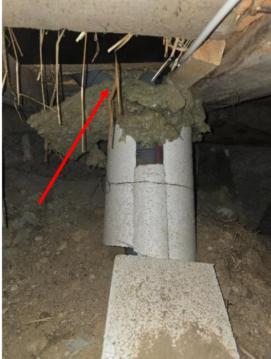
Kuva 108. Paikoin viemäriputkia on eristetty, mutta paikoin eristeet ovat irronneet.
