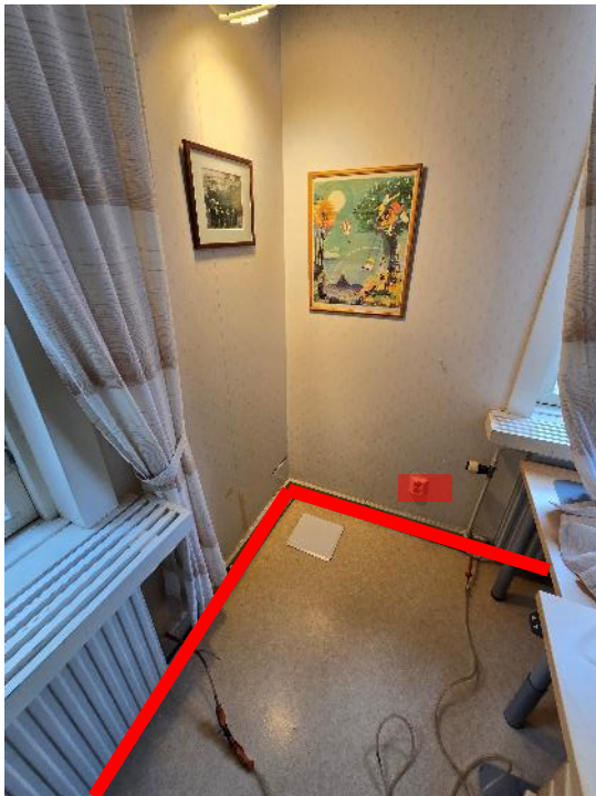
Kuva 164. Johtajan huoneessa havaittiin ilmavuotoa lattioidenraajapinnoilta ja pistorasian kautta.
