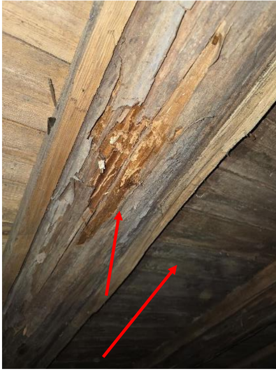
Kuva 101. Alapohjan runkokuissa havaittiin lahovaurioita sekä alalautoitusten alapinnoilla on tummaa mikrobikasvustoa.
