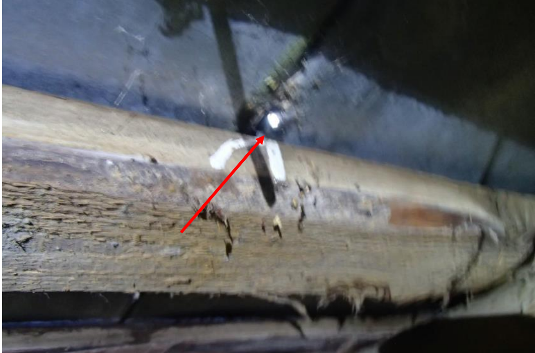
Kuva 122. Rakennuksen pääsisäänkäynnin kohdalla havaittiin vesikatteessa pieni reikä.
