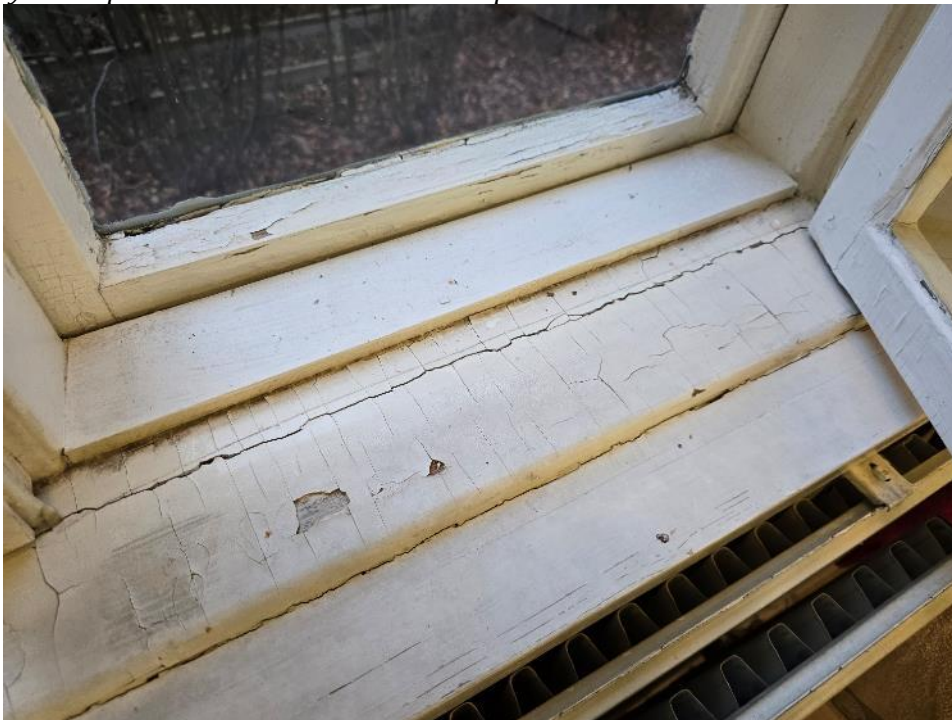
Kuva 56. Ikkunarakenteiden sisäpinnoilla havaittiin maalipintojen irtoilua, halkeilua ja hilseilyä.
