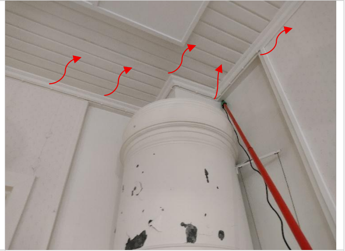
Kuva 38. MA 2. Tila 17 ryhmähuone. Kuvaa yläpohjan kautta havaituista vuodoista.
