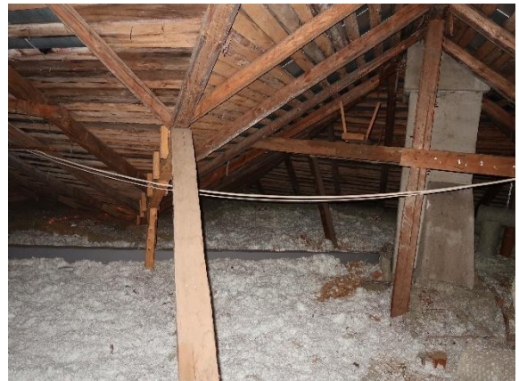
Kuva 69 Ullakolla roikkuu kiinnittämättömiä kaapeleita.
