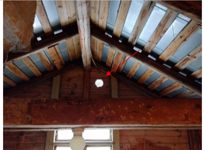
Kuva 25. Myös koillispuoleiseen (parkkipaikan puoleiseen) rakennuksen pätyyn oli lisätty tuuletusventtiili.
