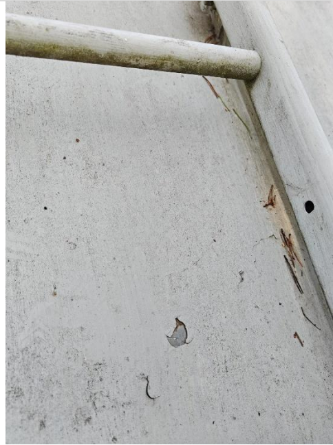
Kuva 4. Vesikatteen pinnassa oli hilseilyä ja maalipinnan irtoilua.
