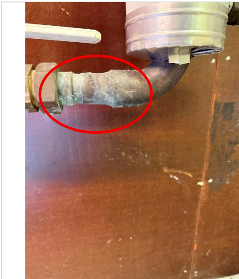
Kuva 56. LV-juotosliitoksessa merkkejä vuodosta / sinkinkadosta
