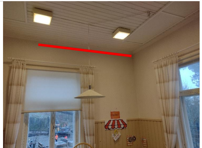
Kuva 40. MA YP3. Kuvaa alapuolelta tilassa 15 toimenpidehuone/ pienoiskeittiö havaituista ilmavuodoista. Ilmavuotoja havaittiin katon ja ulkoseinän välisessä liitoksessa. Vuodot olivat volyymiltaan voimakkaita ja luokitellaan merkittäviksi ilmavuodoiksi.
