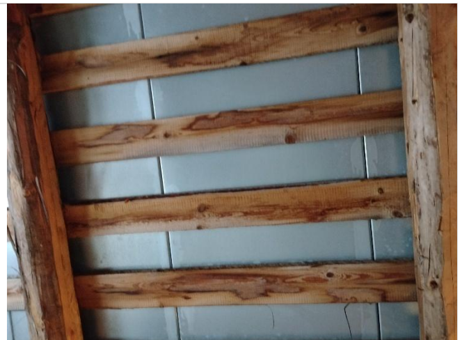
Kuva 27. Vesikatteen alla ei ollut aluskatetta
