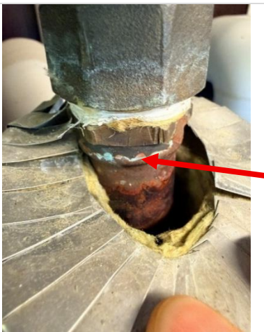
Kuva 54. LV-juotosliitoksessa merkkejä vuodosta / sinkinkadosta.
