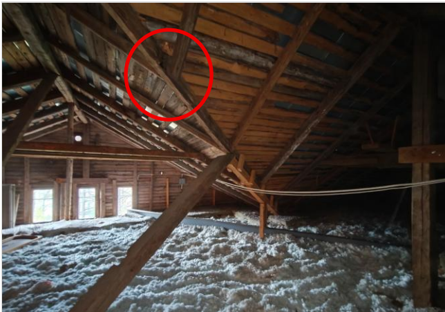
Kuva 18. Kuvaa lahovauriosta. Lahovauriohavainto paikantui vesikaton aumaan.
