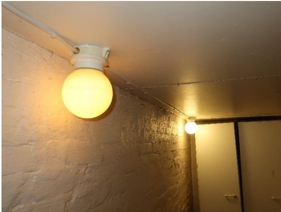
Kuva 78 Yleiskuva kellarin hehkulamppuvalaisimista.
