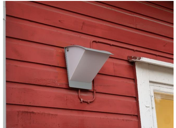
Kuva 81 Yleiskuva ulkoseinälle asennetusta pienoisoisloistelamppuvalaisimesta.
