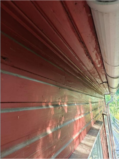
Kuva 11. Räystäsrakenteissa ei ollut yläpohjan tuuletusrakoa. Räystäslaudoituksen maalipinta hilseilee ja on pehmentynyt saumoista, vaikkakin laajoja lahovaurioita ei tunnistettu. Räystäiden kuntoon ovat voineet vaikuttaa sadevesikourun ylivuodot.
