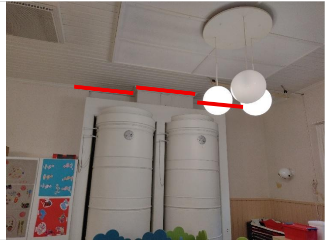
Kuva 34. MA YP1. Kuvaa alapuolisesta tilasta 5 ryhmähuone. Vuotoa havaittiin yläpohjan ja piipun välisessä liitoksessa, liitoksen ympärillä seinien ja yläpohjan liitoksessa, sekä paikoin alapuolisen sisäverhousoinnin saumojen kautta.
