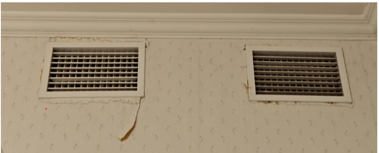
Kuva 45. Vasen tuloilmapäätte ja oikea poistoilmapäätte. Molempien päätteiden ympärillä vanhoja vesivuotojälkiä.
