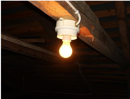
Kuva 80 Valaisimista puuttuu kupuja.
