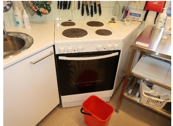
Kuva 73 Keittiössä sijaitseva liesi.
