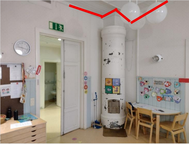
Kuva 37. MA 2 tutkimukset. Kuva alapuolisesta tilasta 17 ryhmähuone. Vuotoa havaittiin piipun ja yläpohjan liitoksen, sekä seinän ja yläpohjan liitosten kautta.
