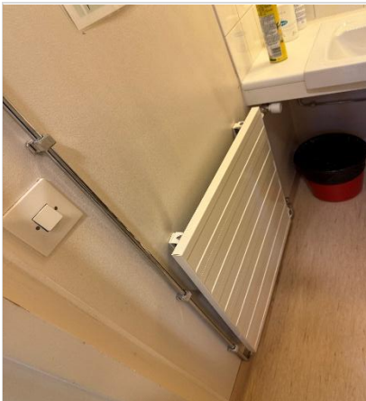
Kuva 64. WC:n on lisätty ainakin yksi sähköpatteri lisäläm- mitystarvetta varten
