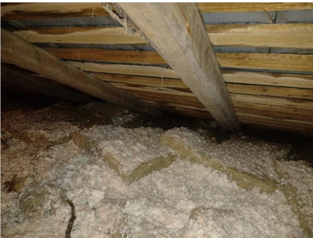
Kuva 26. Vesikatteen läpi on naulattu ruoteisiin
