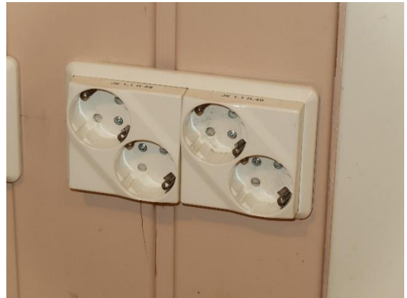
Kuva 77 Yleiskuva uusista pistorasioista.
