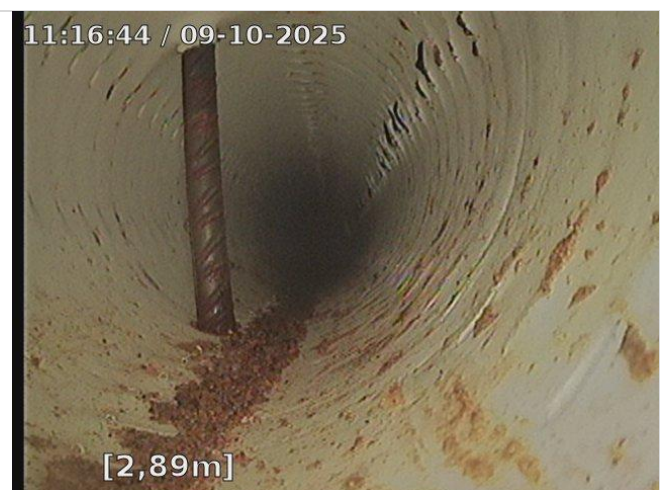
Kuva 53. SOK 12 - SOK 11 3 metrin kohdalla harjateräs lävis-tänyt linjan
