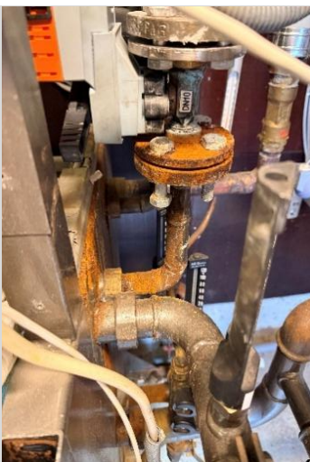
Kuva 60. LJH venttiilirunko on aiemmin vuotanut. Tarkastushetkellä ei näkyvää vuotoa.
