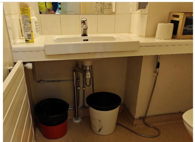
Kuva 59. Pesuallaskaluste-esimerkki. Vesikalusteiden ikä on 20–30 vuotta, joten niiden uusiminen on ajankohtaista.
