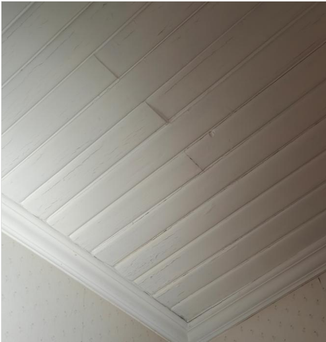
Kuva 28. Kattopaneelien pinnat olivat kuivat, vaikkakin maalipinta oli marmoroitunut ja halkeillut ulkoseinän reunoilla.
