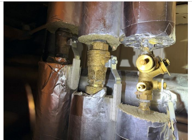
• Kuva 55. Säätö- ja sulkuventtiilein tekninen elinkaari on lopussa.
