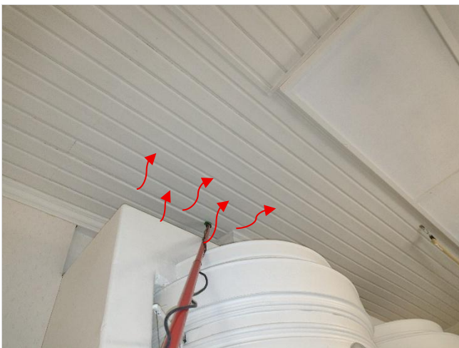
Kuva 35. MA YP1. Vuotoa havaittiin yläpohjan kautta myös sisäverhouksen kattopaneloinnin välistä.
