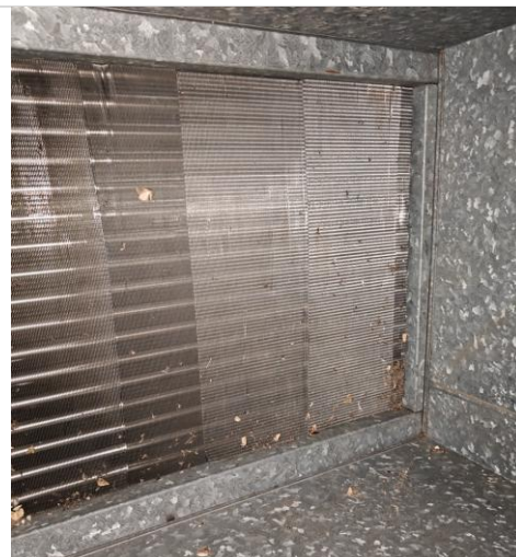
Kuva 43. Lämmityspatteri on roskainen, mikä heikentää ilmastusta, lämmönsiirtoa
