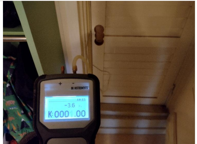
Kuva 32. Paine-ero yläpohjan ja alapuolisten tilojen välillä mitattiin ullakon oven kautta. Alapuoliset tilat olivat tutkimushetkellä n. -4...-3 Pa alipaineisia ullakkotilaan/ yläpohjaan nähden.
