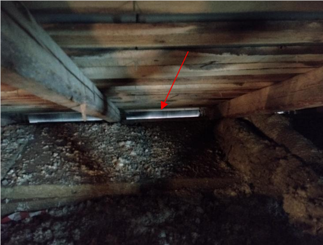
Kuva 24. Lounaanpuoleiselle (pääsisäänkäynnin puoleiselle) sivulle oli jätetty pieni tuuletusrako ulkoseinän ja räystään väliin.
