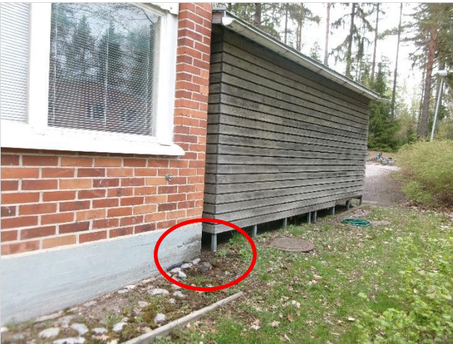
Kuva 11. Rakennuksen keittiön puoleiseen päädyn sokkeliin kohdistuu kosteusrasitusta maaperästä.
