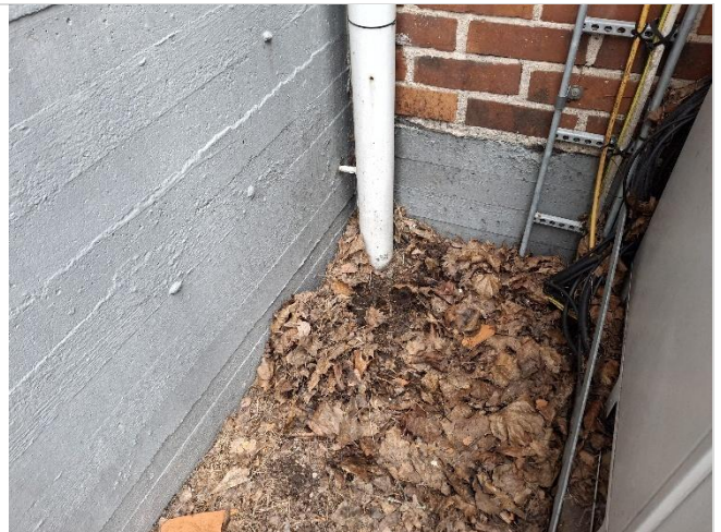
Kuva 12. Taloteknisen kaapin ja seinän väliin on kertynyt lehtiä ja kariketta.
