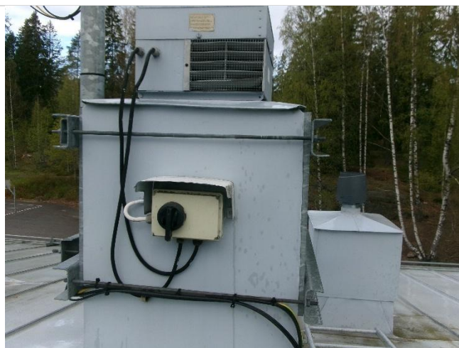
Kuva 111. Tutkimushetkellä kaikki muut erillispoistot olivat päällä paitsi teknistien luokkaa palveleva erillispoistokone. Kuvan erillispoistosta puuttui merkinnät.
