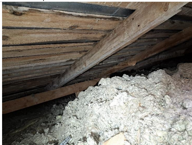
Kuva 76. Puhallusvilla oli kasaantunut. Alkuperäisissä alusrakenteissa oli kosteusjälkiä, syntyajankohdasta ei ole tietoa.
