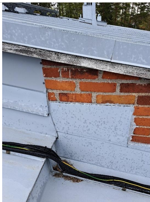
Kuva 89. Sähköjohdot olivat kattopeltiä vasten. Tiivistysmassaukset ovat hapertuneet ja irronneet alustastaan.
