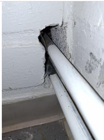
Kuva 69. Patteriputkien läpivienti oli epätiivis.
