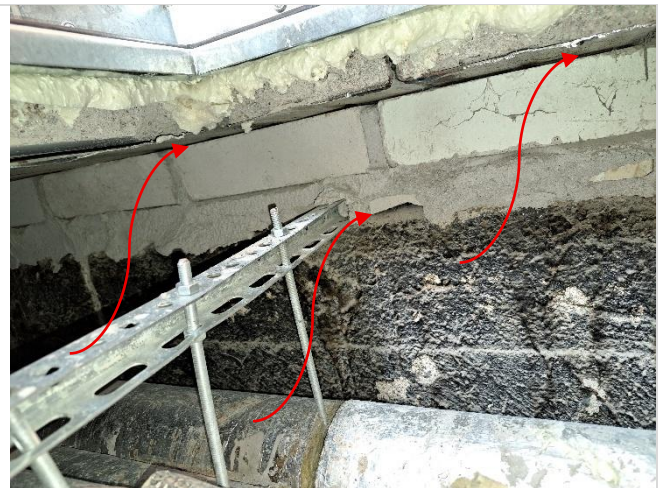
Kuva 24. Kanaalista oli kuitenkin ilmayhteys alapohjarakenteeseen ja ulkoseinärakenteeseen.
