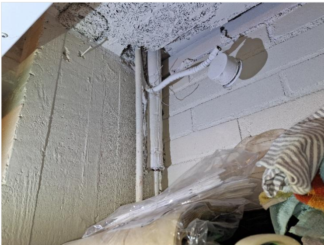
Kuva 96. Siivouskeskuksessa 018 havaittiin vanhoja sähköasennuksia ja putkiasennuksia, joiden eristeissä on haitta-aineita.
