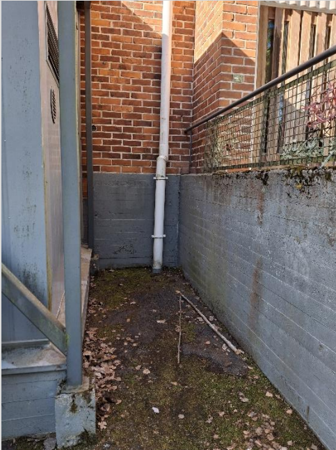
Kuva 9. Keittiön sisäänkäynnin taakse jää varjoinen ja kostea potero, josta sadevedet haihtuvat hitaasti. Ulkoseinä oli vaurioitunut muurin päälle satavista vesistä.
