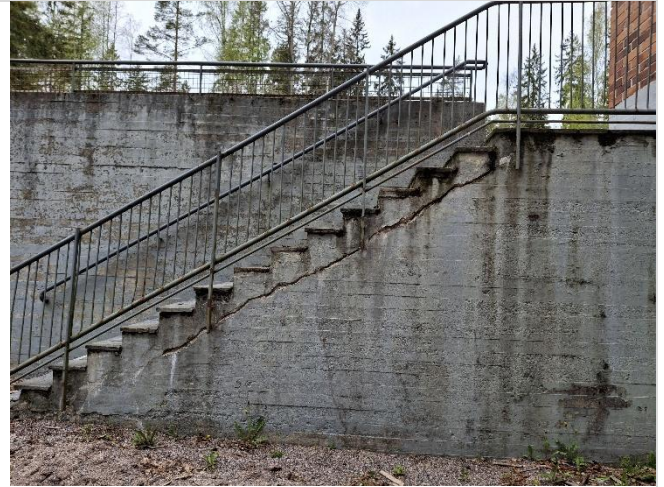
Kuva 51. Ulkorakenteet ovat rapautuneet. Talon toisella puolella oleva muuri oli myös rapautunut.
