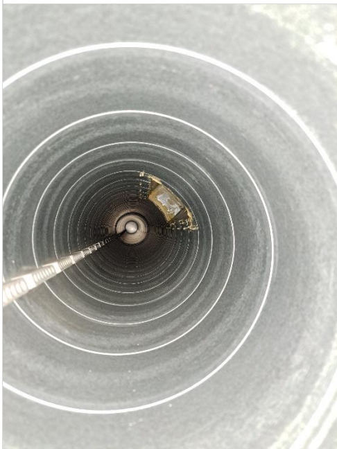
Kuva 106. Ruokasali 036 tuloilmakanavassa havaittiin vähäinen määrä metallisiruja.
