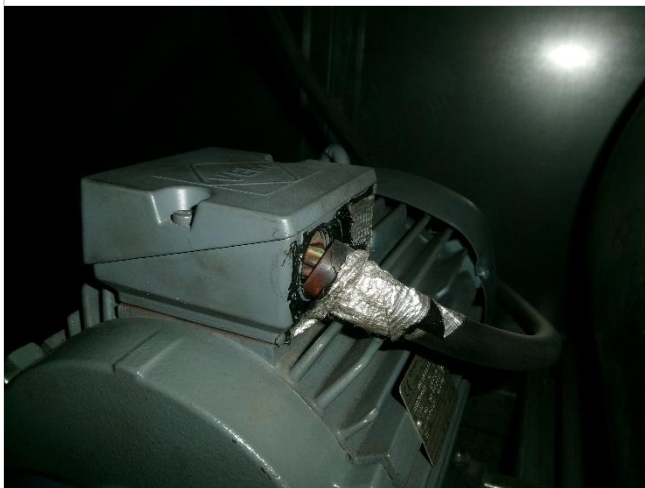
Kuva 100. TK1 poistopuhallinkammion sähkökytkentä tulisi korjata asianmukaisesti.
