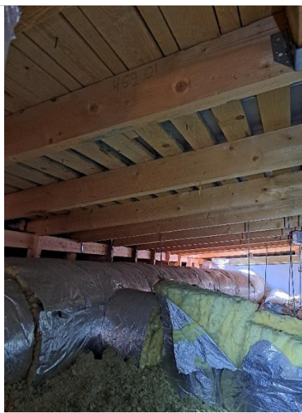
Kuva 78. Ilmanvaihtokanavien eristeet auenneet monin paikoin.
