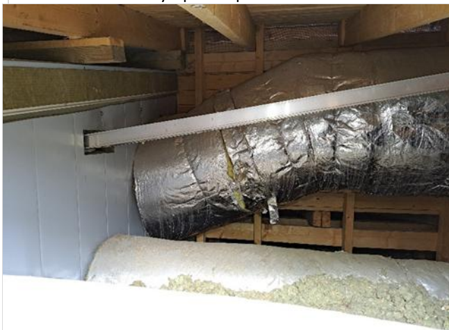
Kuva 75. Yläpohjatilaa iv-konehuoneen kohdalta. Ilmanvaihtokanavien teippaukset puuttuvat.
