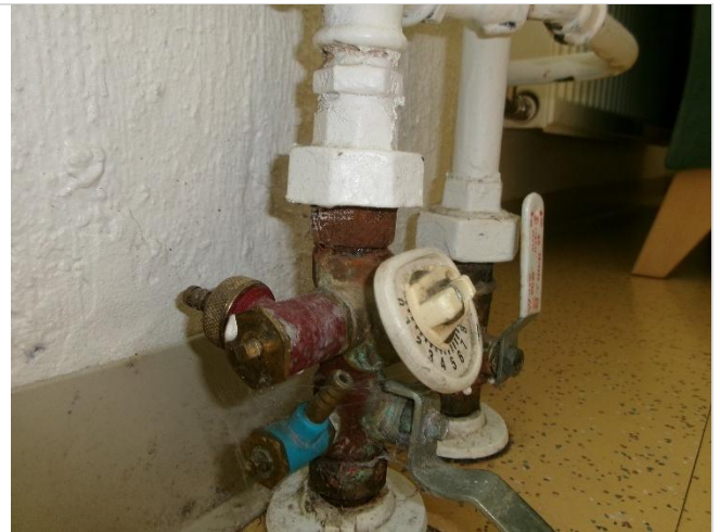
Kuva 20. Pohjakerroksen tiloissa on vanhoja venttiilejä, myös uudemmat venttiilit, kuvassa takana, tulisi jo uusia.
