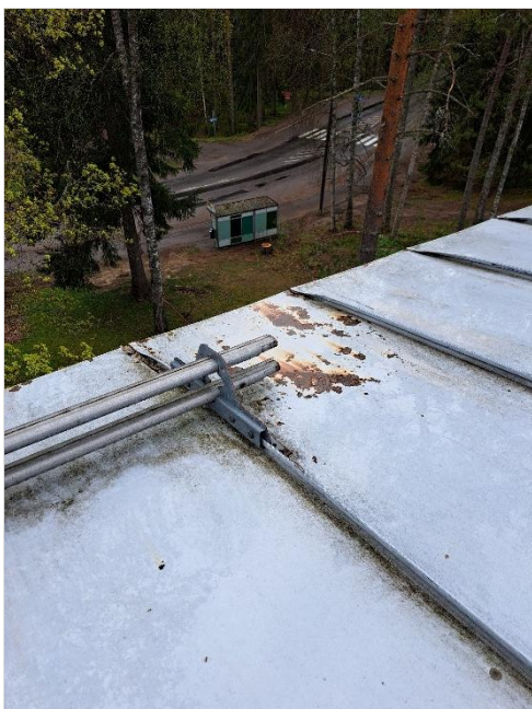
Kuva 88. Kattopellissä paikoin paljon korroosiota.
