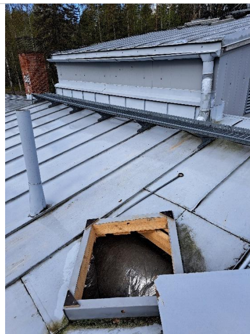
Kuva 83. Kulku yläpohjatilaan on vesikatolla olevien luukkujen kautta. Kuvassa näkyvän viemäriputken kohdalla havaittiin vuotoa.
