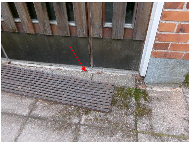
Kuva 54. Päätyoven alle pääsee sadevesiä, jotka kastelevat portaikon laattaa. Raossa näkyi vaurioitunutta puurakennetta.
