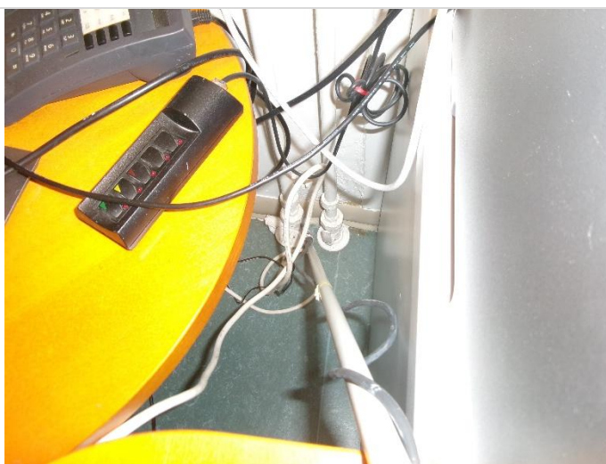
Kuva 57. Terveydenhoitajan huoneen 010 ulkoseinän eristetilaan laskettua merkkiainetta kulkeutui ulkoseinän vieressä olevaan kanaaliin ja sitä kautta lämpöputkien läpivientien kautta sisälle.
