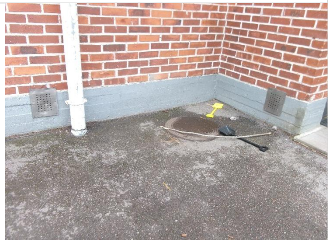
Kuva 8. Sisäänkäynnin vieressä havaittiin sokkelissa kaksi peltilevyin peitettyä aukkoa, joiden käyttötarkoitus ei selvinnyt.
