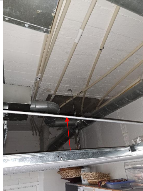
Kuva 72. Luukusta ei pääse enää kulkemaan. Kulkuyläpohjatilaa on vesikaton kautta.
