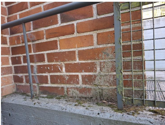
Kuva 42. Päädyn sisääntulon kohdalla betonimuuri jatkuu ulkoseinälle ja sen päälle satava vesi pääsee kastelemaan ulkoseinärakennetta.
