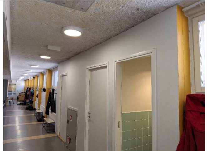
Kuva 47. Rakenneliittymät uuden ja vanhan rakenteen välillä ovat epätiivit.
