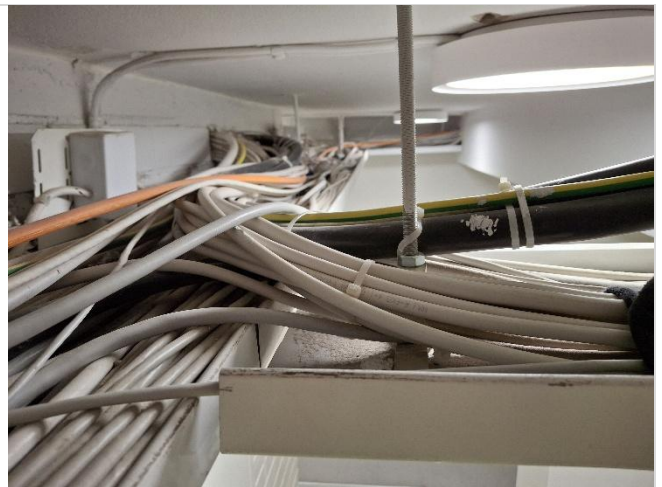
Kuva 97. Tiloissa oli jonkin verran yläpölykertymää. Kuva terveydenhoitajan huoneen 010 läheltä käytävästä.
