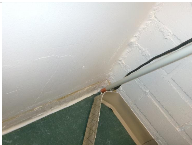
Kuva 45. Seinä-lattialiitokseen muovilistan taakse oli asennettu elastinen massa, joka ei ole tiivis.
