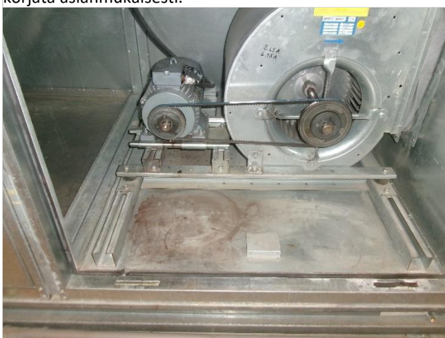
Kuva 102. Ilmanvaihtokoneen sisällä havaittiin hieman korroosiojälkiä.
