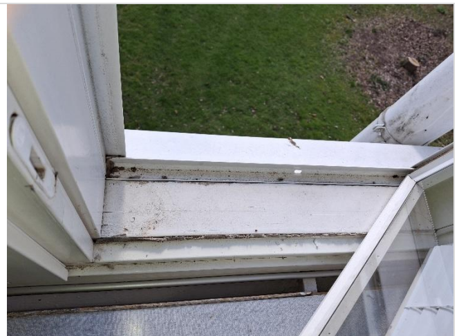
Kuva 53. Tuuletusikkunoiden sisälle on päässyt hieman kosteutta. Osassa ikkunoita tiivisteet olivat huonossa kunnossa.
