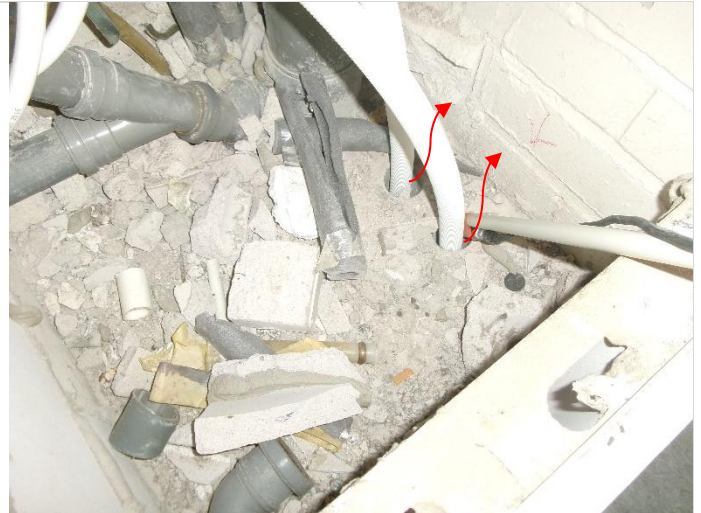
Kuva 63. Luokkatilassa 209 havaittiin merkkiainetta tekniikkakuilun sisältä läpivientien kohdalta. Kotelon pohjalla oli paljon rakennusjätettä.
