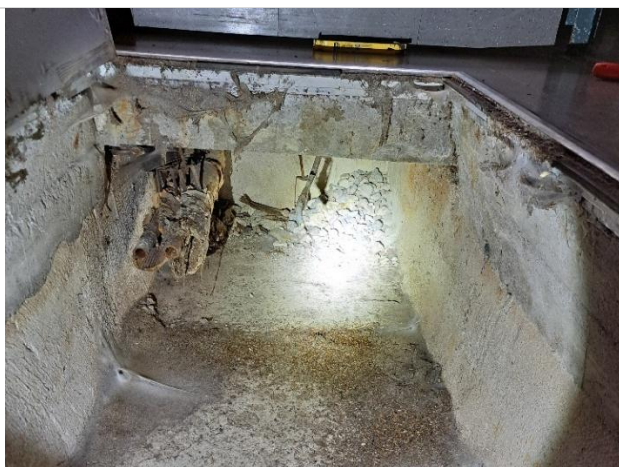
Kuva 30. Kanaaliin jäänyt vanhoja lämpölinjoja purkamatta, joissa mahdollisesti asbestipitoinen eriste.
