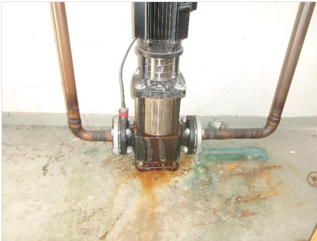
Kuva 19. Kiinteistöhuollon tilassa 004 vuotaa pumppu lattialle.
