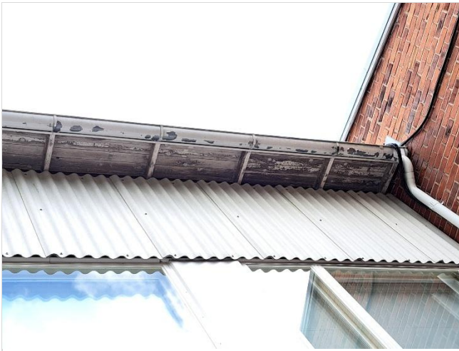
Kuva 80. Räystäslautojen maalipinta kulunut pois ja laudat ovat likaantuneet
