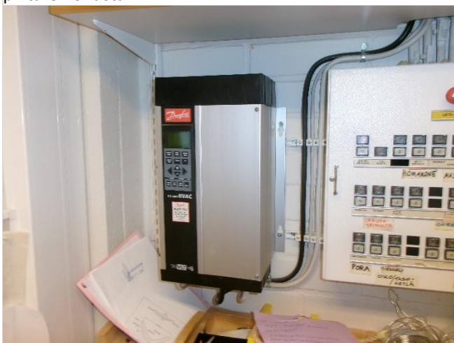
Kuva 110. Kuvassa on teknistien luokan ilmanvaihdon säätölaite. Tutkimuksessa ei täysin selvinnyt erillispoiston toimivuus tai sen käytönaikainen tuloilman säätö.
