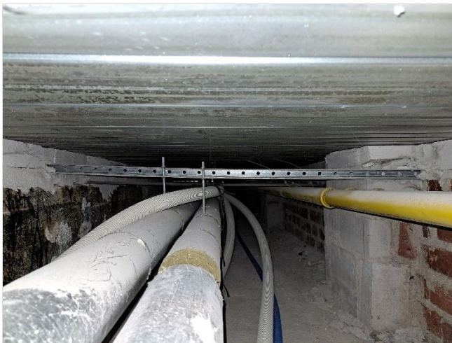
Kuva 25. Kanaaleissa kulkee vesiputkia suojauputissa.
