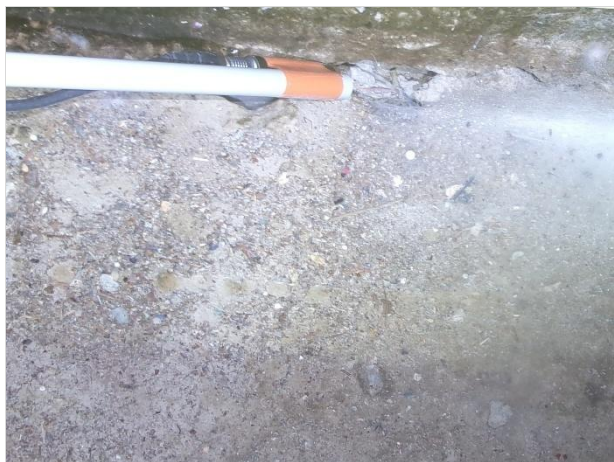
Kuva 31. Terveydenhoitajan huoneen alapohjaan laskettu merkkiaine kulkeutui käytävän kanaaliin epätiiviu- den betonirakenteiden kautta.
