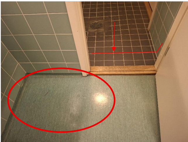
Kuva 15. Sosiaalitulassa 017 havaittiin kohonnutta kosteutta viiltomittauksessa VK2 muovimaton alla. Mahdollisesti kosteus on päässyt lattiarakenteeseen suihkutilan 016 lattiassa olevan halkeaman kautta.
