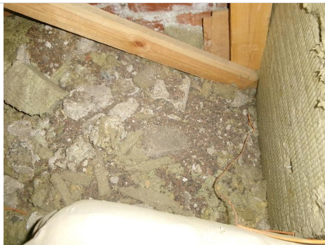
Kuva 74. Puhallusvilla oli asennettu puutteellisesti liikuntasalin päällä.
