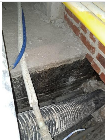
Kuva 26. Vesiputkien suojauputitus on osin puutteellinen.
