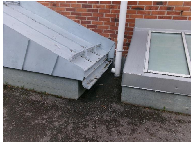
Kuva 49. Pohjakerroksesta nousee portaat ensimmäiseen kerrokseen. Sadevesikouru on rikottu. Vieressä on pohjakerroksen tyttöjen pukuhuoneeseen tehty valoaukko.
