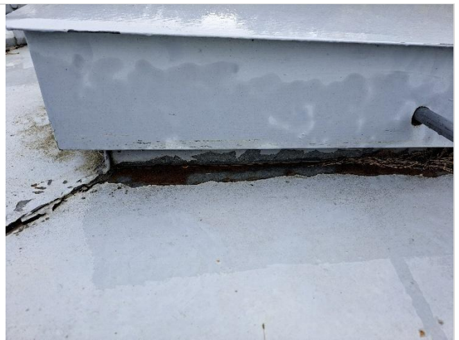
Kuva 87. Kulkuluukun kohdalla maali hilseillyt ja korroosiota.
