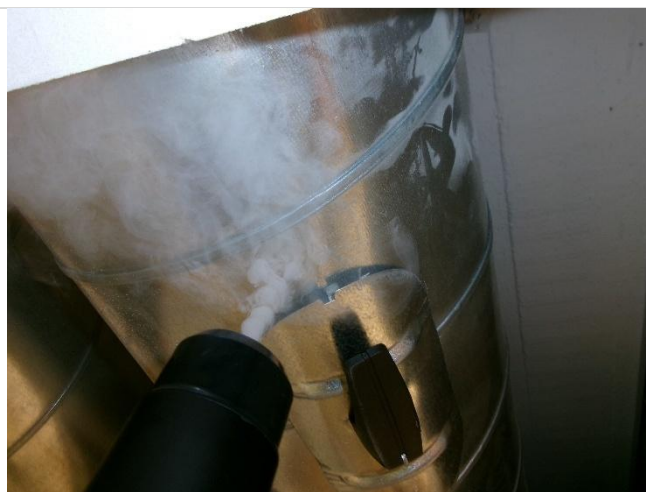
Kuva 109. Terveystieteiden huoneen tuloilmakanavan tarkastusluukku on kyseiselle kanavakoolle liian pieni ja siitä aiheutuu ohivuotoa.
