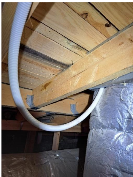
Kuva 77. Alusrakenteissa läpivientien kohdilla vuotojälkiä.
