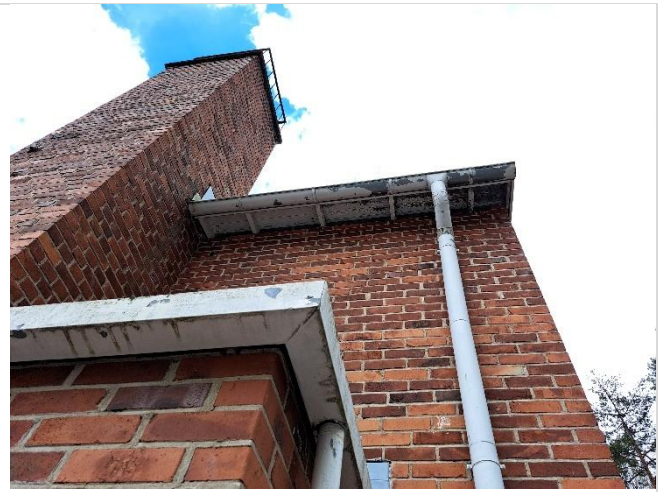
Kuva 81. Sadevesikourujen ja syöksytorvien maalipinta hilseilee.
