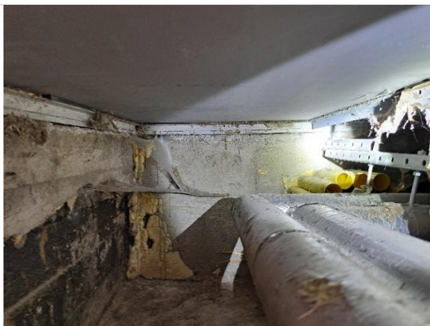
Kuva 28. Kanaalissa vesijohtojen suojauputkia, varaus- ja lämpöputkia, joiden kautta ilma pääsee kulkemaan ympäröiviin tiloihin.
