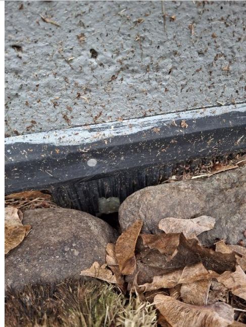
Kuva 10. Tien puoleiselle sivulle on asennettu perusmuurilevytyks, jossa olleesta reiästä voitiin todeta, ettei sen alla ole vedeneristettä tai lämmöneristettä.
