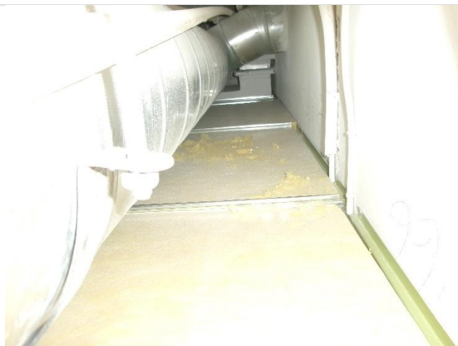
Kuva 61. Terveystieteiden huoneen 010 akustolevyjen päällä havaittiin mineraalivillan paloja.
