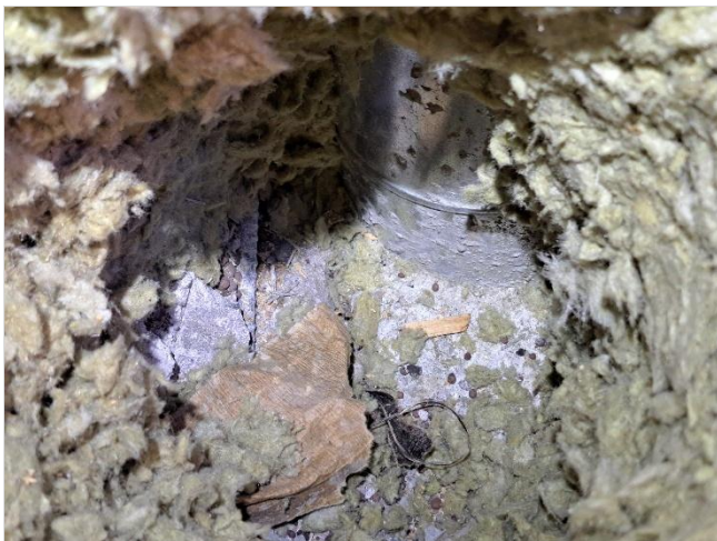
Kuva 73. Ilmanvaihtokanavan ympärille on tehty ns. tukkovalu. Kanavan ympäriltä puuttuu kanavaeriste.
