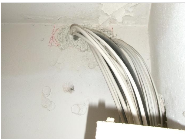
Kuva 56. Rehtorin huoneen 206 ulkoseinän eristetilaan laskettua merkkiainetta havaittiin varaston 203 alakaton päällä olevista läpivienneistä.
