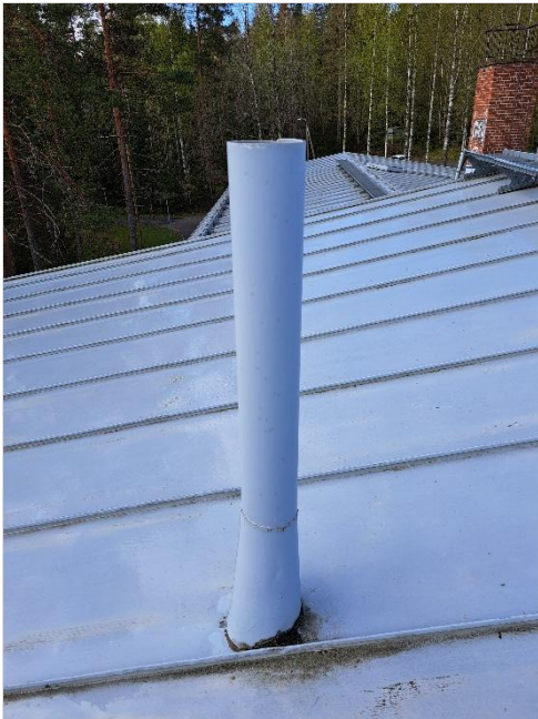
Kuva 84. Viemärin tuuletusputken läpivienti tulisi korjata.
