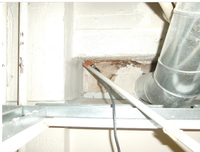
Kuva 32. Käytävän 030 maanvastaisen seinän eristetilaan laskettu merkkiaine kulkeutui aulan 031 alakaton päällä olevien patterin läpivienteihin ja seinässä olevaan syvennykseen.
