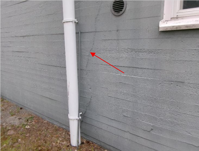
Kuva 50. Sokkelissa havaittiin useita halkeamia. Teknistentilojen kohdalla on pystyhalkeama, jossa havaittiin hieman rakenteen siirtymää.
