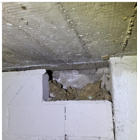
Kuva 43. Vaurio sijaitsee portaiden alla. Seinästä on poistettu tiili, vaurioituneesta lämmöneristeestä on suora sisäilmayhteys.
