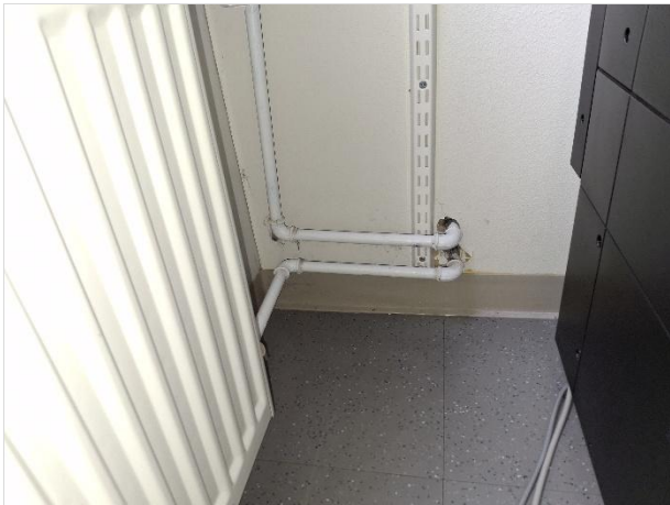
Kuva 68. Merkkiaine kulkeutui tilaan vanhan ja uuden rakenteen liitoksesta.
