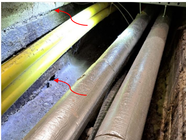
Kuva 27. Käytävällä olevan kanaalin pohjan ja sivun väli auennut. Suora yhteys maaperään.
