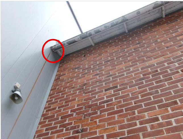
Kuva 48. Sadevesikourun päästä vuotaa vesiä ilmanvaihtokonehuoneen kohdalla. Tiiliverhouksen ulkopinnassa on rapautumaa.
