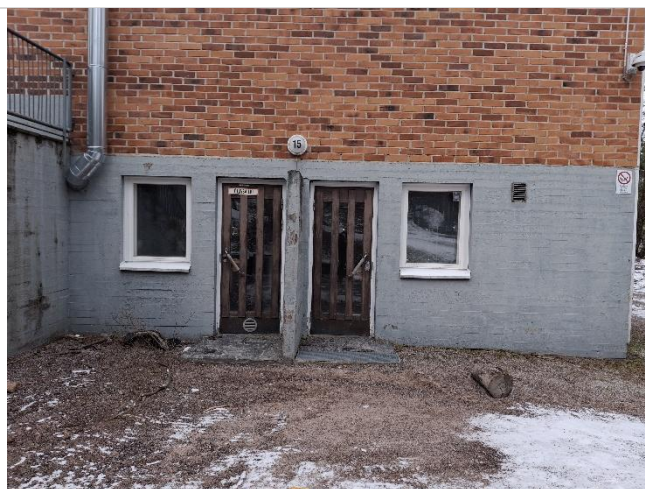
Kuva 55. Teknistentilojen ovet olivat huonossa kunnossa.
