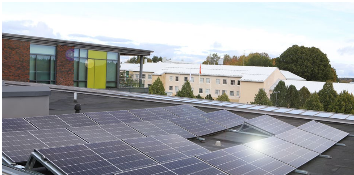
Kuva 2. Aurinkopaneelit Kirkkokadun toimipisteen katolla.
