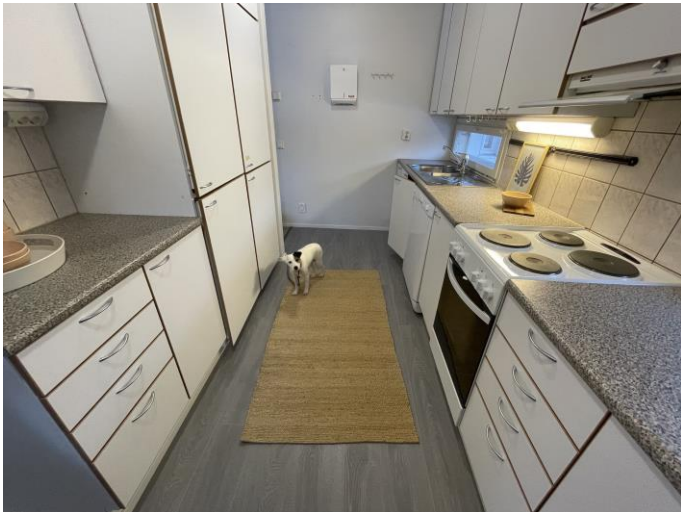
näkymää keittiöstä. Ikkunan puulistoituksissa on kosteusjälkeä, reunoilla silikonitiivisteet puuttuvat osittain.
