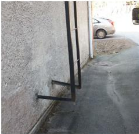
Kuva 1. Sisäänkäynnin puoleisella seinustalla maan pinta viettää rakennukseen päin.
