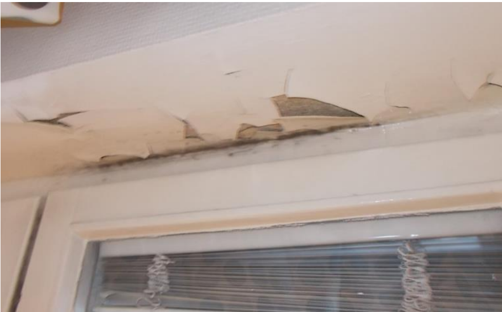
Kuva 4.2. Ikkunoiden pielet ovat kunnostuksen tarpeessa.
