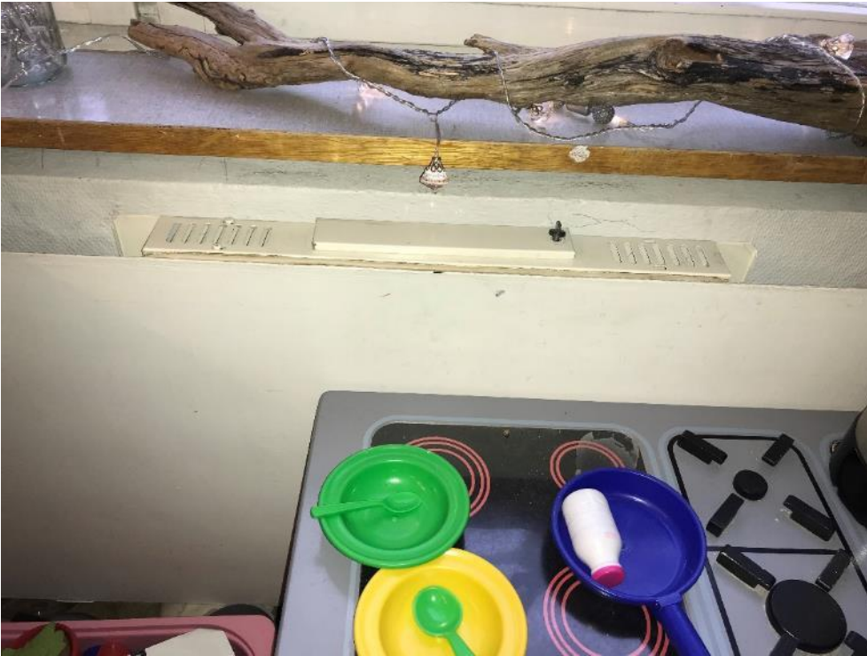
Kuva 5.3. Korvausilmaventtiili lämpöpatterin yhteydessä.
