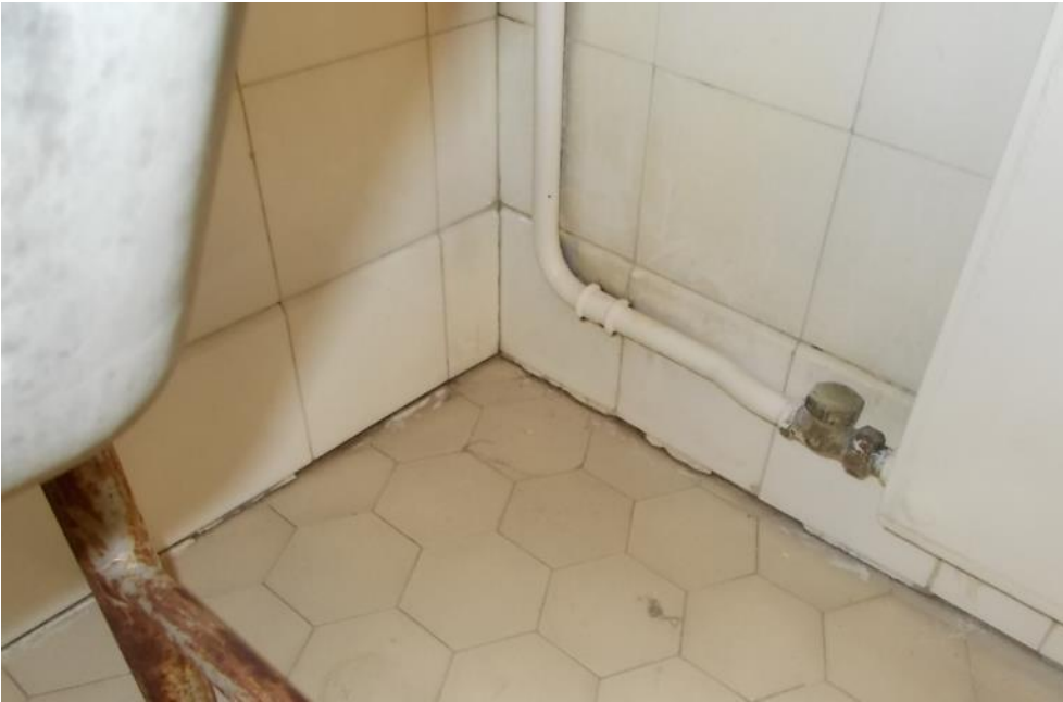
Kuva 4.9. Pesuhuoneessa on huonokuntoisia silikonisaumoja.
