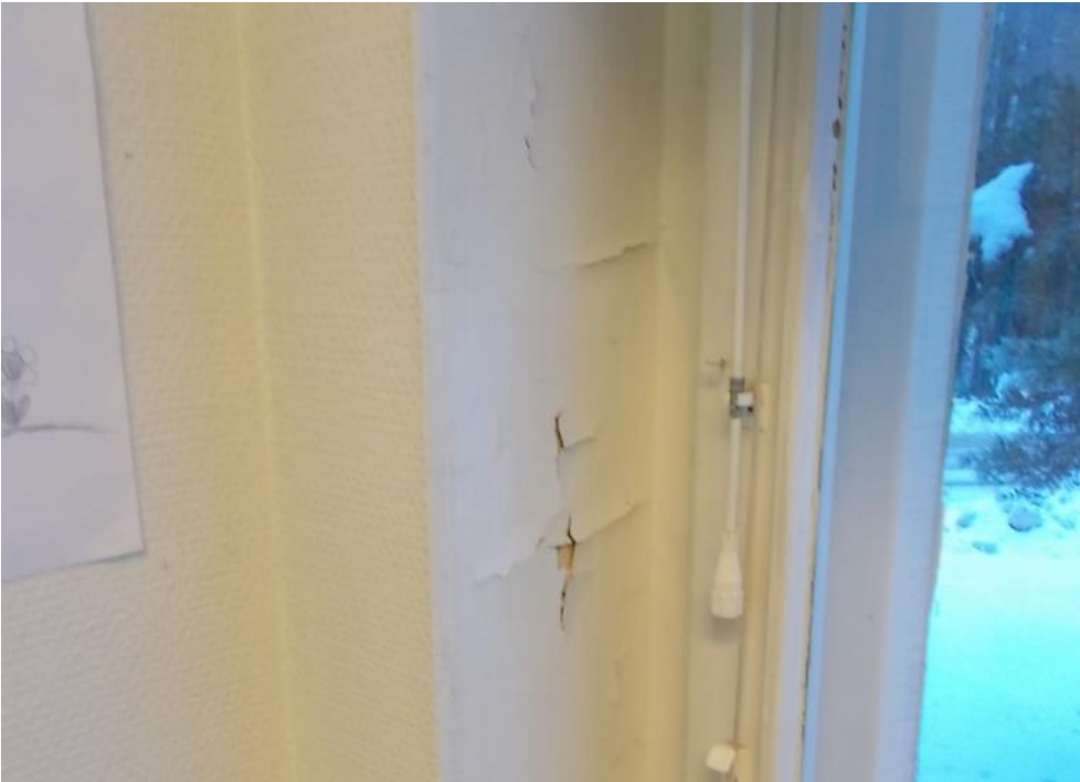
Kuva 4.3. Ikkunoiden pielet ovat kunnostuksen tarpeessa.
