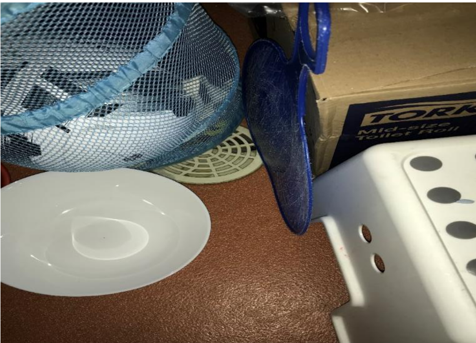
Kuva 5.4. Suihkutilan lattiakaivon päällä on tavaraa, joka vaikeuttaa lattiakaivon täyttöä.
