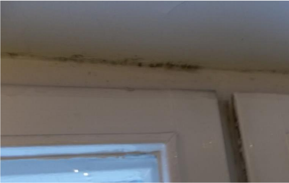
Kuva 4.5. Ikkunoiden liittymistä on ilmavuotoa.
