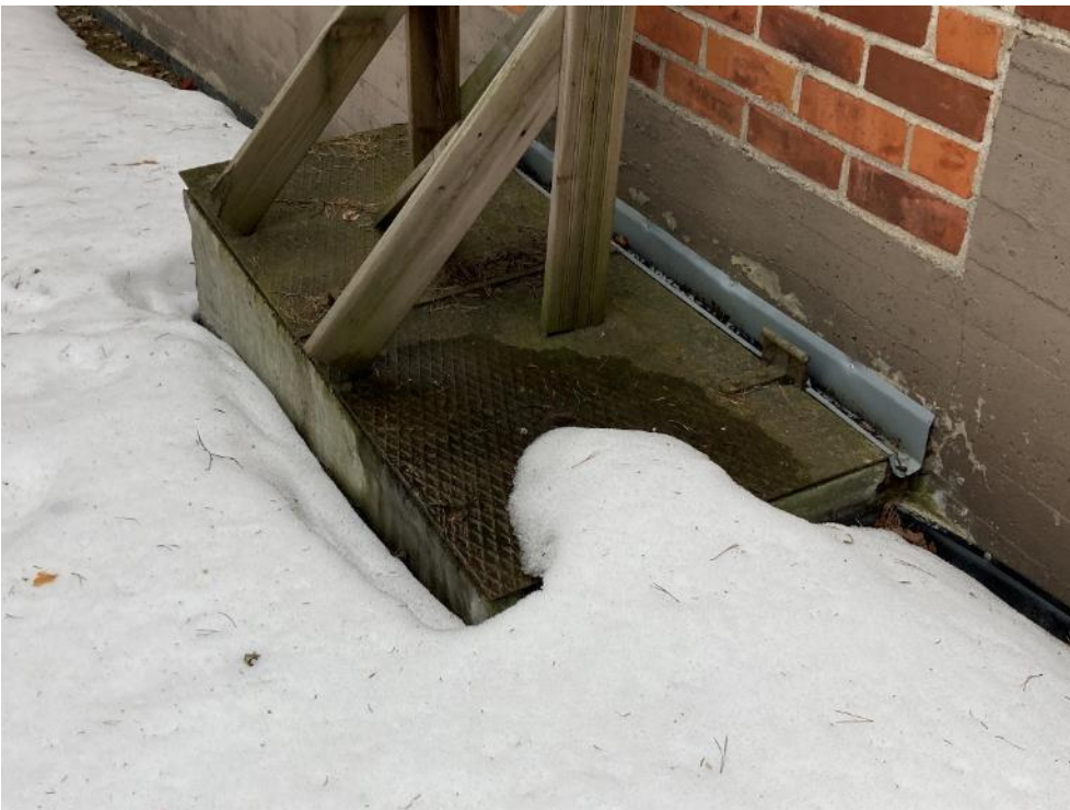
Kuva 4.12. Luukku on tiivistämättä.
