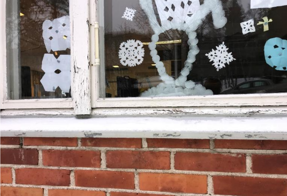
Kuva 4.1. Ikkunat ovat kunnostuksen tarpeessa.
