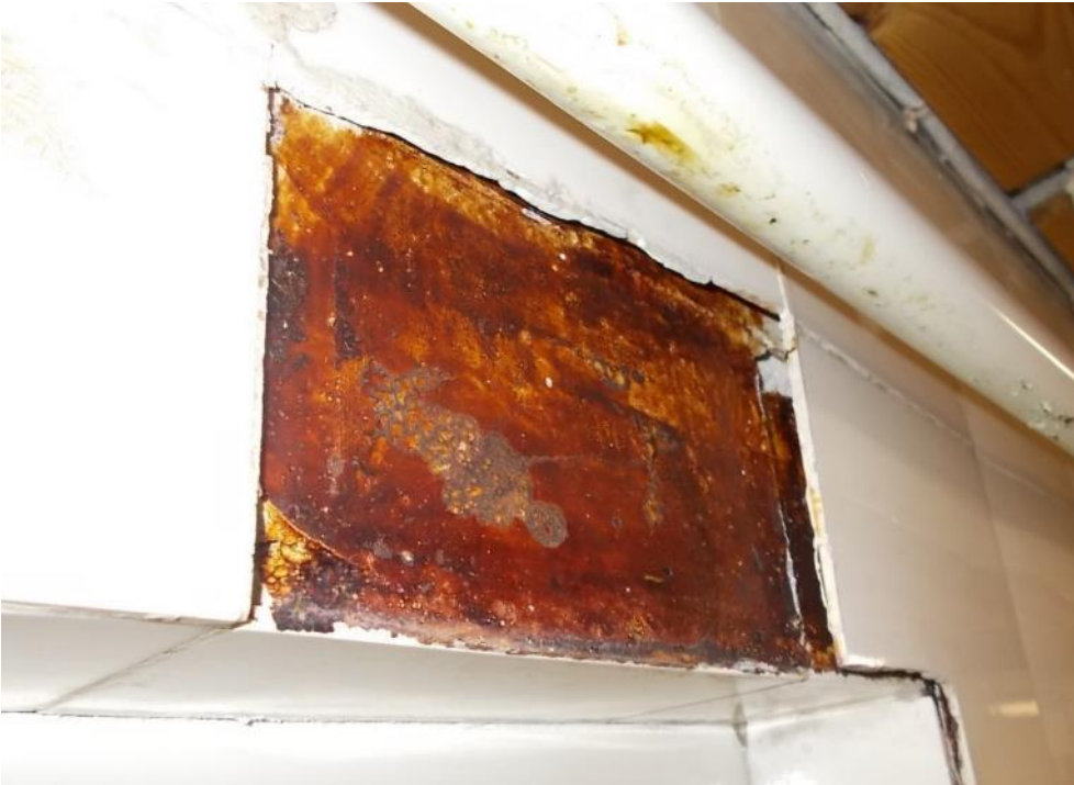
Kuva 4.7. Pesuhuoneen seinistä on irronnut laattoja.
