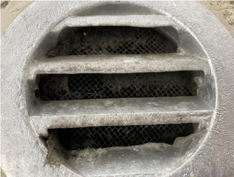
Kuva 5.1. Korvausilman ulkosäleiköt ovat osin tukossa.
