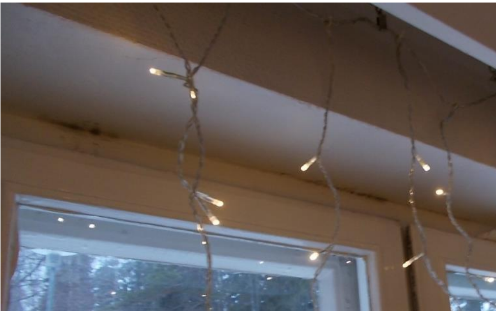
Kuva 4.4. Ikkunoiden liittymistä on ilmavuotoa.
