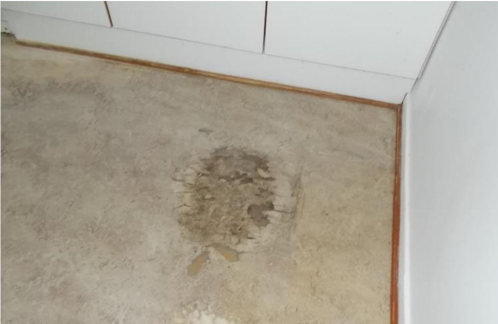
Kuva 4.11. Asunnon numero 6 lattiamatto on huonokuntoinen.
