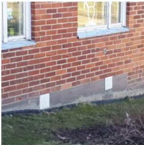
Kuva 2. Päätyseinustalla olevat sokkelin alaosan tuuletusritilät ovat lähellä maanpintaa ja niiden kautta voi päästä vesi rakenteisiin. Sokkelin ulkopuolella patolevy, mutta nurmikko sokkelin vierustalla lisää rakenteisiin kohdistuvaa kosteusrasitusta.
