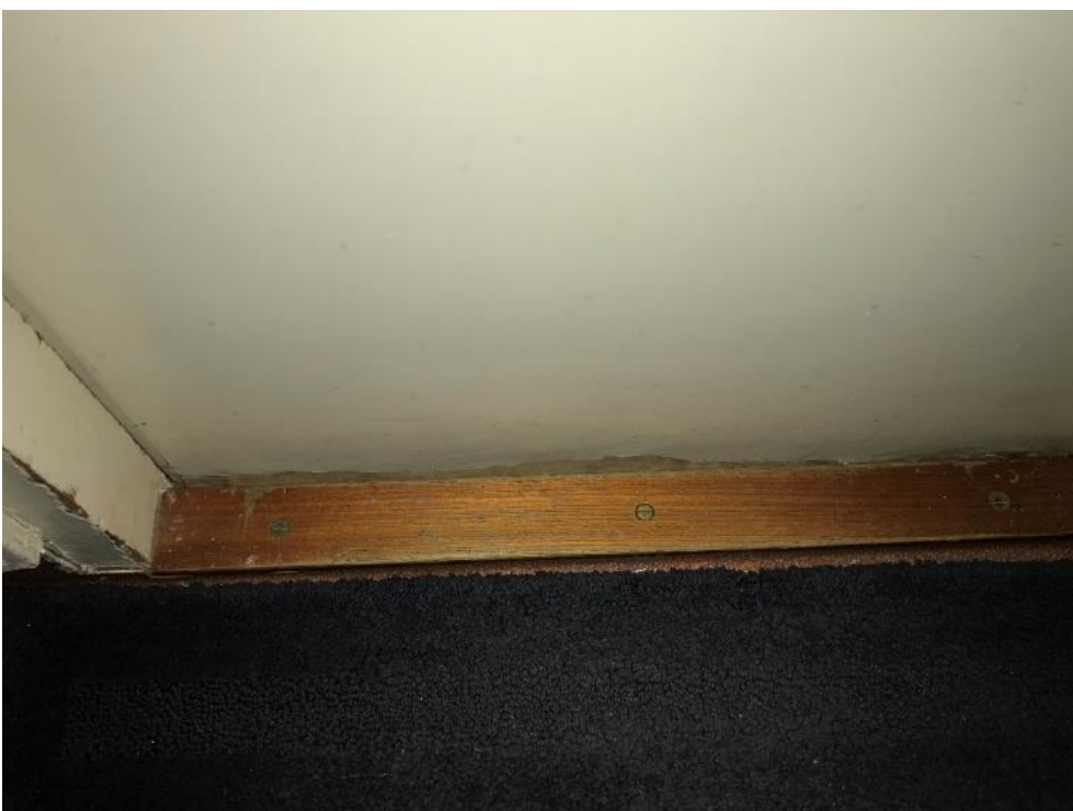
Kuva 5.2. WC tilan ovirako puuttuu.
