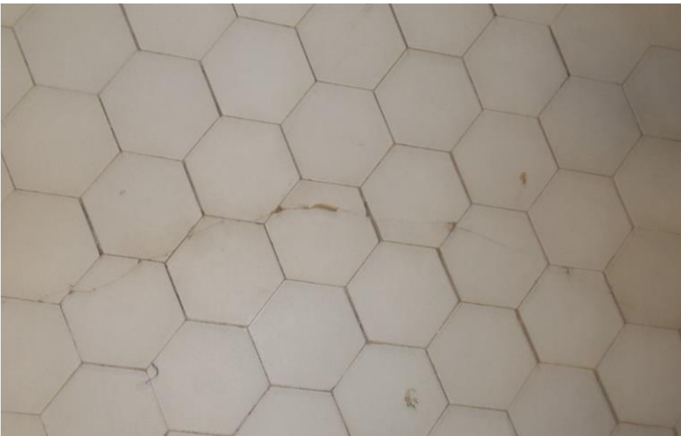
Kuva 4.8. Pesuhuoneen lattiassa on haljonneita laattoja.
