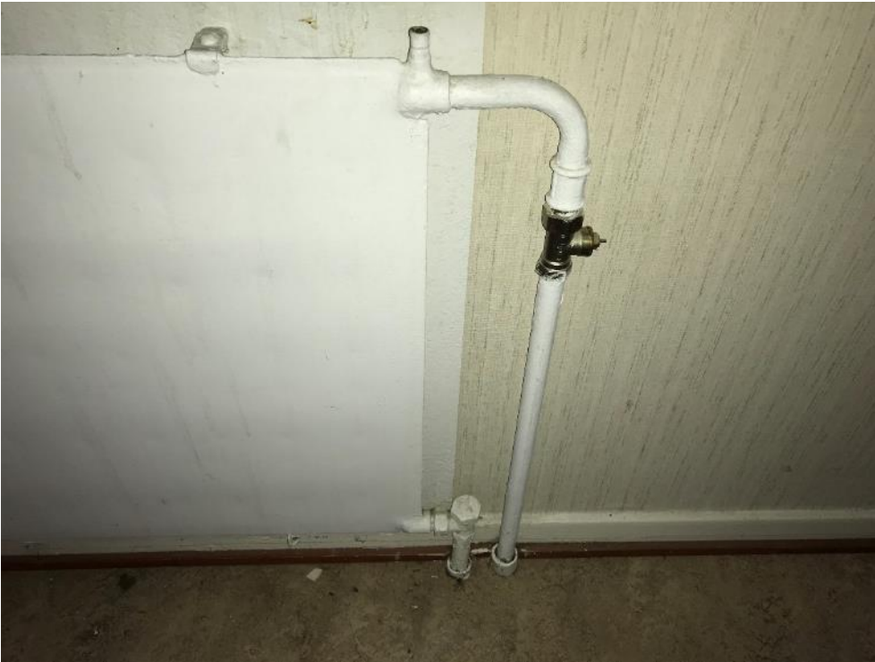
Kuva 5.5. Osasta lämmityspattereita puuttuu termostaattiosa.
