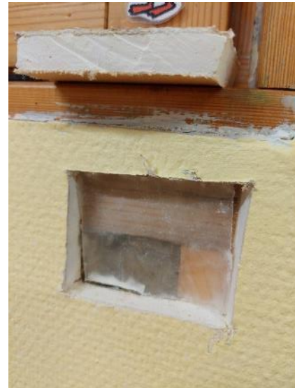
Kuva 65 Sisäpinnassa oli vain kipsilevy ja sen takana läpinäkyvä muovi.
