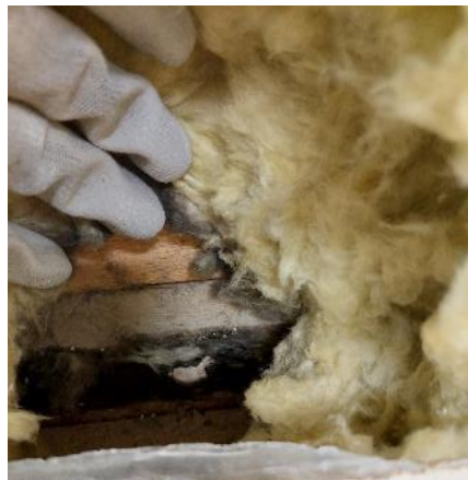
Kuva 53 Sokkelin bitumisively ei ulotu vaakalautoitukseen asti.
