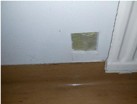
Kuva 56 US14 sosiaalitalan 1.12 alaosaan. Tilassa oli selkeä maakellarimainen haju.
