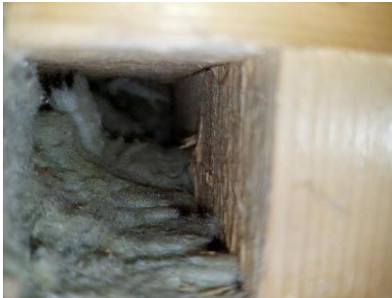
Kuva 62 Eristevillasta otettiin mikrobinäyte, jossa oli epäily vauriosta.
