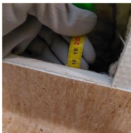
Kuva 55 Alaohjauspuu on 175 mm avauksen alapuolella. Lattian muovimatto on nostettu ulkoseinälle.
