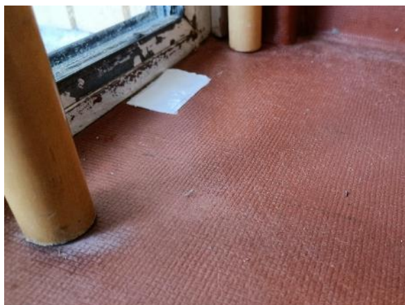
Kuva 87 Näyte 3. Märkäeteisen 1.57 punainen muovimatto. Sisältää raskasmetalleja.
