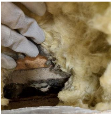
Kuva 85 Näyte 1. Sokkelin sisäpuolinen pikisively. Ei sisällä asbestia eikä PAH-yhdisteitä.
