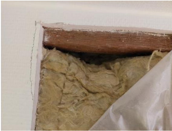
Kuva 34 US2 ylös tilassa 1.72. Villanäyte otettiin ulkoseinän ja yläpohjan liitoskohdasta.
