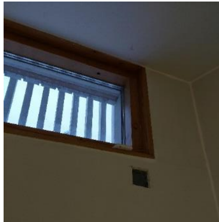
Kuva 35 US3 eteishallin 1.56 yläosaan yläikkunan alle.
