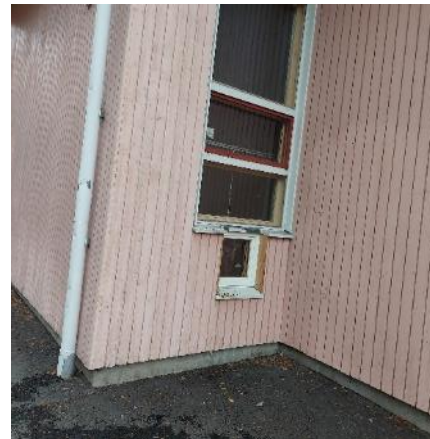
Kuva 12 Rakennuksen 2 kulmia. Sokkeli on liian matala. Sadevesi johdetaan syöksytoria pitkin sadevesijärjestelmään.
