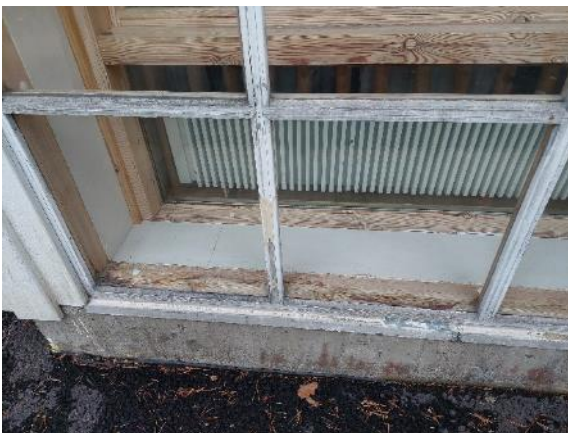
Kuva 19 Kiinteiden ikkunoiden ulkopuoliset ristikot olivat tyydyttävässä kunnossa. Ikkunapelti on liian kapea..
