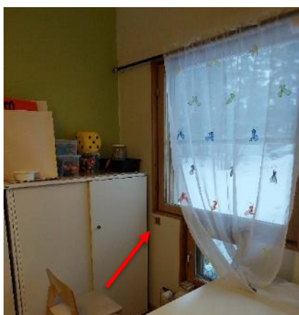
Kuva 60 US16 tilaan 1.26 ikkunan alle.
