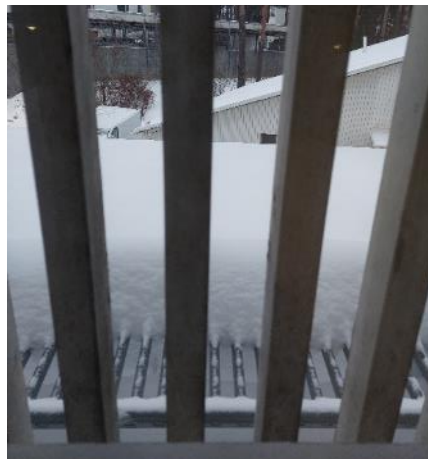
Kuva 37 Yläikkuna on hieman vesikaton yläpuolella.
