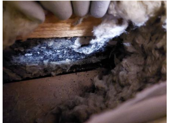
Kuva 47 Vaakariman alapuolella on betoninen sokkeli. Sokkelin sisäpinnassa on bitumisivelyä. Alaohjauspuu on noin 100 mm lattiapinnan alapuolella.
