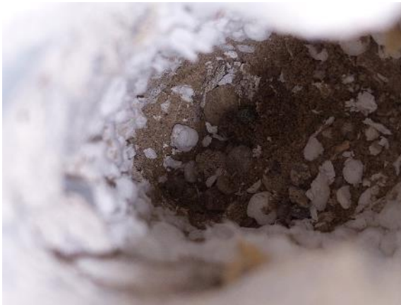
Kuva 28 Betonin ja eps-eristeen alla on hienojakoista maa-ainesta.
