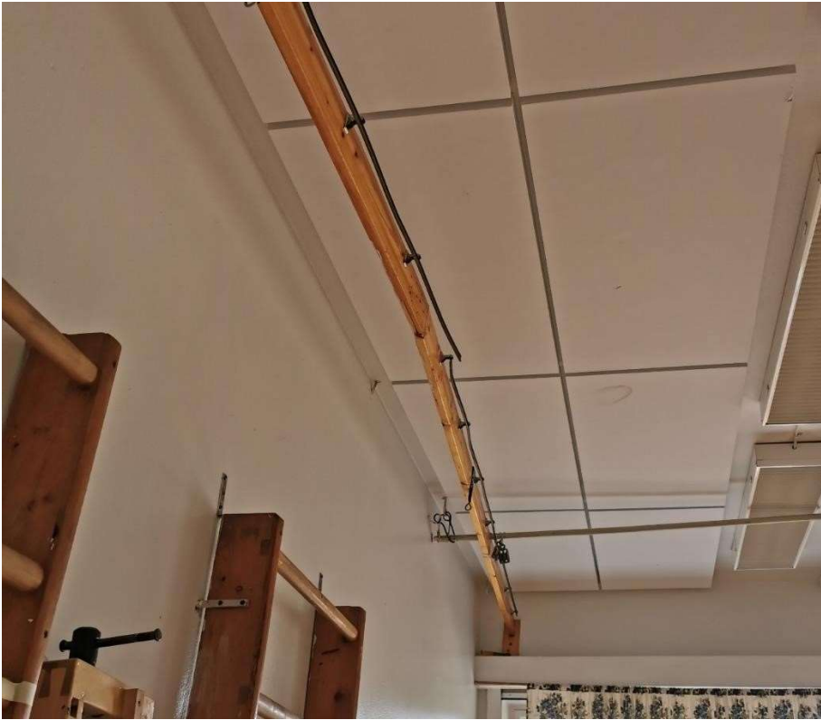
Liikuntasalin katonrajassa oleva lautapalkki on vinossa.
