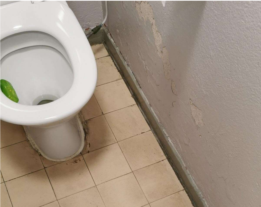
Ulko wc, tyttöjen puoli. Seinässä vauriota.
