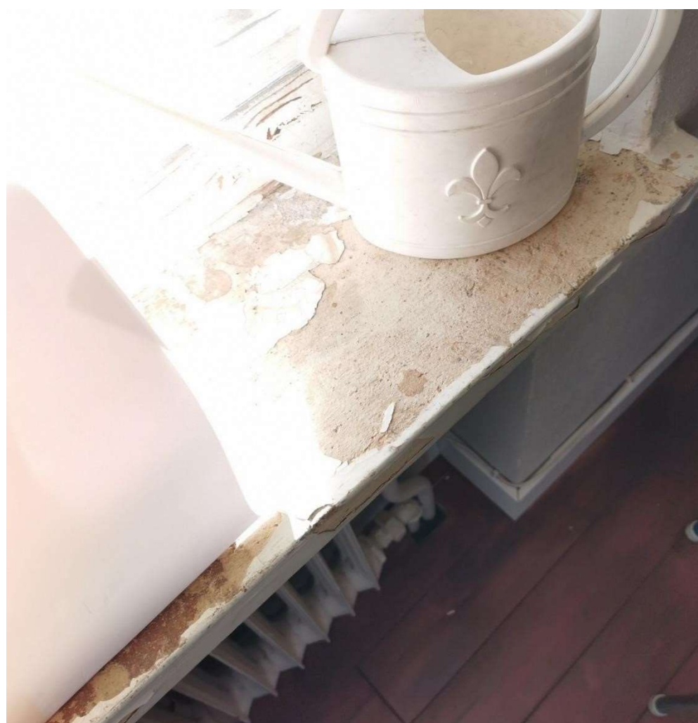
Ikkunoiden karmeissa ja syvennyksissä maalit lohkeilleet.
