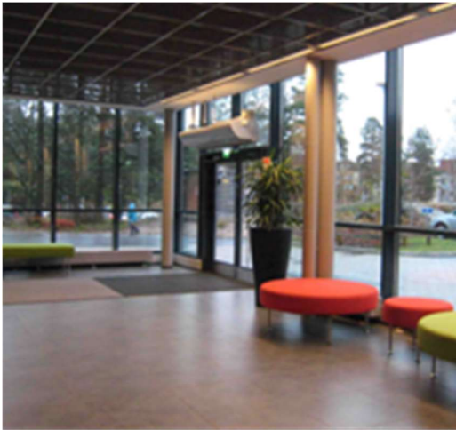
Lasiseinien eteen asennetut suojatangot toimivat sekä huomiomerkkeinä että nojaamistukina.
