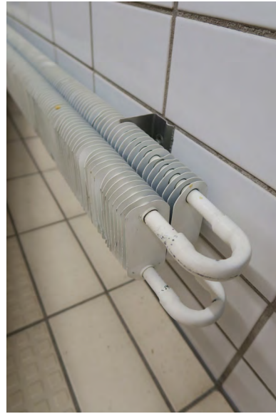
Radiaattori erityisryhmien pesuhuoneessa.
