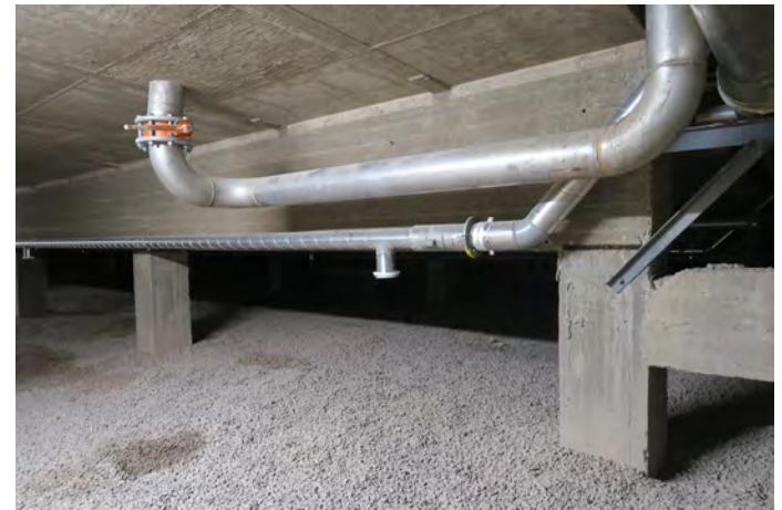
Ison altaan allassuuttimien putkisto. Ilmanvaihtokanava on alapohjan tuuletusta varten.
