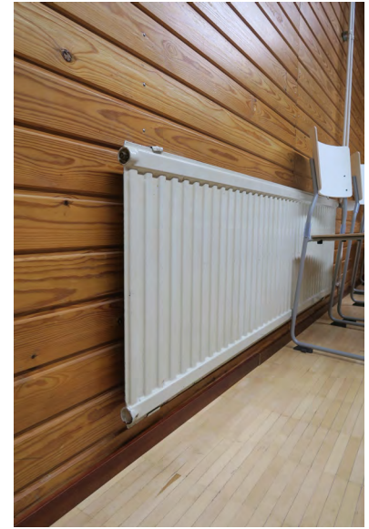
Radiaattori erityisryhmien pukuhuoneessa.
