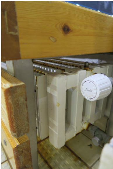
Radiaattori allastasolla, ison altaan ikkunaseinällä
