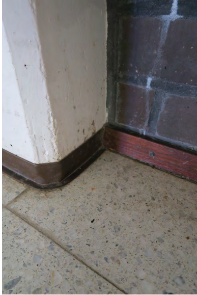
Petsattu puinen jalkalista ja pilaria kiertävä muovinen jalkalista mosaiikkibetonilattian seurana. Alla katsomosta allasosalle laskeutuva porras muovijalkalistoineen.
