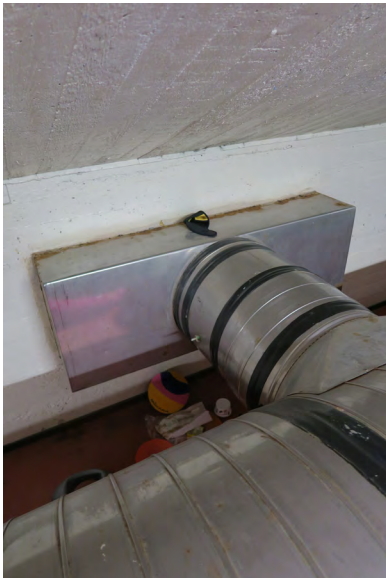
Allashuoneen RST-rakenteisia poistoilmakanavia ja suokappale katsomon alla
