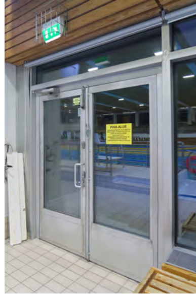
Allashuoneen alumiiniprofiliset ulko-ovet
