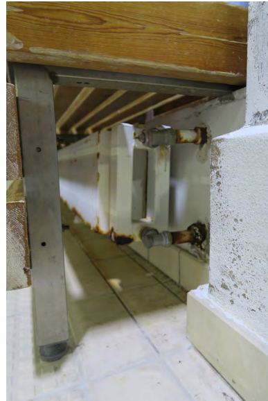
Radiaattori allastasolla,pienen altaan ikkunaseinällä
