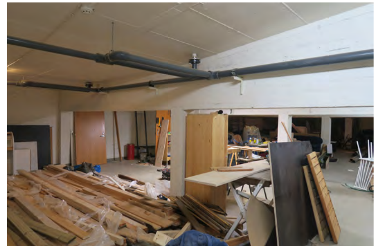
Altaan alla oleva tila on varasto- ja verstaskäytössä. Katossa olevat harmaat putket ovat allasveden syöttöä varten.
