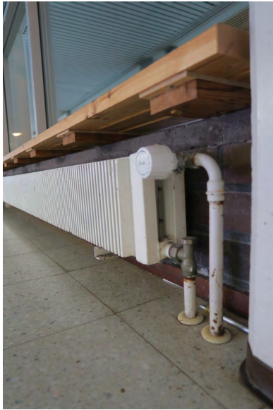
Radiaattori allashuoneen katsomon käytävällä
