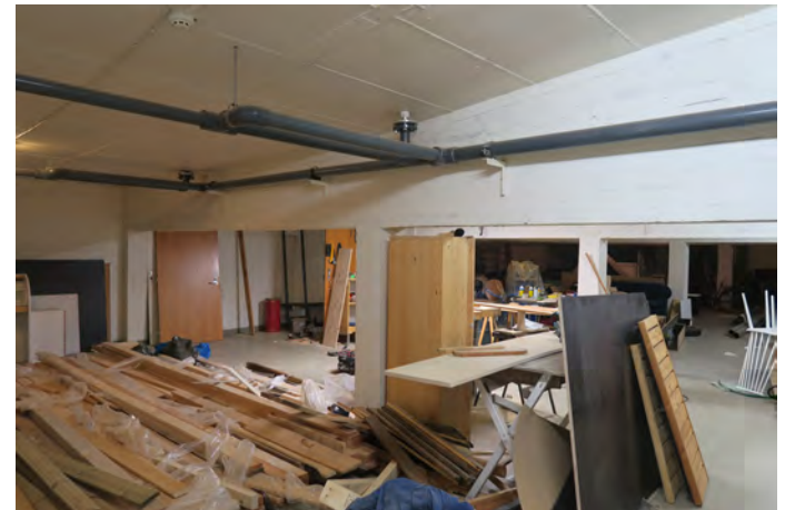
Pienen altaan allassuuttimien putkisto.
