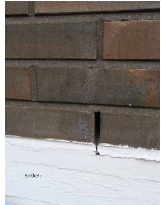
Sokkeli Seinän alaosassa on paikoin tuuletusta varten jätettyjä avosau- moja, vaikka rakenteessa ei rakennettyypin ja rakennetutkimuksen mukaan ole rakenteellista tuuletusväliä.
