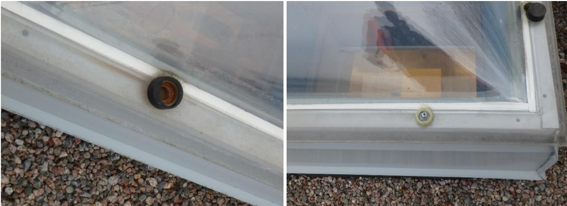
Kuvat 41 ja 42. Kattokupujen kiinnikkeistä puuttuu yksittäisiä suojarahattuja.
