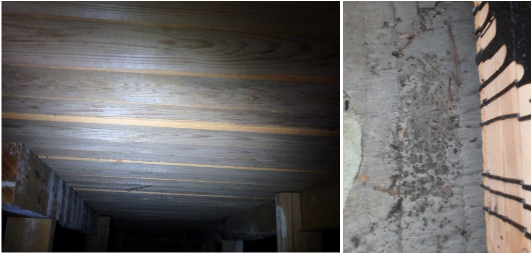
Kuvat 24 ja 25. Aluslaudoitus on osittain uusittu vesikatteen uusimisen yhteydessä. Yläpohjan eristeiden päällä on paikoin näkyvää mikrobikasvustoa.
