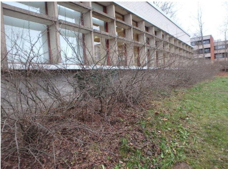
Kuva 5. Eteläisivulla on istutettuja pensaita. Yksi pensas on kiinni sokkelissa, mikä lisää kosteusrasitusta.
