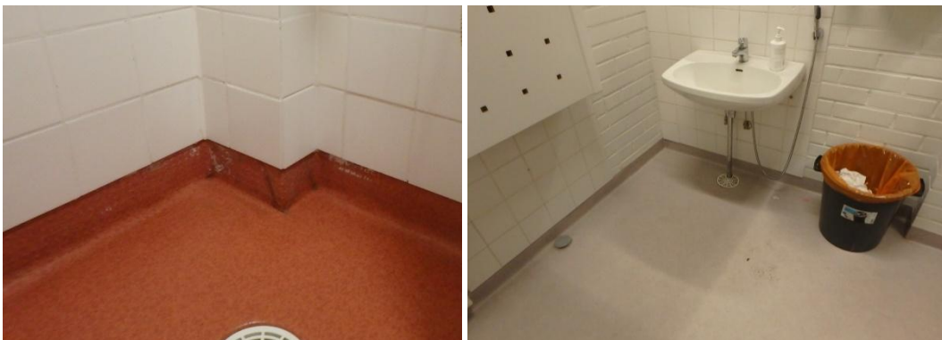
Kuvat 51 ja 52. Suihkuseinässä valumajälkiä. Asiakas WC on juuri uusittu.
