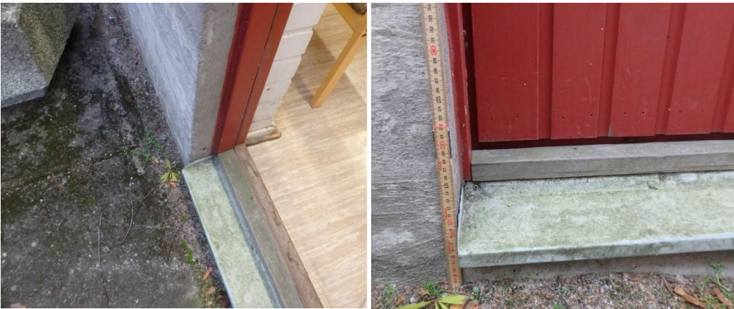
Kuvat 43 ja 44. Lukusalin ulko-ovesta on tullut lunta/vettä sisään. Kynnyksessä on jälkiä vesivuodosta
