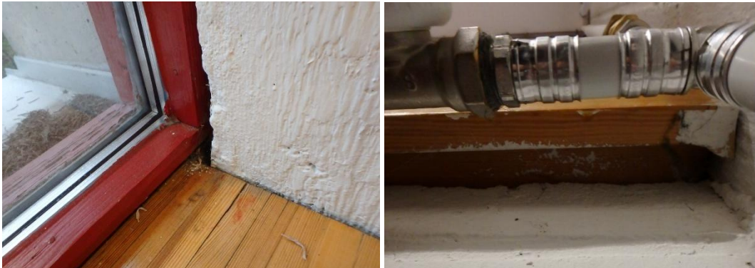
Kuvat 31 ja 32. Ikkunan ja ulkoseinän ja ikkunan liittymät ovat tiivistämättä. Ulkoseinän ja ikkunapenkin välinen sauma on avoin.
