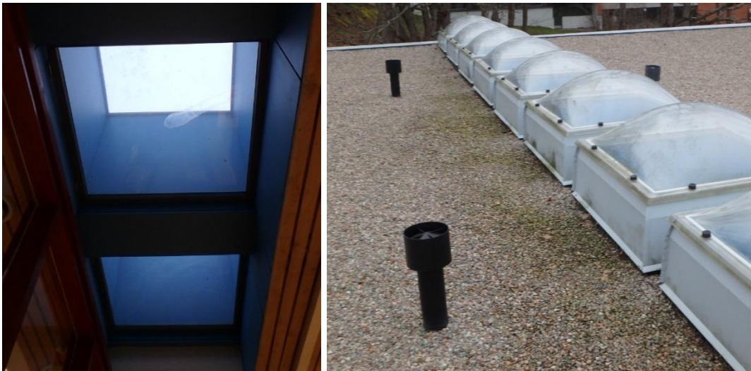
Kuvat 39 ja 40. Kattokupujen sisälasissa on näkyvissä jälkiä vanhoista vesivuodoista. Kattokupujen läheisyydessä on alue, johon vesi lammikoituu.
