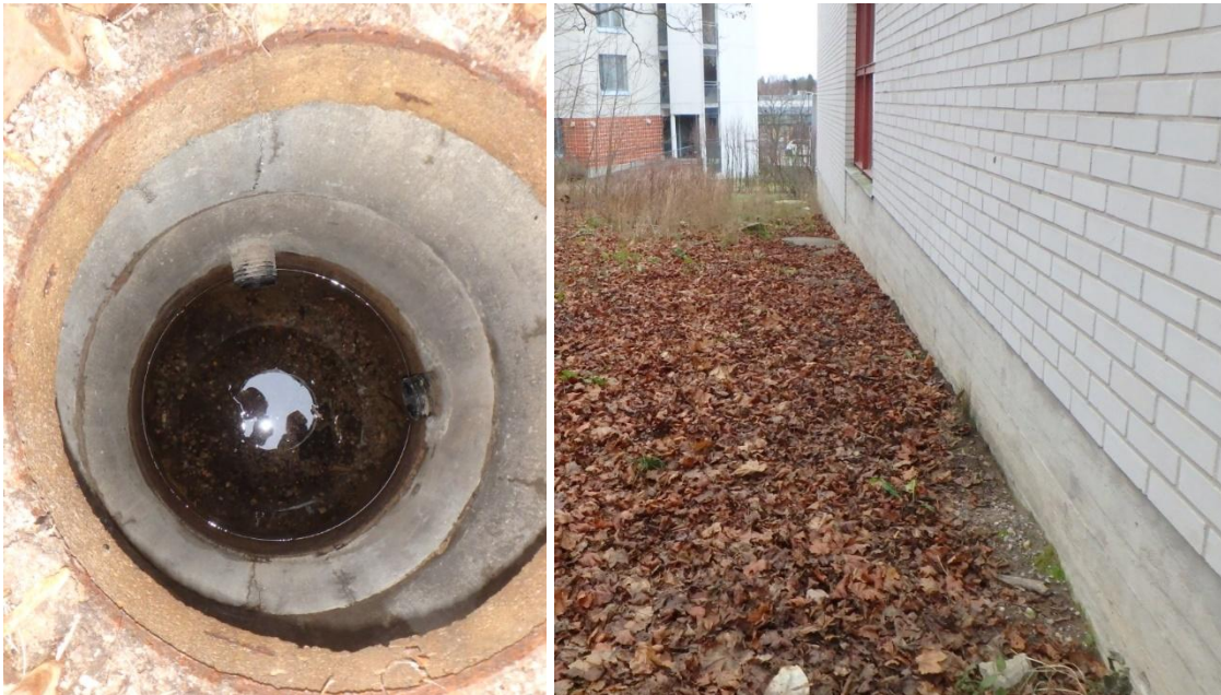
Kuvat 1 ja 2. Vas. avattu salo-ojakaivo, kaivossa uusitut muoviputket. Oik. valtaosassa kaivoja oli betonikannet ja niitä ei pystytty tarkastamaan katsastuksen yhteydessä.
