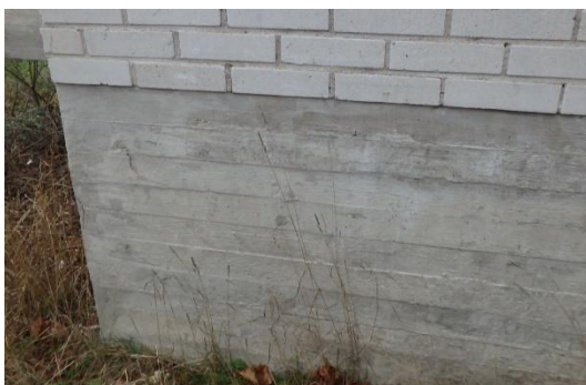
Kuva 8. Sokkelien pinnoite väriykseltään hieman kirjava. Sokkelin alareunassa ei havaittu vesieristystä tai patolevyjä. Sokkeleissa on näkyviä merkkejä alkavasta teräskorroosiosta.
