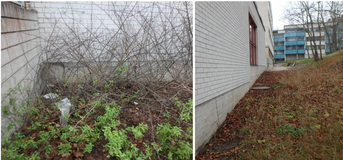
Kuvat 6 ja 7. Sokkelin vierustassa on painuma sisäänkäynnin tukimuurin vieressä. Itäsivu viettää loivasti kohti rakennusta.
