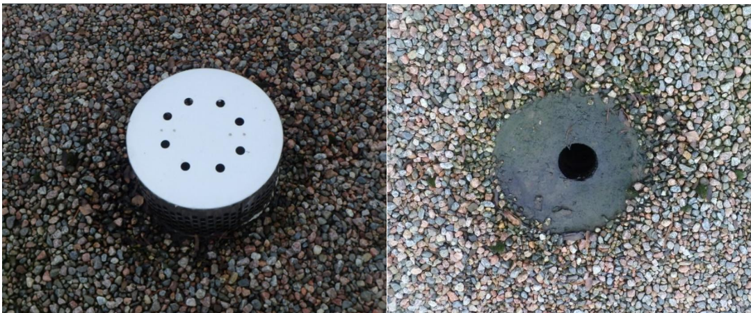
Kuvat 47 ja 48. Kattokaivoista puuttuu toinen sihti.
