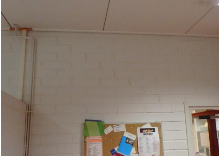
Kuva 17. Yksittäinen halkeama muuratussa ei kantavassa väliseinässä.
