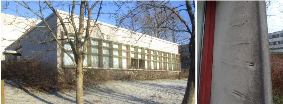
Kuvat 26 ja 27. Julkisivut ovat puhtaaksi muurattuja. Salin ikkunoiden edessä olevien betonikoristeiden/aurinkolippojen pinnassa on näkyviä merkkejä käynnissä olevasta teräskorroosiosta. Aluslaudoitus
