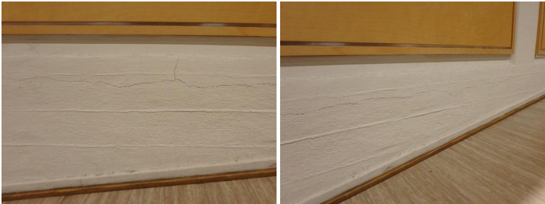
Kuvat 9 ja 10. Rampin / alapohjan tasoeron kohdalla on halkeamia, joiden kautta on todennäköisesti ilmayhteys maaperään tai alapohjan eristekerrokseen.
