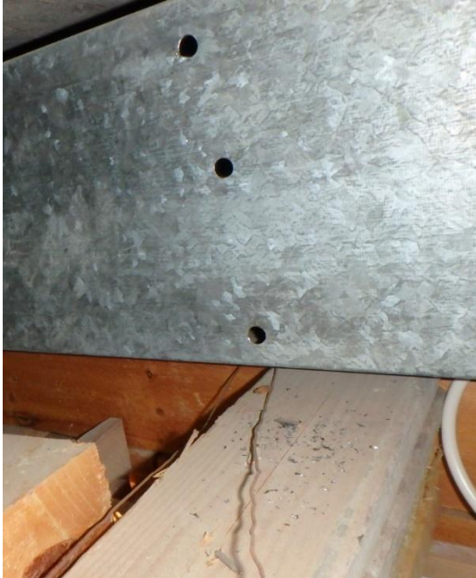
Kuva 61. Tulppaamattomia mittausreikiä ilmanvaihtokanavassa.
