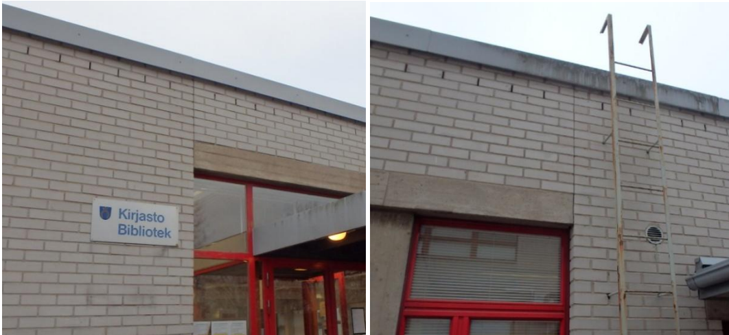
Kuvat 28 ja 29. Julkisivumuurauksessa on avoimia liikuntasauvoja.
