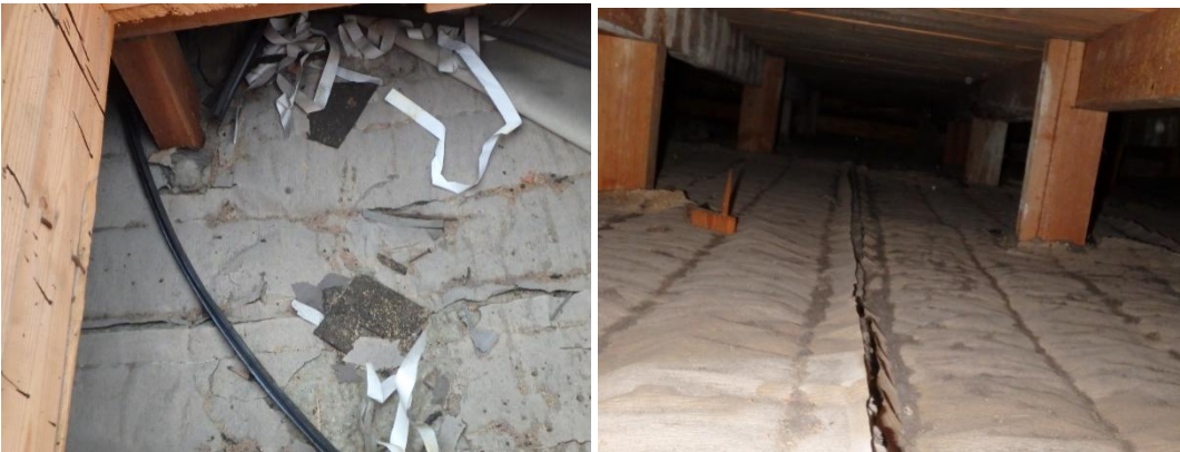
Kuvat 22 ja 23. Yläpohjatilaan on piilotettu rakennusjätettä. Tilaan on kerääntynyt epäpuhtauksia.
