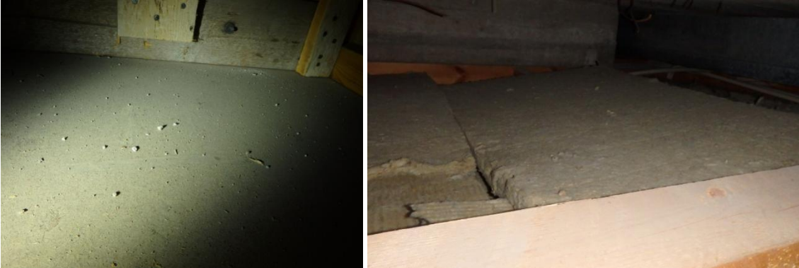
Kuvat 18 ja 19. Alakaton päällä on kerääntynyt vähän pölyä yms. epäpuhtauksia. Laudoitetun alakaton päällä on avointa mineraalivillaa.
