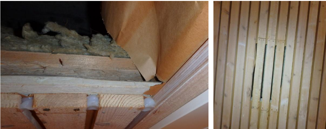
Kuvat 20 ja 21. Alakaton päälle on ilmayhteys huoltoluukkujen kautta. Osa luukuista on tiivistetty silikonilla, osa luukuista on avoimia suoraan alakaton yläpuoleiseen tilaan.
