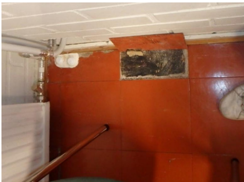
Kuva 16. Henkilökunnan lepohuoneen ja varaston lattian vinyylilaatat ovat heikosti kiinni. Laattojen alla on musta liima.
