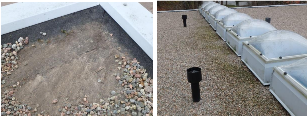
Kuvat 45 ja 46. Vesikatolle singelin joukkoon on kerääntynyt jonkin verran hienoainesta. Katto lammikoi kattokupujen ympärillä. Singelissä on samalla ja leväkasvustoa.
